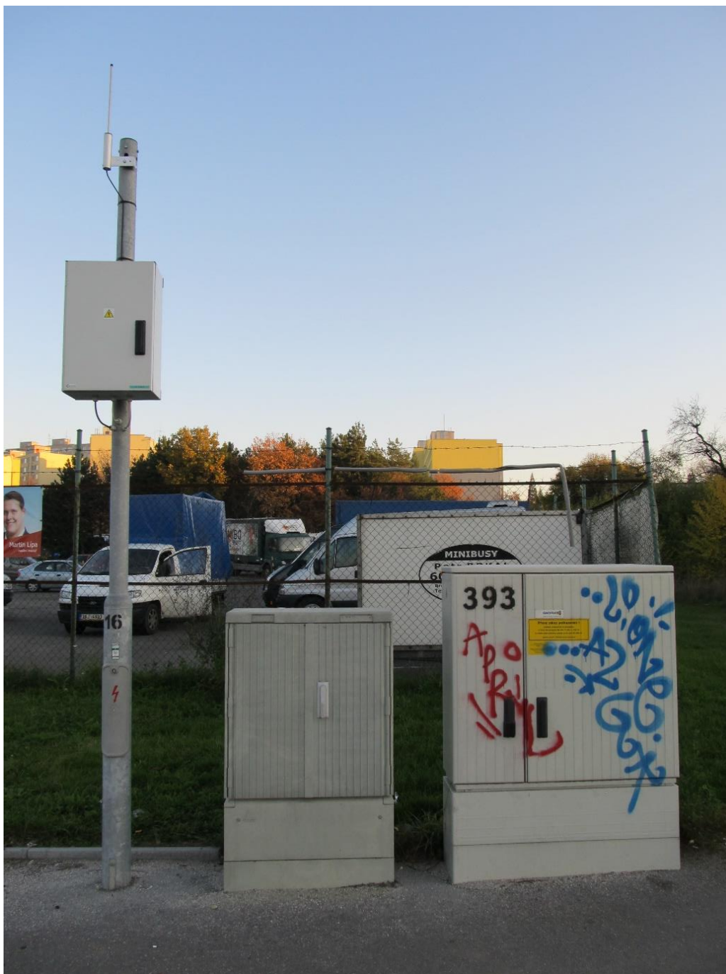
Obrázek 15 Anténa, komunikační jednotka a řadič SSZ na křižovatce Mírového hnutí – Ke Stáčírně – K Horkám, zdroj: autor
