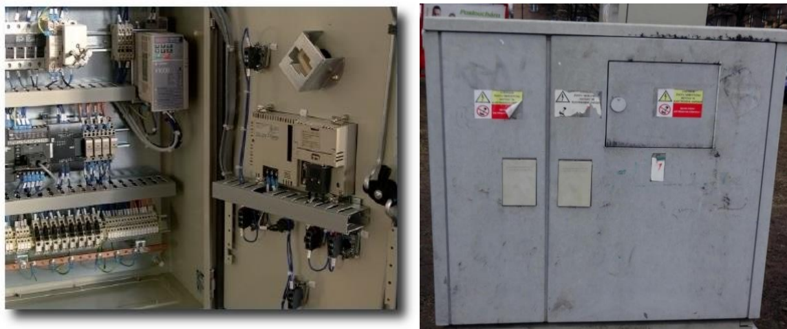
Obrázek 14: Řadič pro řízení světelné signalizace na křižovatce
