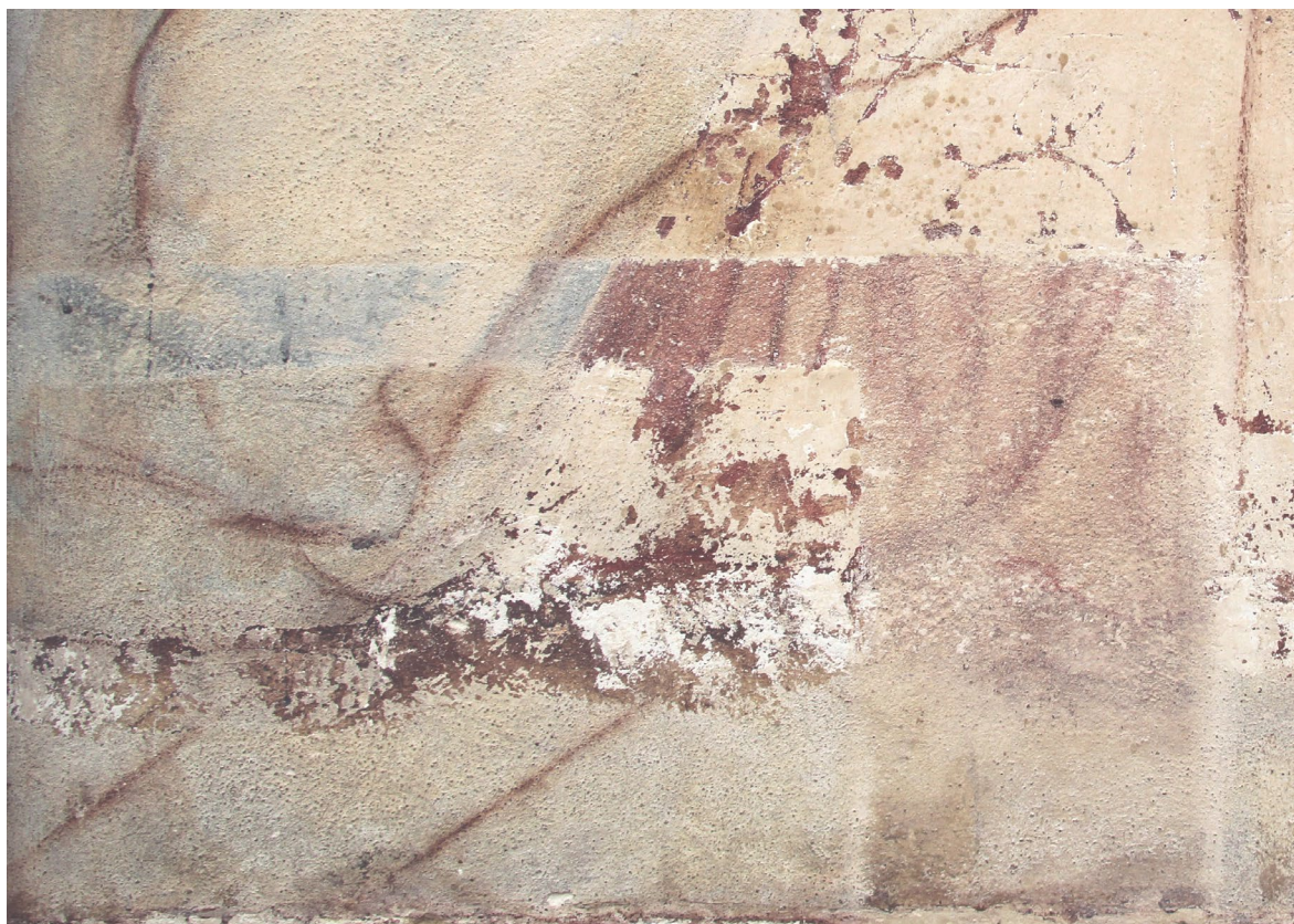
Obr. 93: Detail na sondu 1JV 84 a poškodenie straty farebnej vrstvy v ľavej dolnej časti výjavu č. 1. Stav pred reštaurovaním v dennom rozptýlenom svetle.
