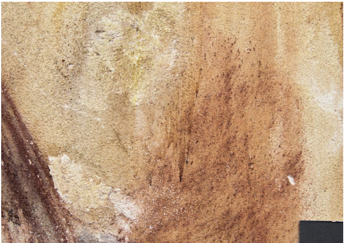
Obr. 54: Detail výjavu č. 1. Stav pred reštaurovaním v dennom rozptýlenom svetle. Detail na autor-ské tmely ľavej časti výjavu.
