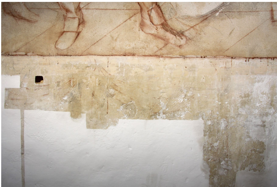
Obr. 68: Detail na soklový úsek pod výjavom č. 4. Stratigrafická rozšírená sonda z roku 2013. Stav pred reštaurovaním v umelom osvetlení. Na snímku je vidieť červenohnedú fragmentálnu kresbu drapérie.
