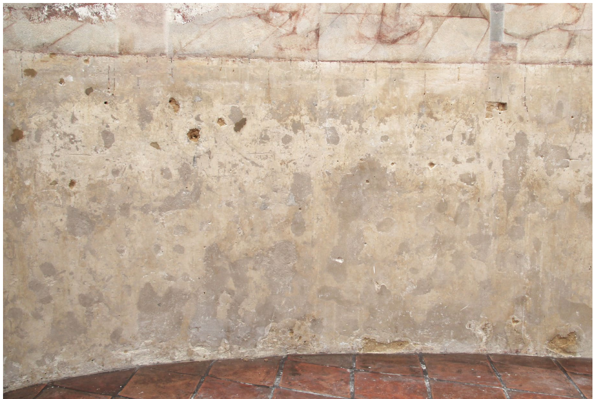
Obr. 78: Ľavá časť soklu pod výjavom č. 1 po čistení v dennom rozptýlenom svetle. Na fotografii je vidieť rozsah druhotných vysprávok a hĺbkové defekty po odstránení sadrových/cementových tmelech. Tiež škrabance, vrypy a stekance pod výjavom.
