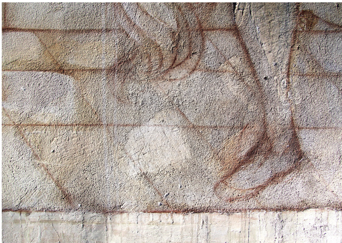
Obr. 59: Spodná časť výjavu č.1. Stav pred reštaurovaním v razantnom bočnom osvetlení. Detail na autorké tmely. V svetle sa zvýraznila hrubá štruktúra omietky v kontraste s hladkou omietkou soklu v spodnej časti fotografie.
