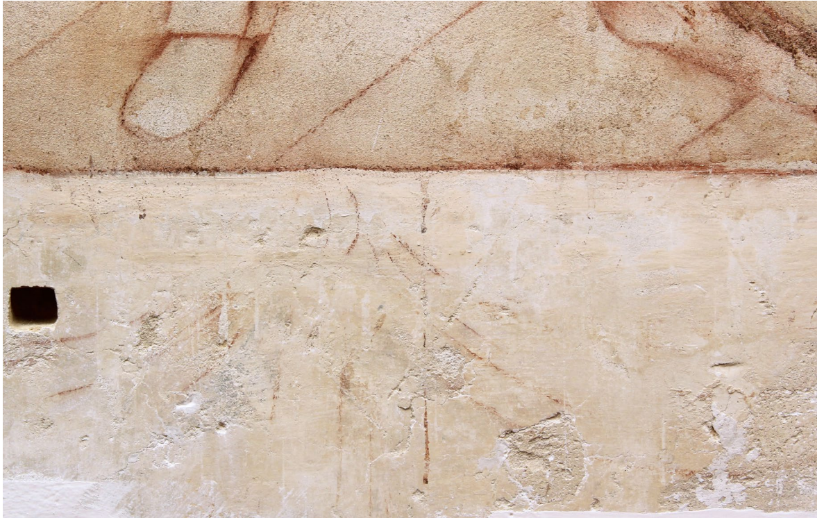
Obr. 73: Detail na fragmentálnu kresbu drapérie v ľavej soklovej časti výjavu č. 4. Stav pred reštaurovaním v dennom rozptýlenom svetle. Sonda z roku 2013. Je vidieť ako linky kresby prechádzajú cez okrový náter, tmely hrubšej povrchovej úpravy a cez historický (barokový) štuk.
