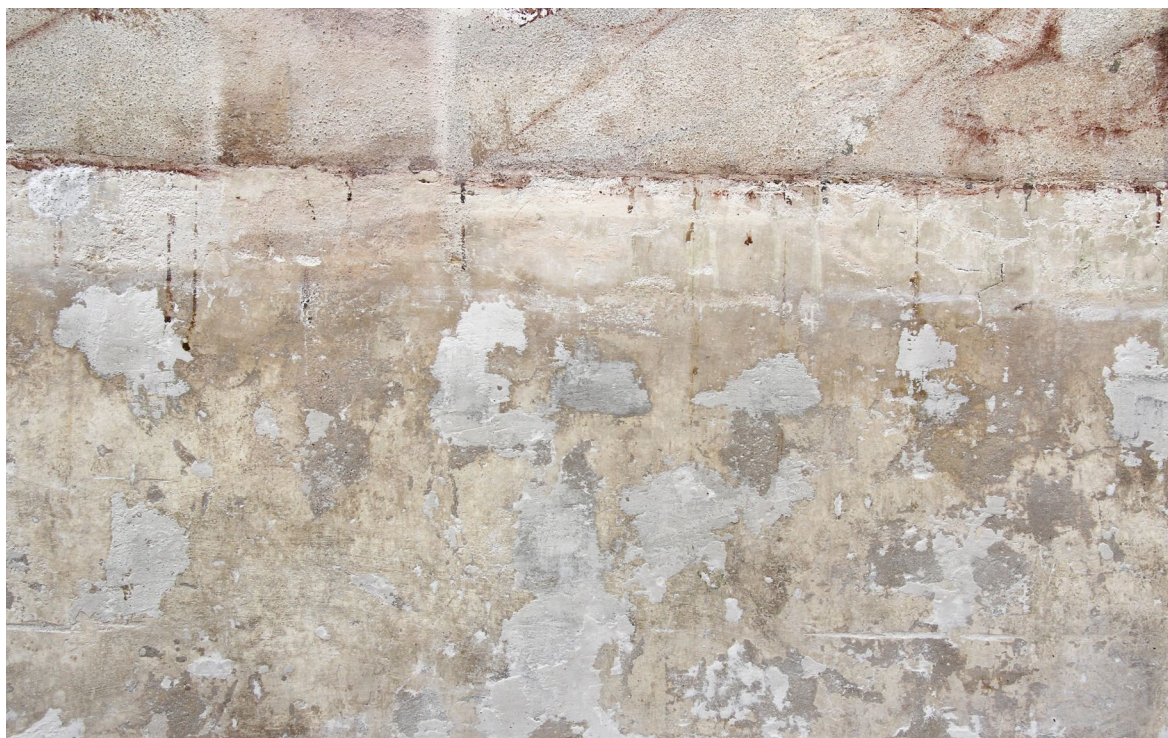
Obr. 75: Detail na soklovú časť pod výjavom č. 1 po odstránení hlinkového bieleho náteru, v dennom rozptýlenom svetle. Povrch historického štku bol tmelený niekoľkými druhmi rôznych maltovín s rôznou povrchovou úpravou. Povrch väčšiny tmelov bol prekrytý tenkou vrstvou sadry. Tiež je možné vidieť nerovnomerné sfarbenie his. štku v tomto mieste.
