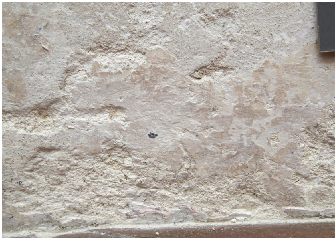
Obr. 79: Detail na časť soklu pri podlahe, po odstránení nevhodného tmelu v dennom rozptýlenom svetle.
