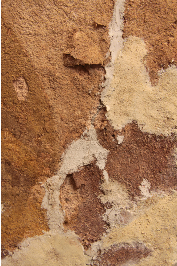
Obr. 51 Detail poškození barevné vrstvy a 2 typů tmelení, jimiž se malba zajišťovala v letech 2005–2006. Okraje intonaca se u trhlin dále oddělovaly od podkladu a vznikaly puchýře nebo se svitkovitě stáčely. Stav před restaurováním
