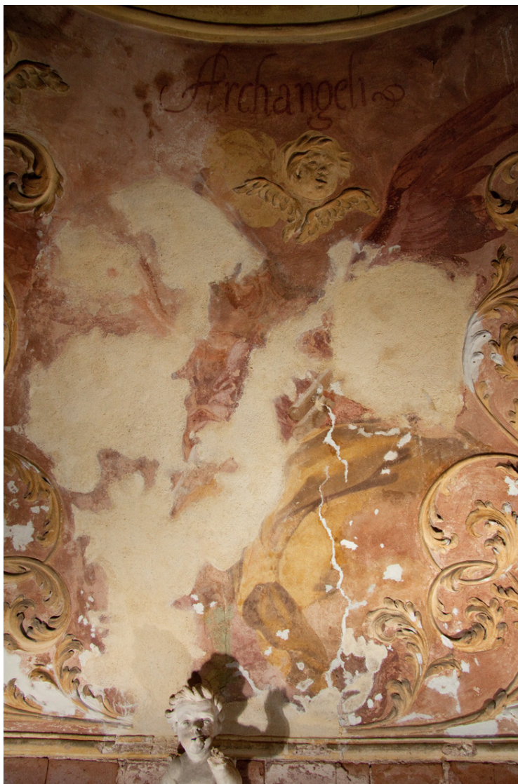
Obr. 93 Celkový pohled na výjev „Archangeli“, stav malby před restaurováním.
