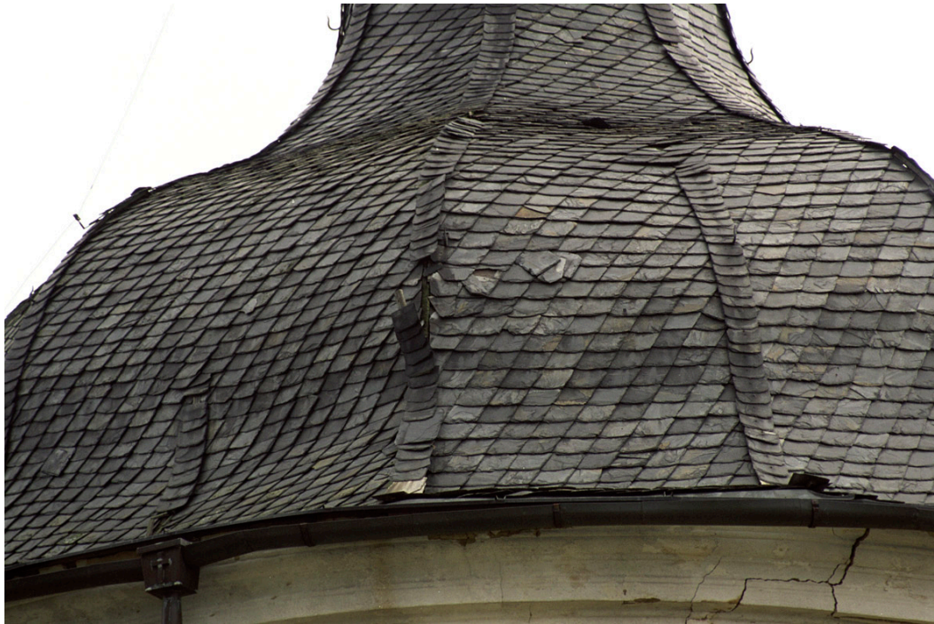
Obr. 36 Stav střechy v roce 2003, kdy byla střešní krytina uvolněná a otevřenými místy zatékala do kaple dešťová voda. Autor: J. Švadlenka.
