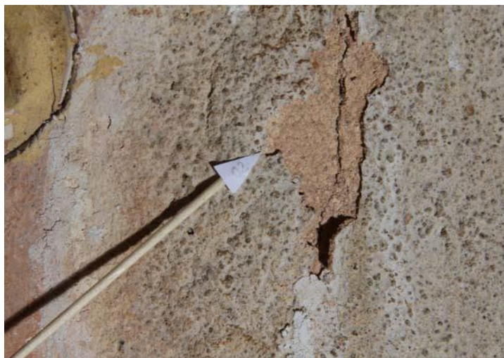
Obr. 126 Defekt v levé dolní části výjevu Cherubim, vzorek O2 (7341), detail.
