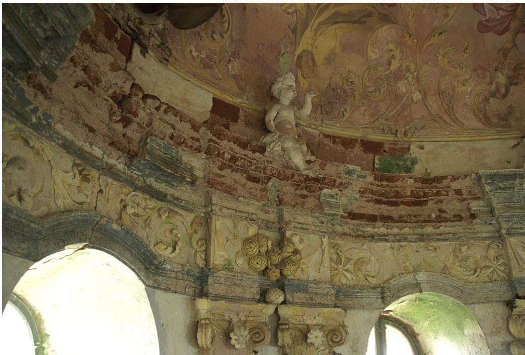
Obr. 37 Zatékání dešťové vody a další doprovodné faktory způsobily velké poškození a ztráty omítek v severozápadní části kaple. Na snímku je vidět stav korunní římsy a pásu s oblaky nad ní, kde zůstaly jen fragmenty výzdoby. Autor fotografie: J. Švadlenka, 2003
