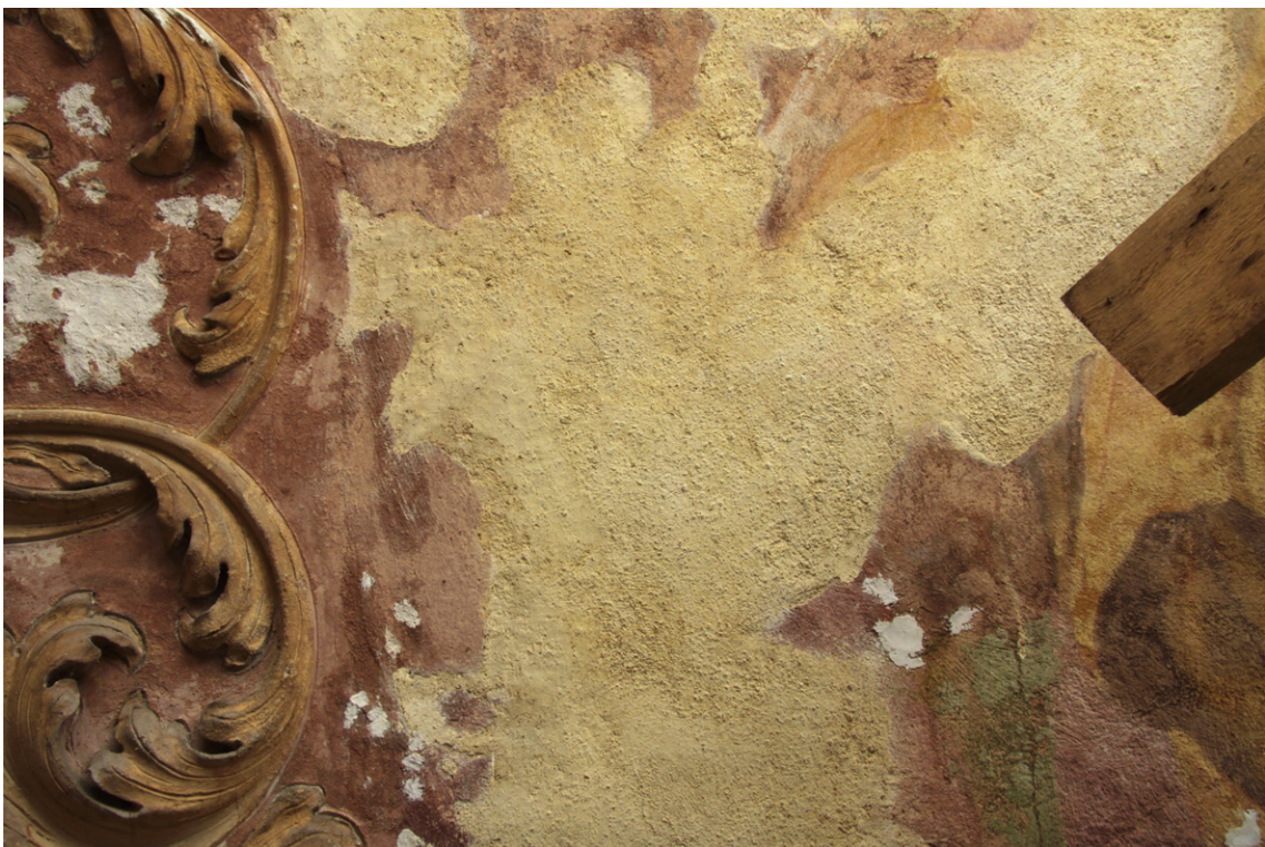
Obr. 64 Část výjevu v oblasti pravé nohy a ruky Archanděla, na němž byly rozsáhlé defekty vytmeleny hrubým tmelem při zajišťovacím zásahu v letech 2005-2006. Při sondážním průzkumu bylo zjištěno, že jsou tmely na většině míst silné cca 5 mm a pod nimi je dochované barokní narůžovělé arriccio.
