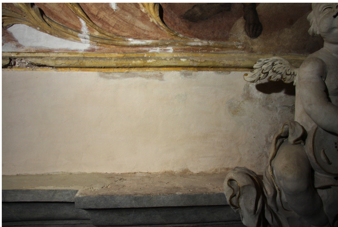
Obr. 75 (dole) Severní část pásu s oblaky, stav po vytmelení a opatření nové omítky vápenným nátěrem. K tmelení defektů vrstvy intonaca
