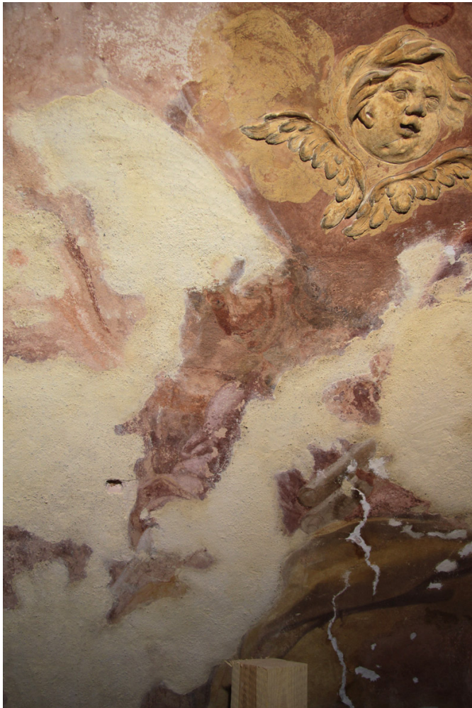
Obr. 61 Celkový pohled na horní polovinu postavy Archanděla, která se dochovala ve fragmentech. Všechny defekty v omítkách tohoto výjevu byly v letech 2005-2006 vytmeleny. Stav v průběhu sondážního průzkumu, v němž se zjišťoval stav omítek pod druhotnými tmely.
