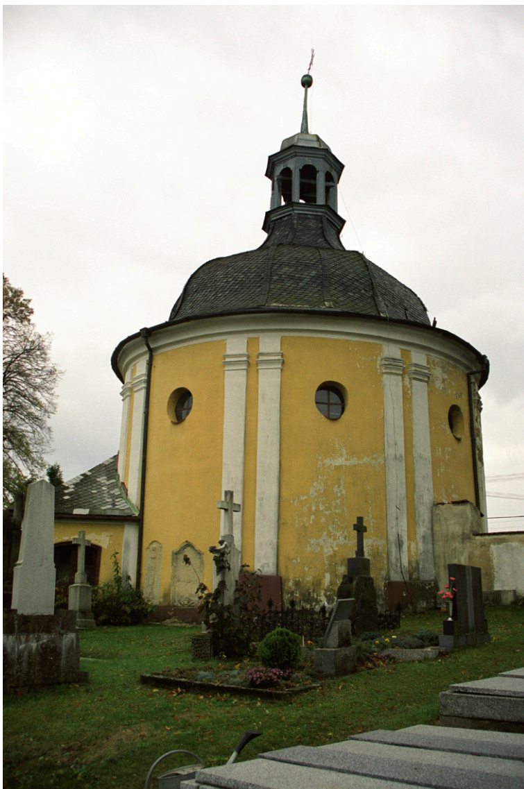
Obr. 34 Pohled na kapli sv. Isidora z roku 2003. Na severozápadní straně, odkud byla focena, byla kaple nejvíce poškozena. Autor: J. Švadlenka
