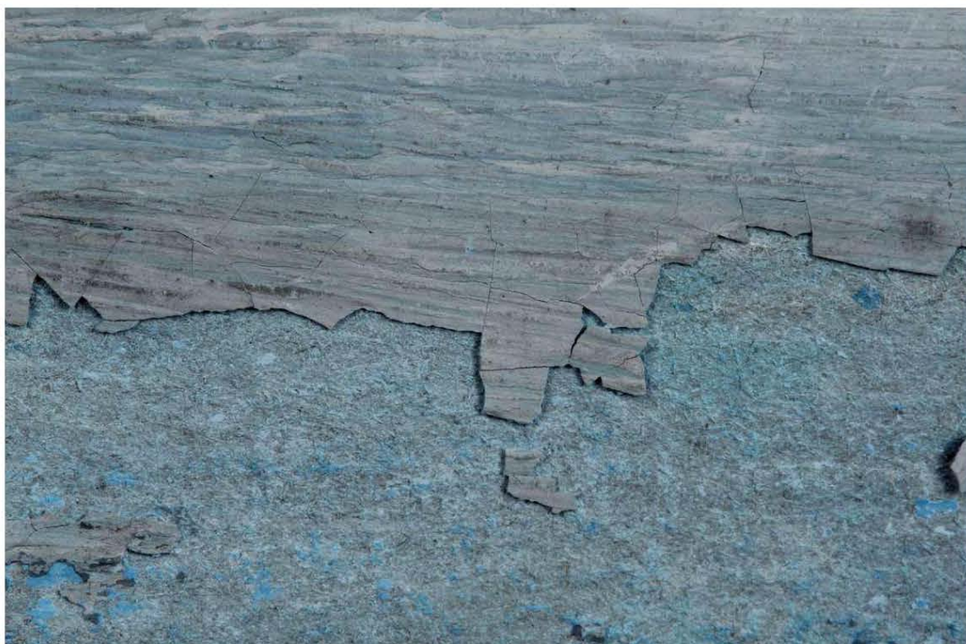
Obr. č. 443 Detail poškozené temperové malby, špatná adheze barevné vrstvy.
