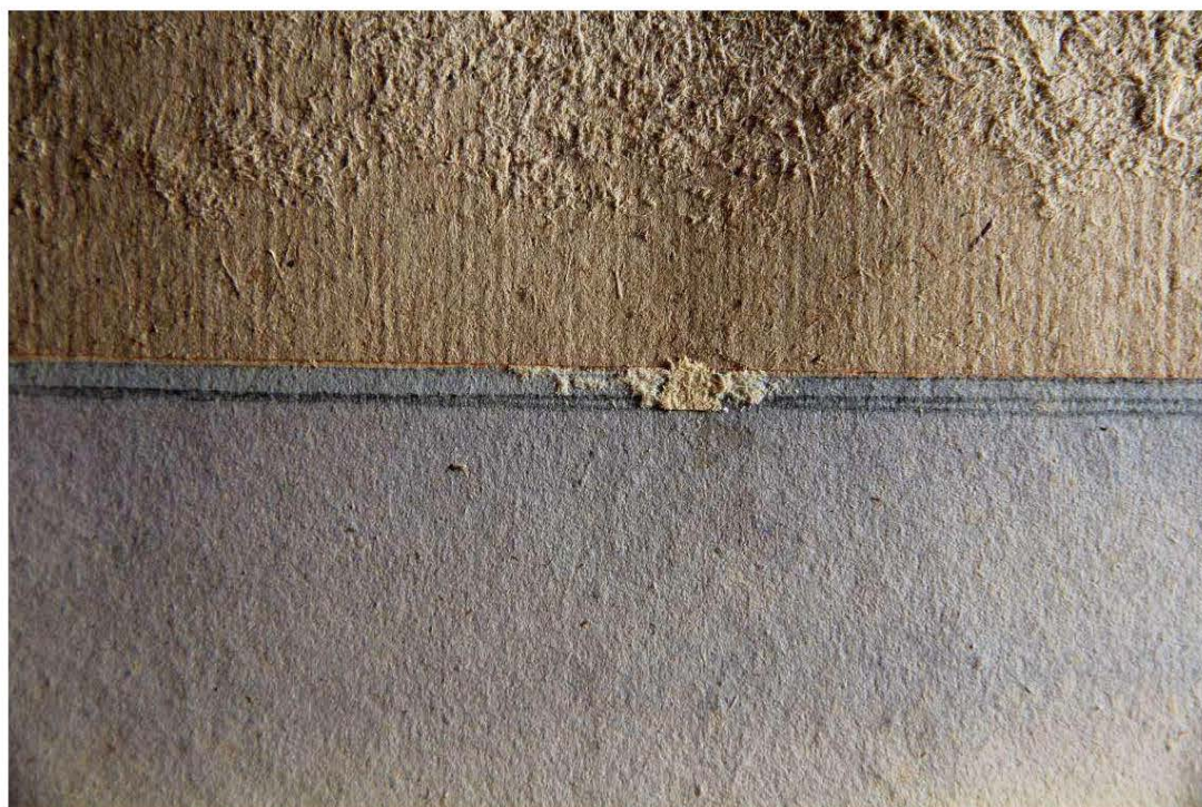
Obr. č. 198 Detail poškození.
