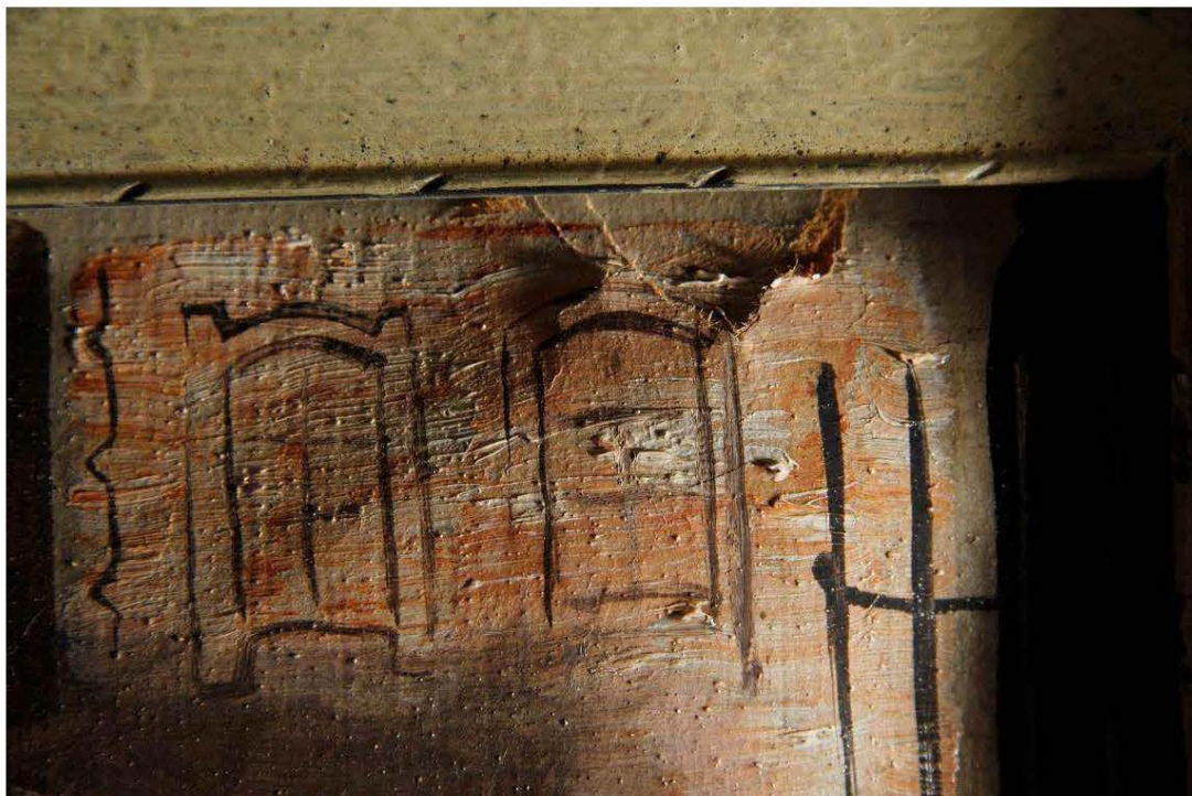
Obr. č. 570 Poškození papírové podložky v horní části.
