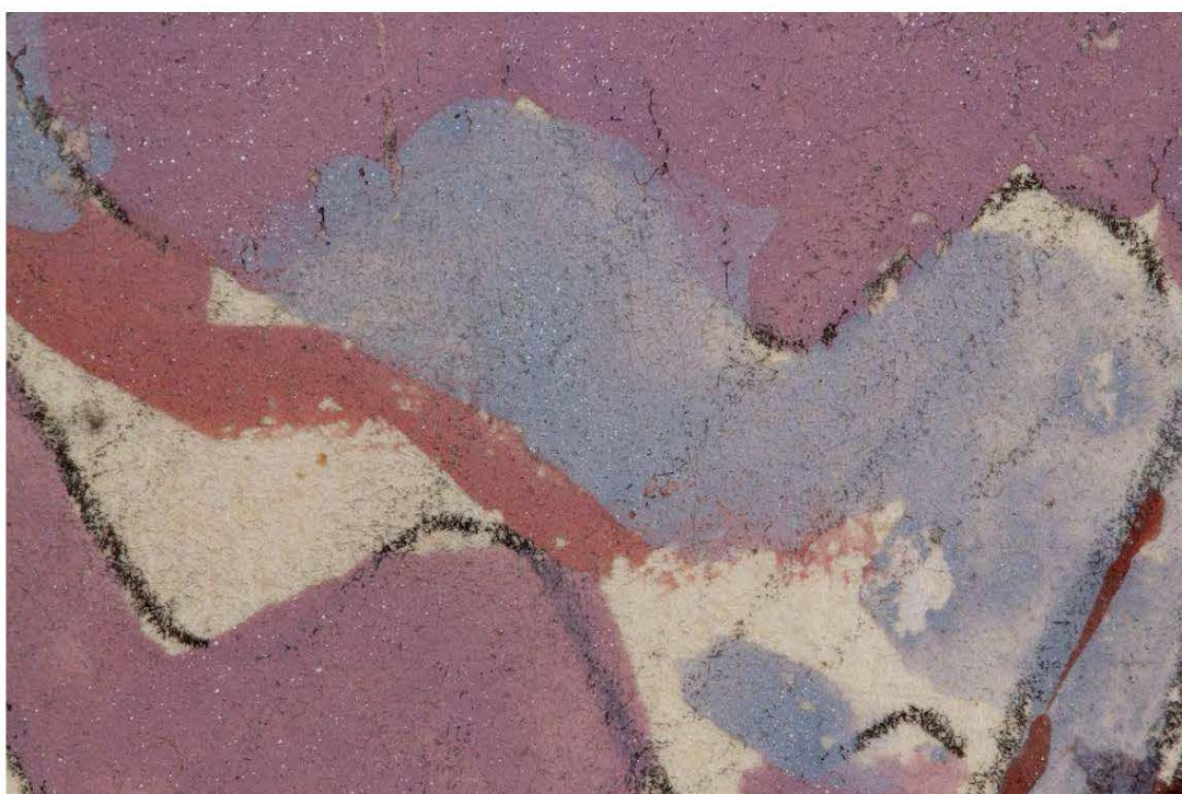
Obr. č. 306 Detail poškození, špatná adheze barevné vrstvy, vlasové trhliny.
