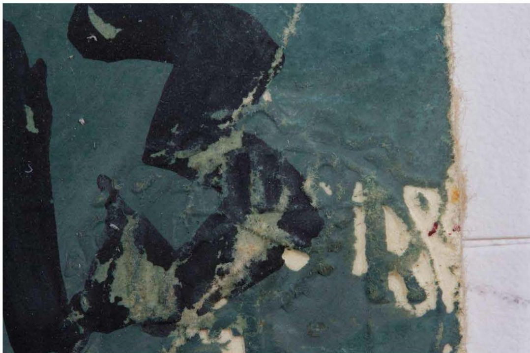
Obr. č. 460 Detail poškození temperové malby, špatná adheze.
