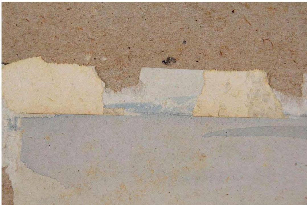
Obr. č. 145 V místě poškození lze vidět charakter lazurní barevné vrstvy.
