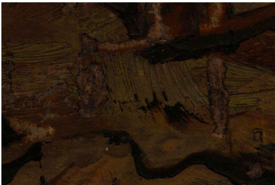
Obr. č. 587 Odlupování barevné vrstvy od podkladu.
