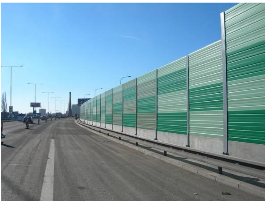
Obr. 13 - Protihluková stěna z hliníkových panelů [31]
