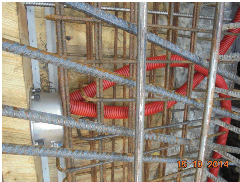
Obrázek 17 - Chráničky kabelu pro veřejné osvětlení
