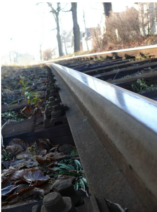
Obrázek 9: Boční ojetí vnitřní kolejnice v km 55,700
