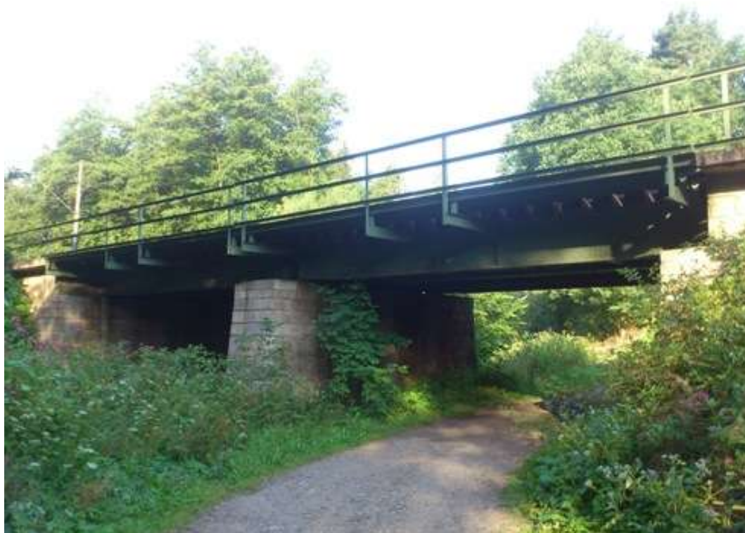
Úsek Sázavka – Leština u Světlé – ocelový most bez průběžného kolejového lože v km 249,330
