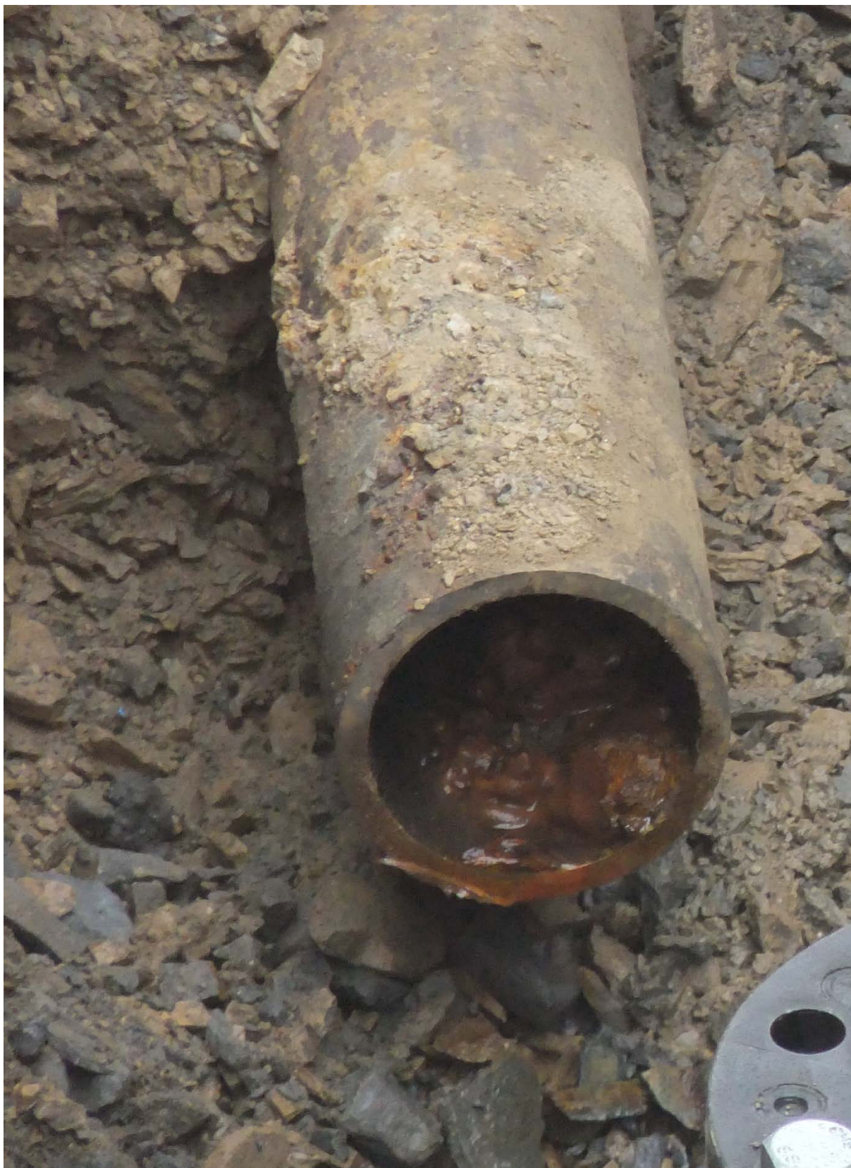
Obrázek 5: Ukázka středně silně inkrustovaného potrubí
