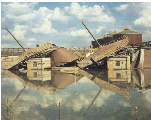
Obrázek č. 3: Destrukce plynojemů čistírny odpadních vod způsobené povodňovou událostí
