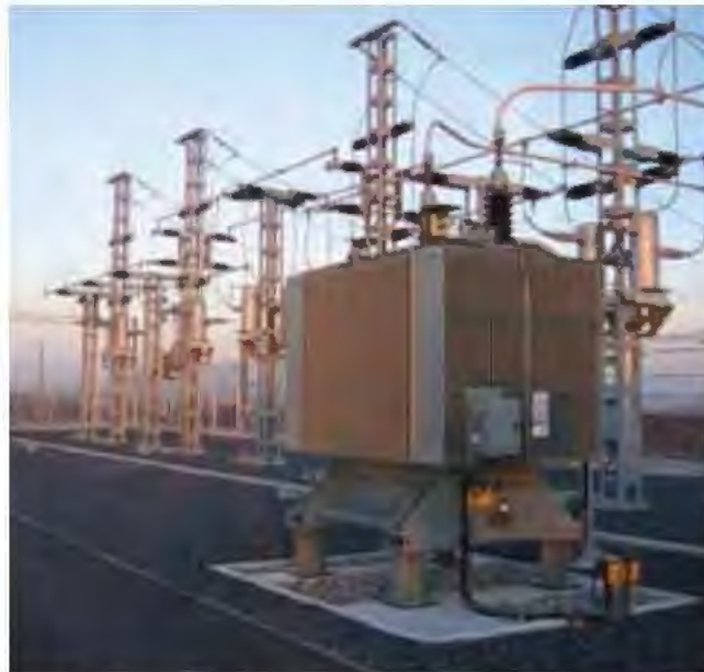
Obr. 68 Autotransformátor (železnice SNCF Francie) [17]
