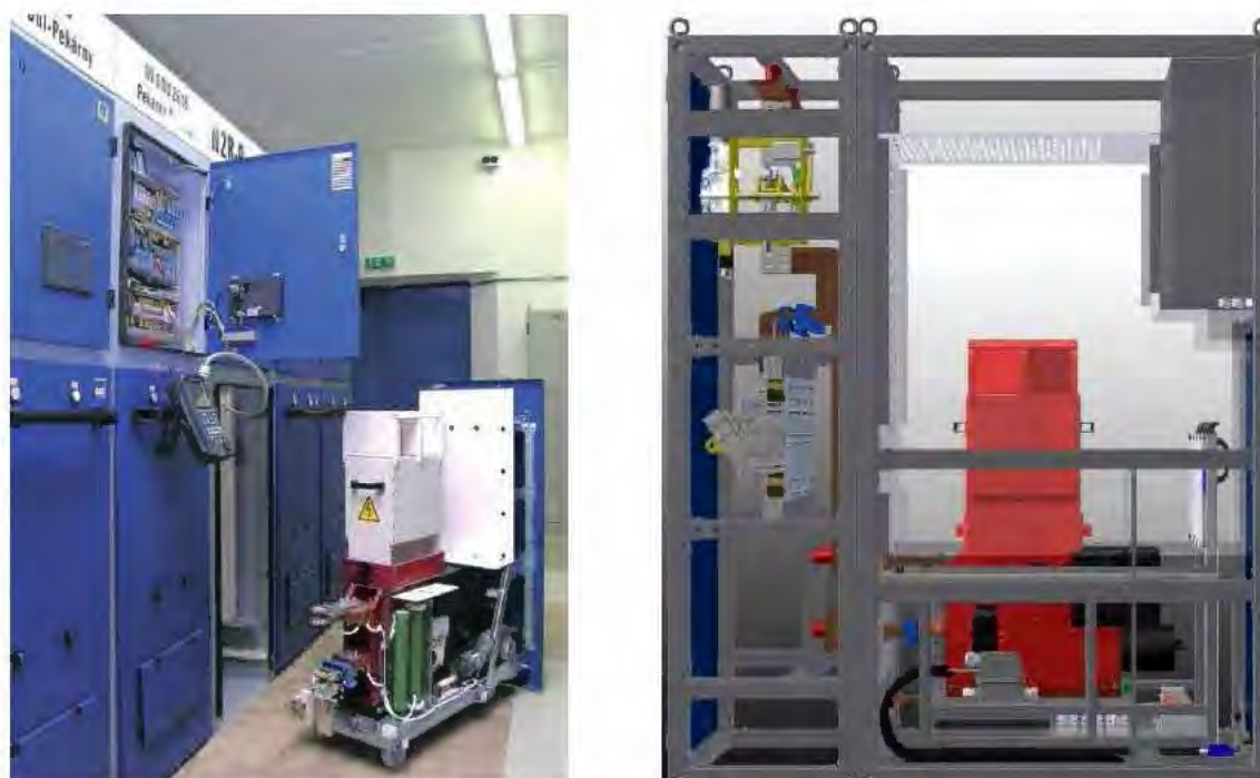
Obr. 9 Skříňový rozvaděč EZB 750 V DC části TNS, vpravo detail pole napáječe [11]
