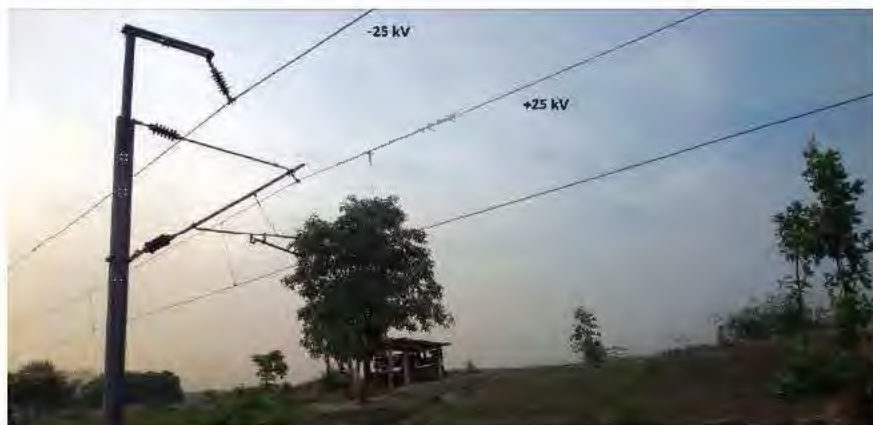
Obr. 62 Nadzemní vedení 2 \times 25 kV [25]
