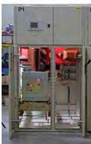
Obr. 57 Detail přívodního pole skříňového rozváděče [26]
