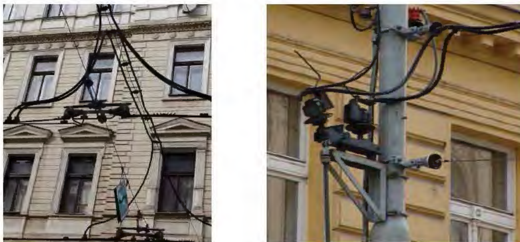
Obr. 11 Úsekové odpojovače trolejového vedení [13]
