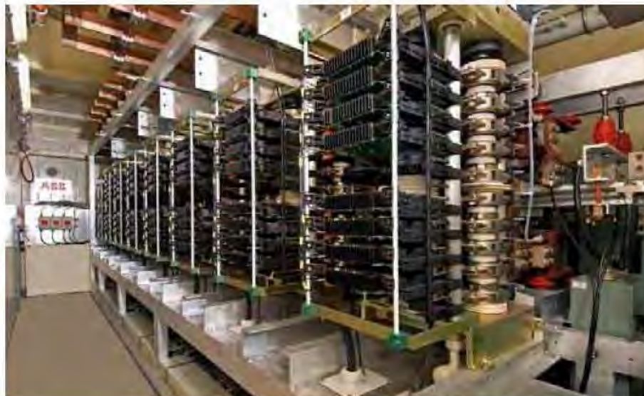
Obr. 48 Trakční frekvenční měnič PSC 6000 Rail (ABB) [30]
