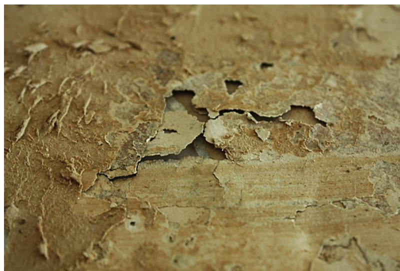
Obr. 25, poškodenie podložiek po sňatí lepenky
