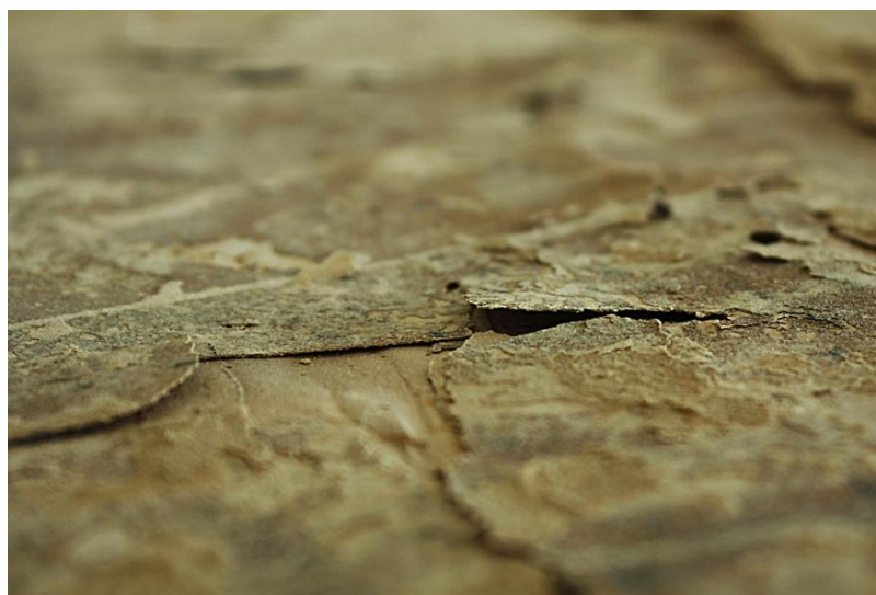
Obr. 26, poškodenie podložiek po sňatí lepenky
