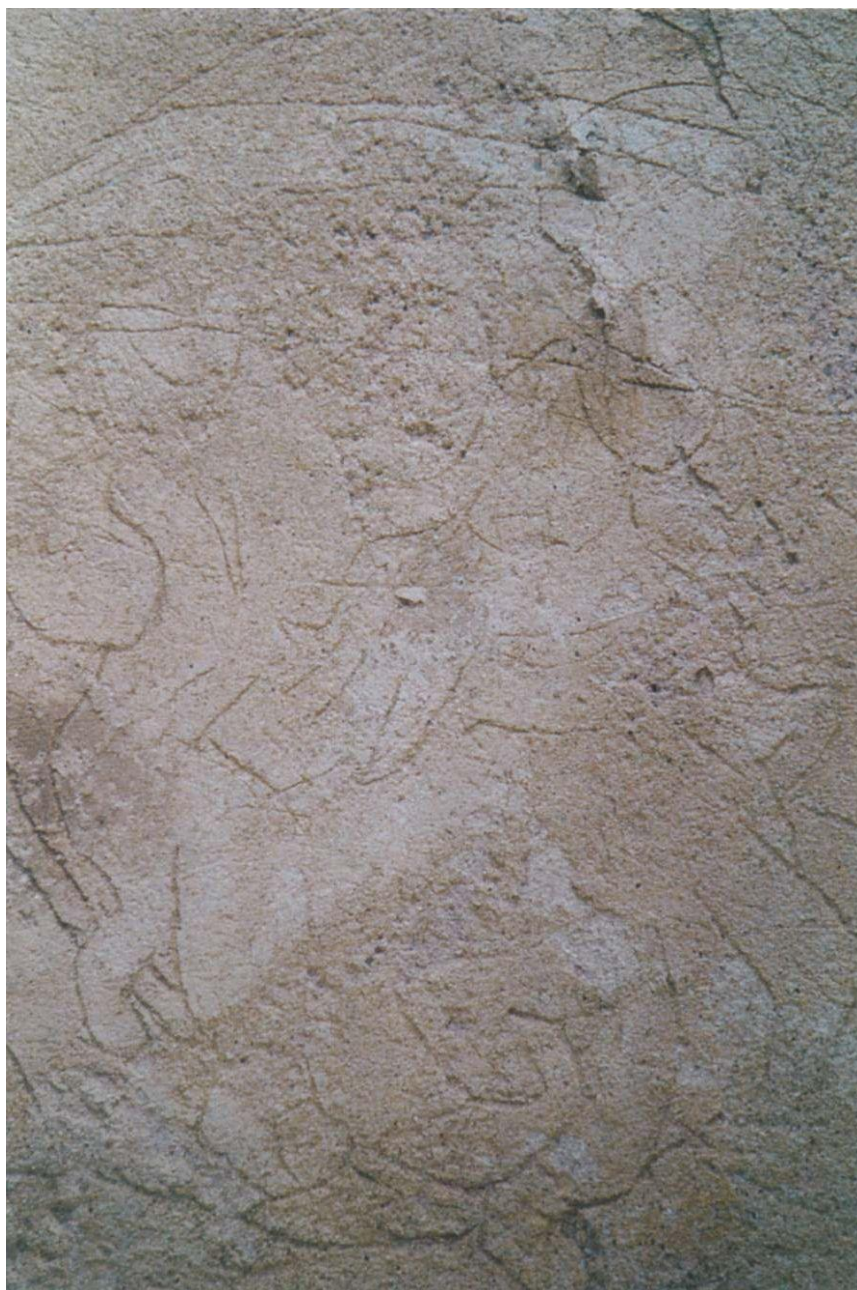
Obr. 45: Prostějov, dům Vladimíra Součka, malířská výzdoba štítu na jižní fasádě, pohled na levou část figurální kompozice. Detail poškození intonaka s rytou kresbou způsobeného dlouhodobým zatékáním.
