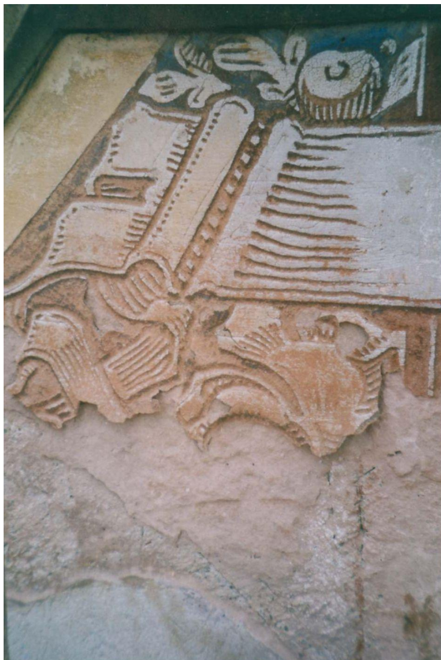
Obr. 46: Prostějov, dům Vladimíra Součka, malířská výzdoba štítu na jižní fasádě, pohled na levou část slunečních hodin. Detail poškození sgrafita způsobeného dlouhodobým zatékáním. Pod atikovou římsou se dochovalo modré stínování v rytých prohlubních.
