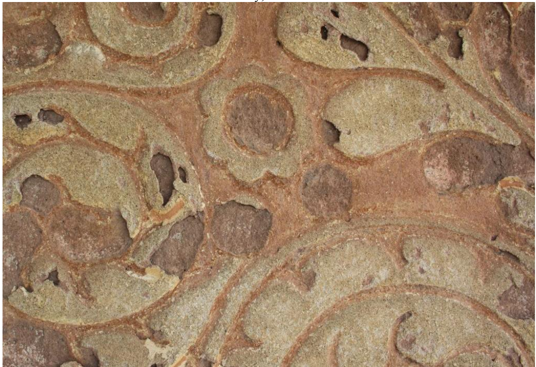
Obr. 69: Uherský Ostroh - Předměstí (okres Uherské Hradiště), zvonice, ornamentální výzdoba fasády. Fotografie dokumentuje stav omítky před restaurováním.
