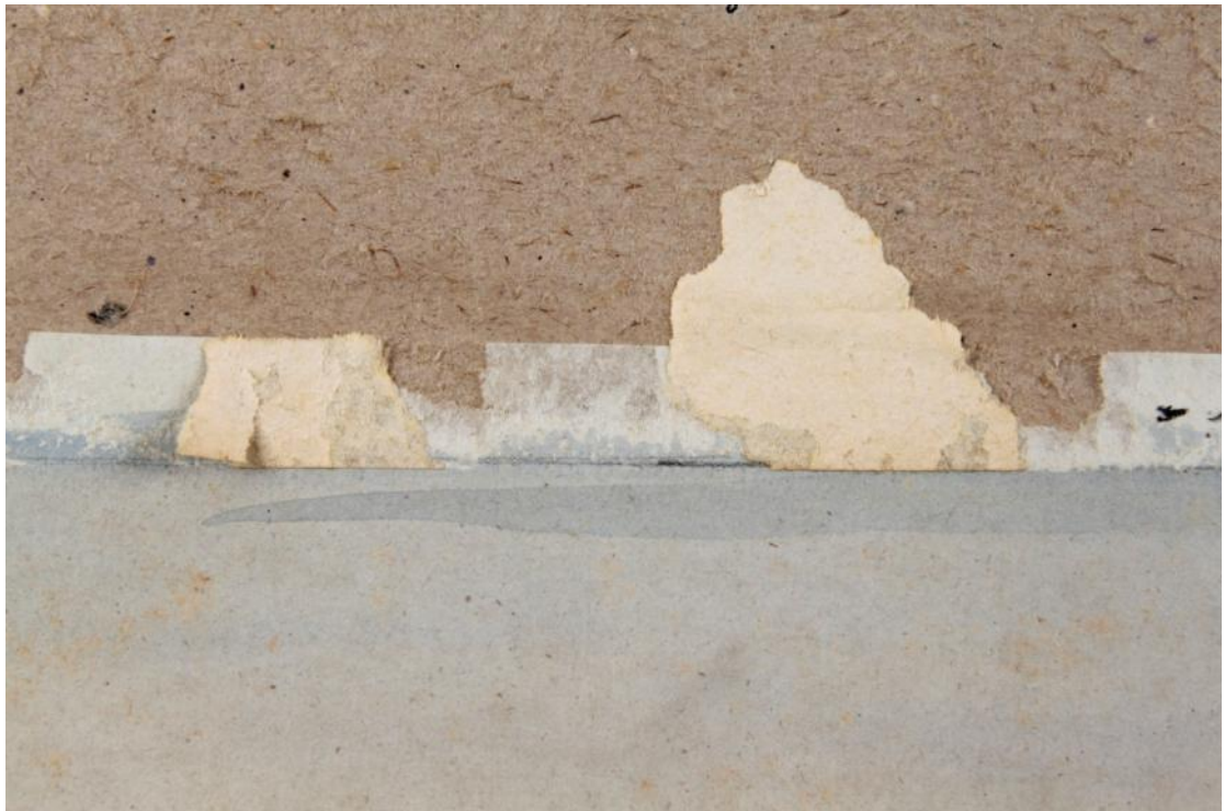
Obr. 41 Nábřeží Admirality , před restaurováním, detail poškození
