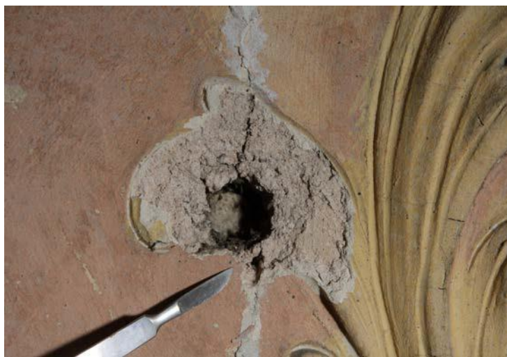
Obr. 121 Defekt v levé dolní části výjevu Seraphim, detail, vzorek O1.
