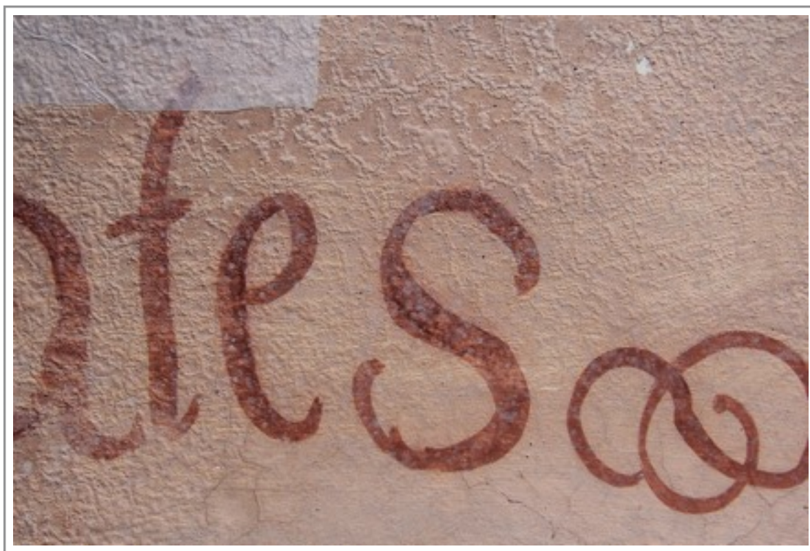
Obr. č. 14 Detail pozadí v horní části výjevu, stav před restaurováním Eflorescence solí
