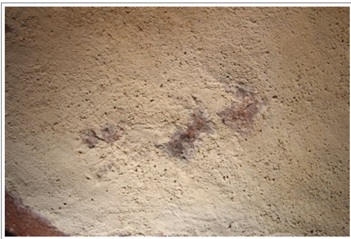
Obr. č. 12 Detail malby baziliška, stav před restaurováním Tmel ze zajišťovacího zásahu (2005 a 2006) a fragmenty malby
