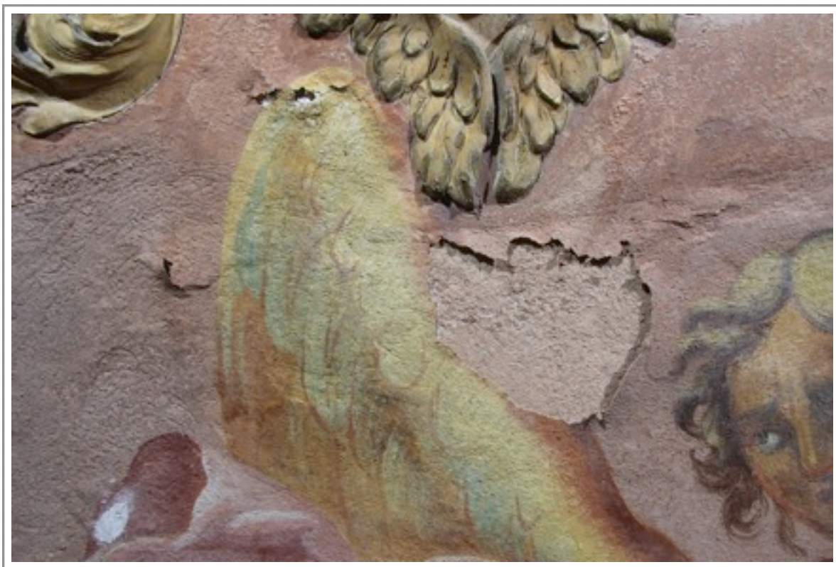
Obr. č. 5 Detail malby anděla: stav před nanesením ochranných přelepů (říjen 2013) Održené intonaco
