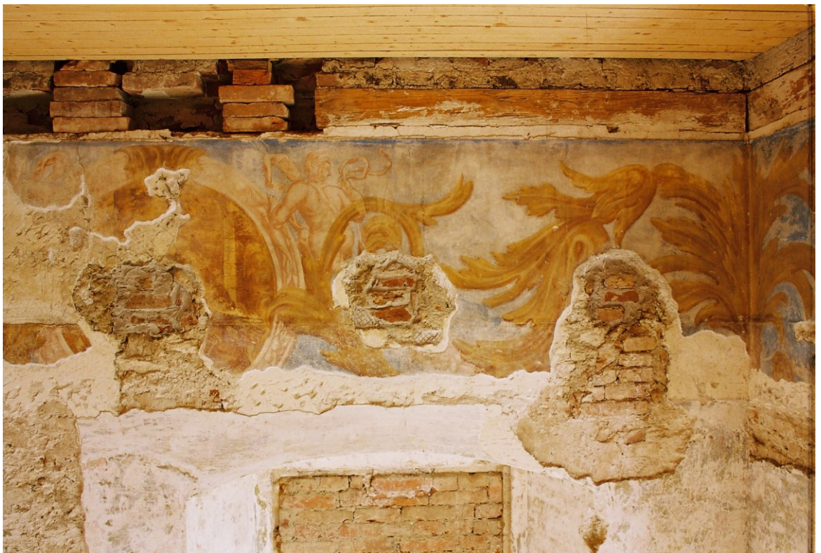
Obr. 12, 13: Východní stěna vlevo a vpravo – upevněné okraje omítek s malbou po očištění a fixáži barevné vrstvy, dozděné kapsy po trámech.
