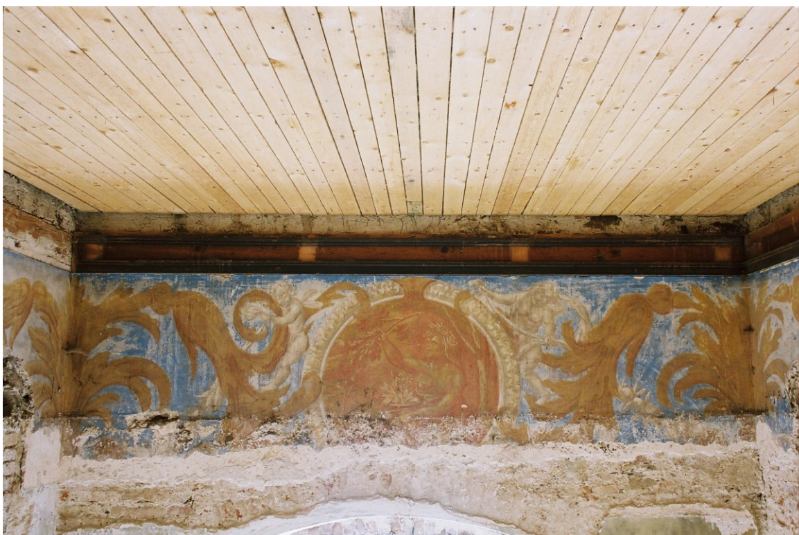
Obr. 11: Jižní stěna – stav před restaurováním maleb.
