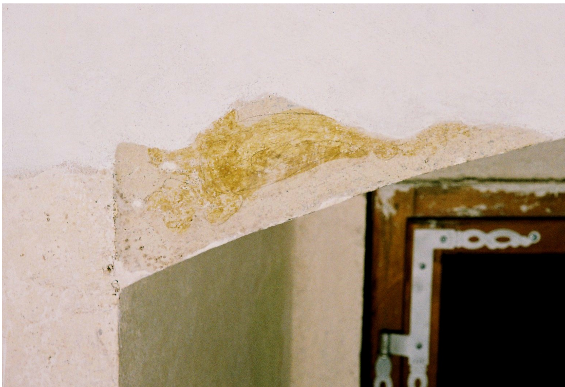
Obr. 22: Ojediněle zjištěný fragment malby rozviliny ze spodního okraje malby vlysu při levé straně hrany segmentově zaklenutého podhledu okenní špalety, trojúhelníkový tvar fragmentu je svisle ohraničen rytou linkou.
