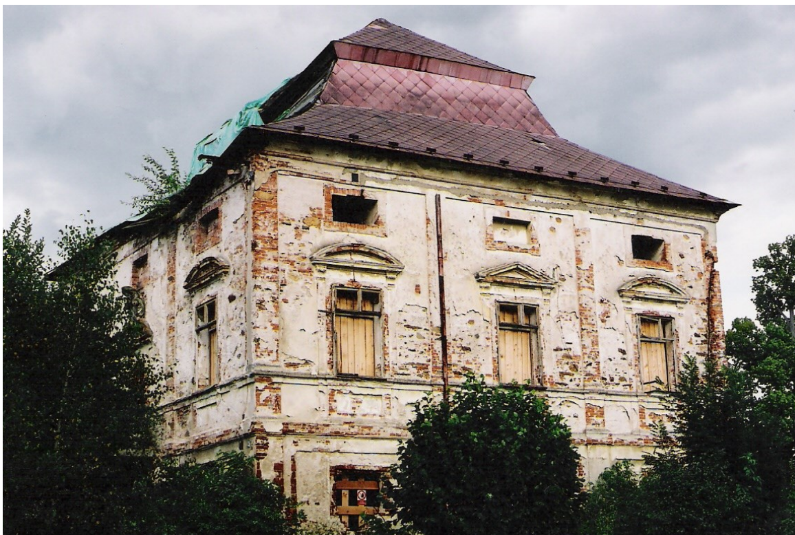
Obr. 2: Havarijní stav Thunovského letohrádku v r. 2004.
