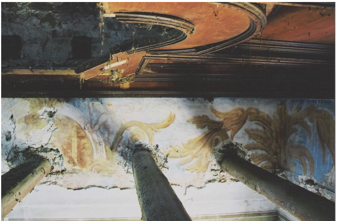
Obr. 3, 4: Malby na levé a pravé části východní stěny arcibiskupské ložnice v době havarijního stavu celého objektu v r. 2004.
