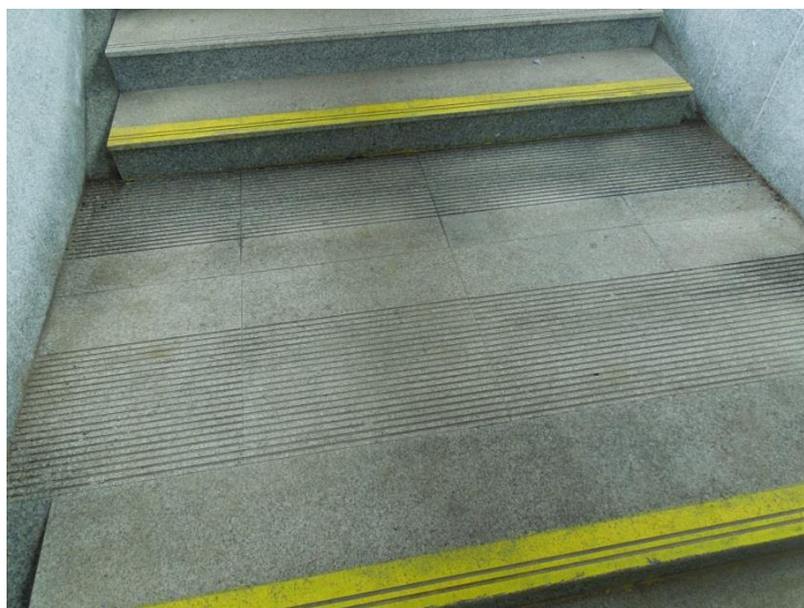
Obr. 21 Chybné řešení hmatně kontrastního pásu schodiště Zdroj: Autor
