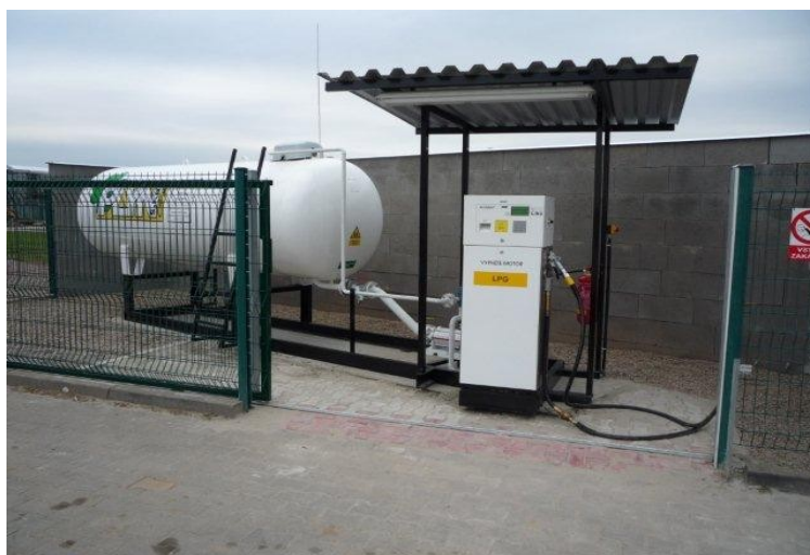
Obr. č. 20 Stojan na LPG
