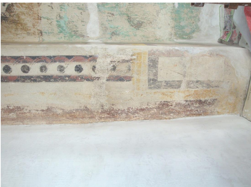
Obr. 76, 77: Boční špalety zazděného dveřního otvoru – stav po tmelení, úprava povrchu tmelů a dveřní zazdívký vápenným pačokem.
