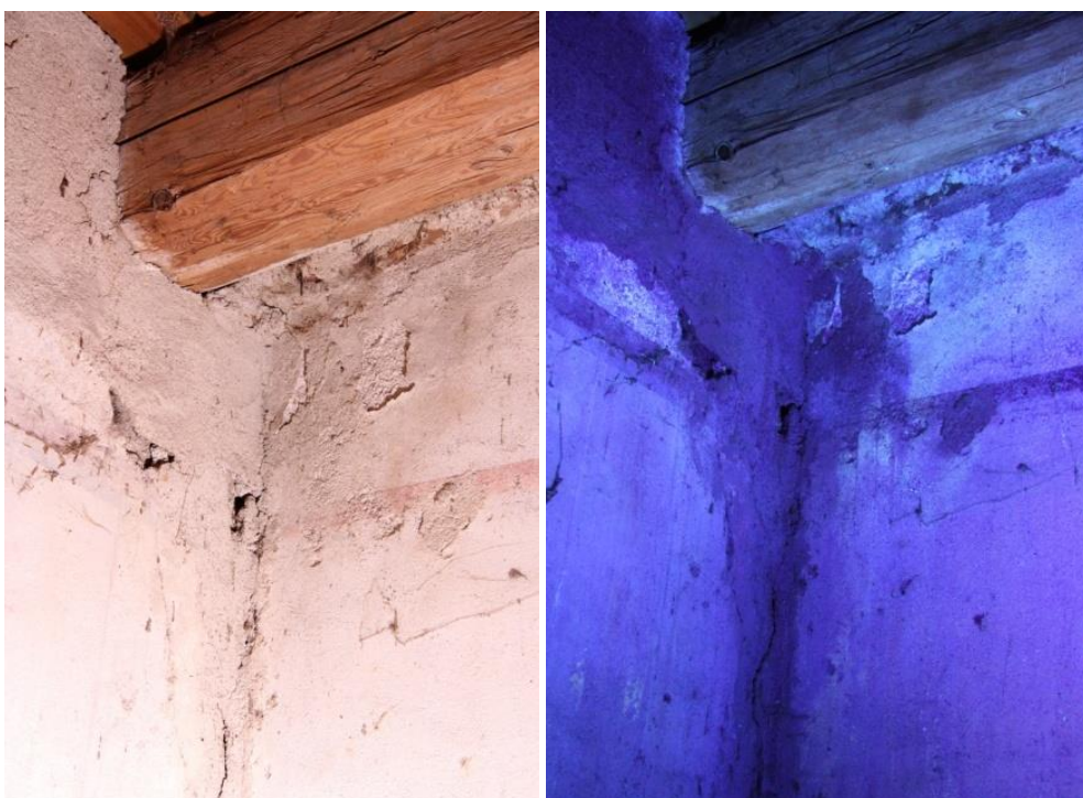
Obr. 34, 35: Horní část stěny v jihozápadním koutu místnosti v denním světle. Průzkum v UV světle prokazuje bělavou luminiscenci na okraji degradovaného místa defektu. Důvod této luminiscenci nebyl prokázán ani laboratorní analýzou.
