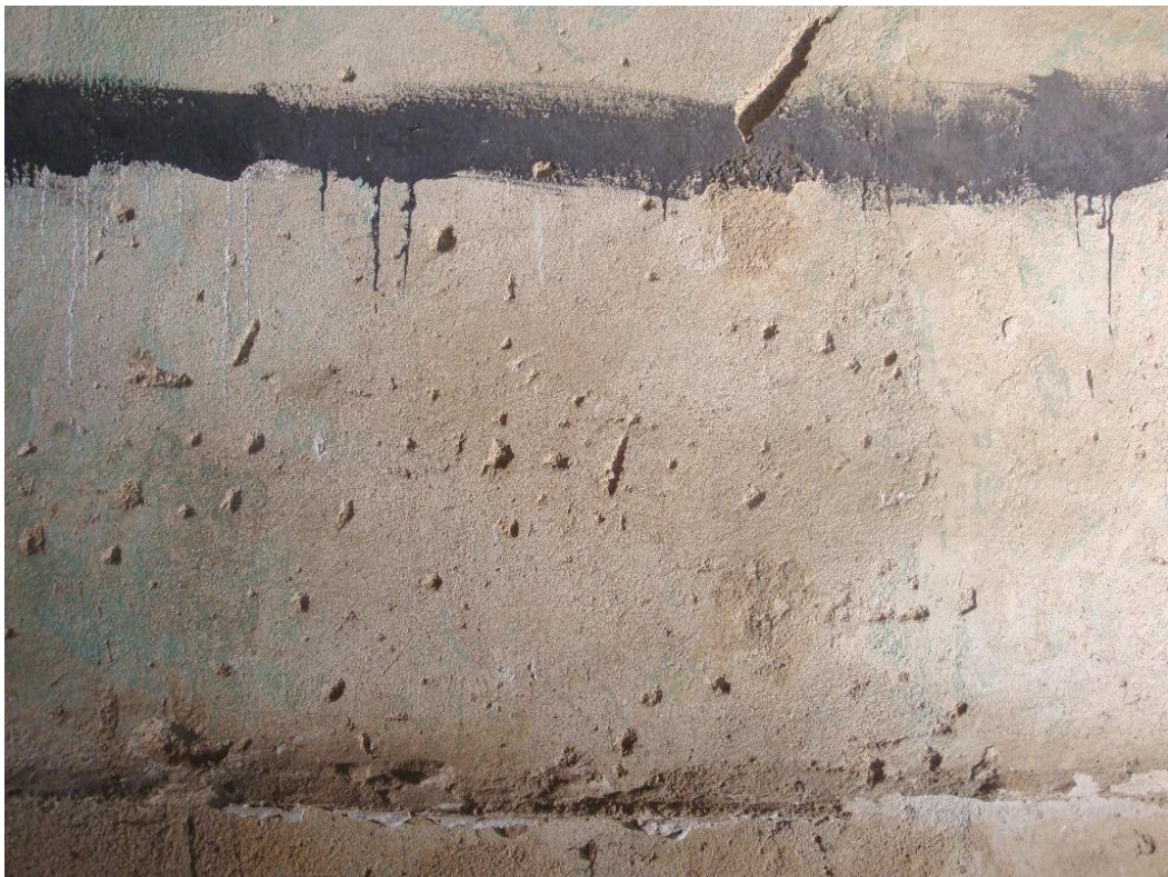
Obr. 6: Soklová středová část s defekty v omítce – nasvícení v bočním světle.
