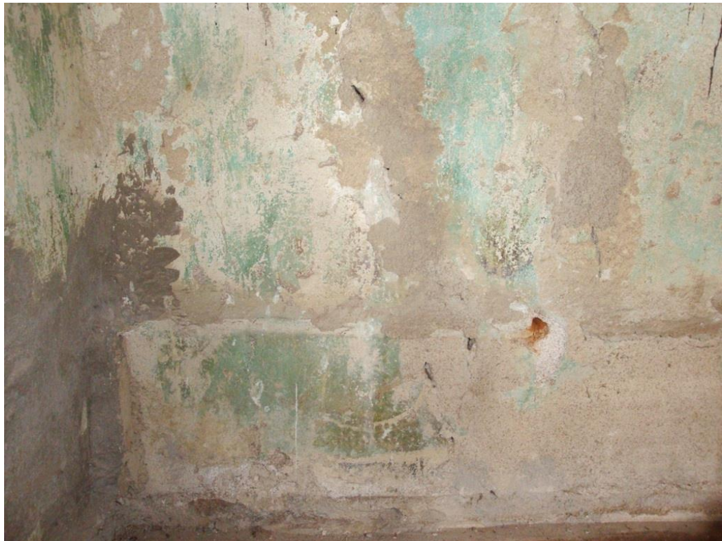
Obr. 21: Detail levého koutu soklové části s vápennými a cementovými nánosy.
