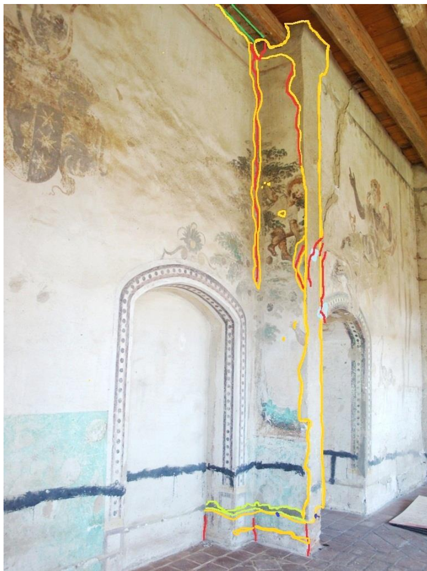
Graf. 7. Grafické znázornění poškození, lokace prasklin.
