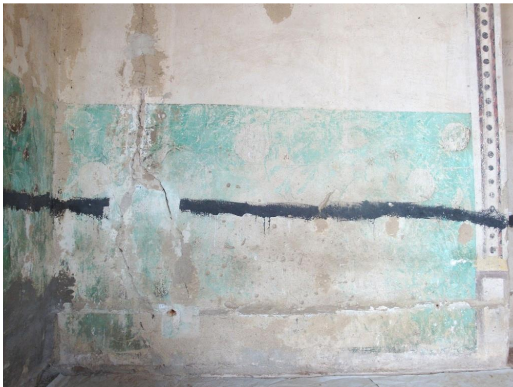
Obr. 36: Soklová část před odstraněním černého pruhu.
