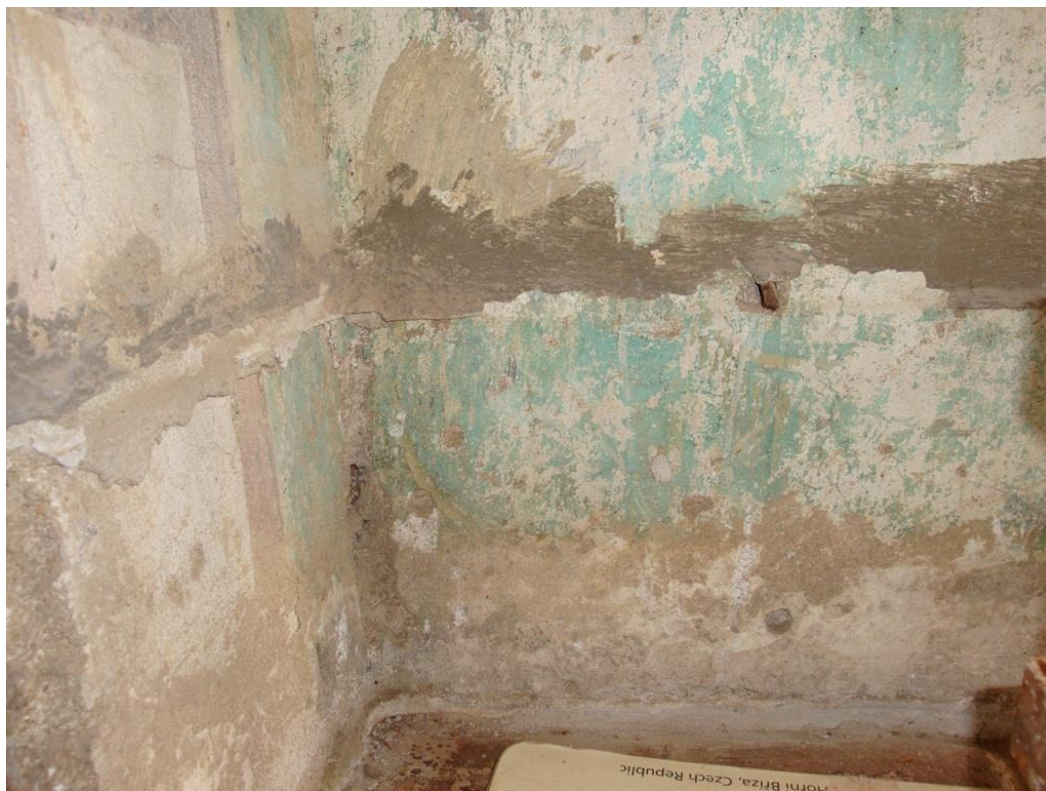
Obr. 22: Spodní část soklu v pravém koutu vedle severní stěny. Úsek poškození s cementovými a vápennými nátěry v úrovni bývalé druhotně zvýšené podlahy.
