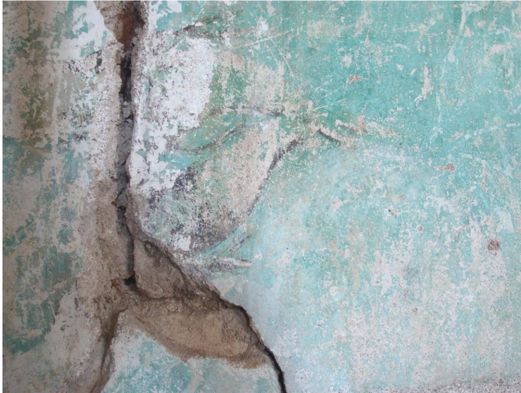
Obr. 46: Detail praskliny v soklové části po očištění.
