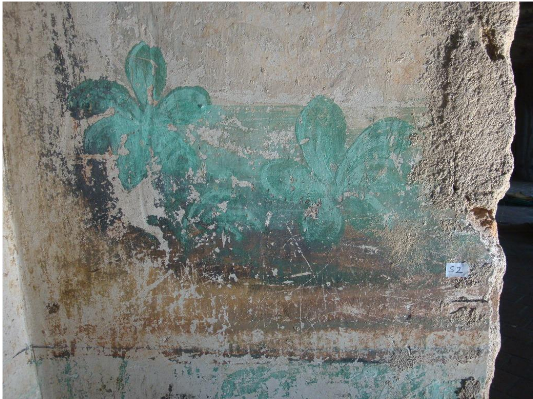
Obr. 7: Spodní část fragmentu severní stěny se sondou S2 v dolní části pod stromem prokazuje jednovrstvou omítku na cihlovém zdivu.
