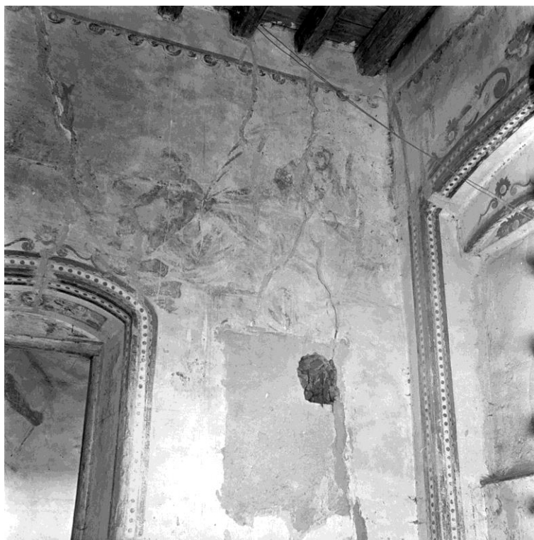
Obr. 7: Severní stěna vedle východního koutu se zazděným oknem v Dětském pokoji v 1. patře, stav z roku 1963 (foto: Suchomel). 85 (Viz také obr. 25 – OP2)
