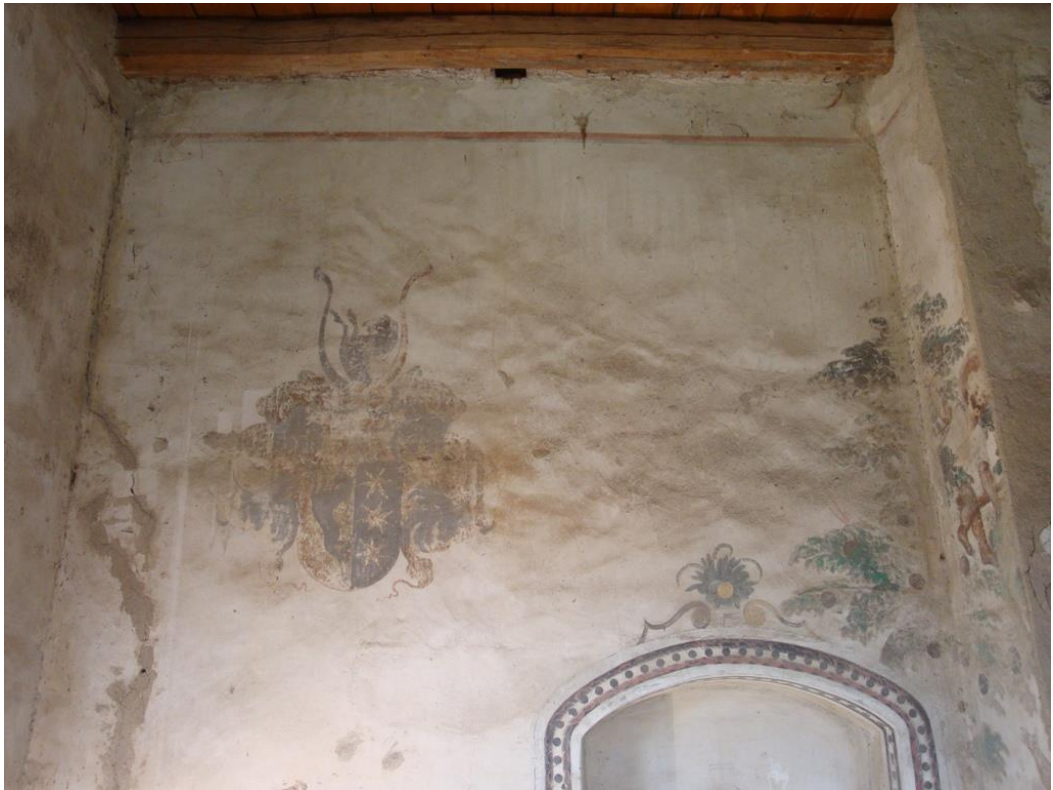
Obr. 16: Horní část malby před odstraněním prachových nánosů na zvlněném povrchu intonaka.
