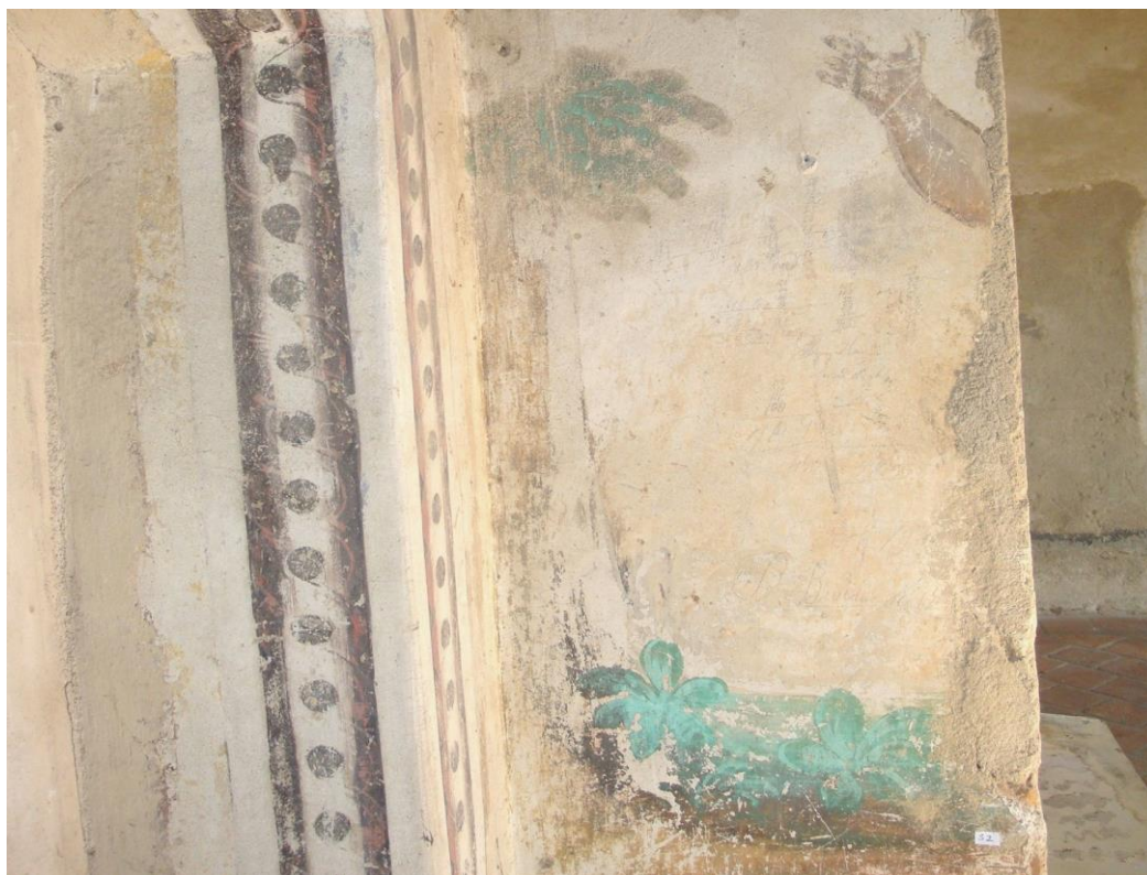
Obr. 40: Spodní část malby na severní stěně a ve dveřní špaletě s vápennými nátěry.
