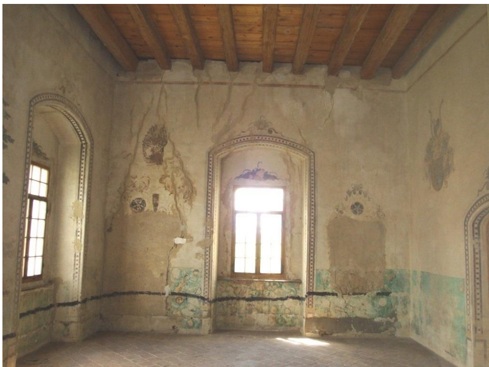
Obr. 21: Pohled na jižní stěnu Dětského pokoje se zazděnou historickou toaletou nalevo i zazděným výklenkem napravo. Erb J. Krčína v levé horní části malby je doplněn dekorem s rožmberskou růží, která se opakuje i na pravé straně.
