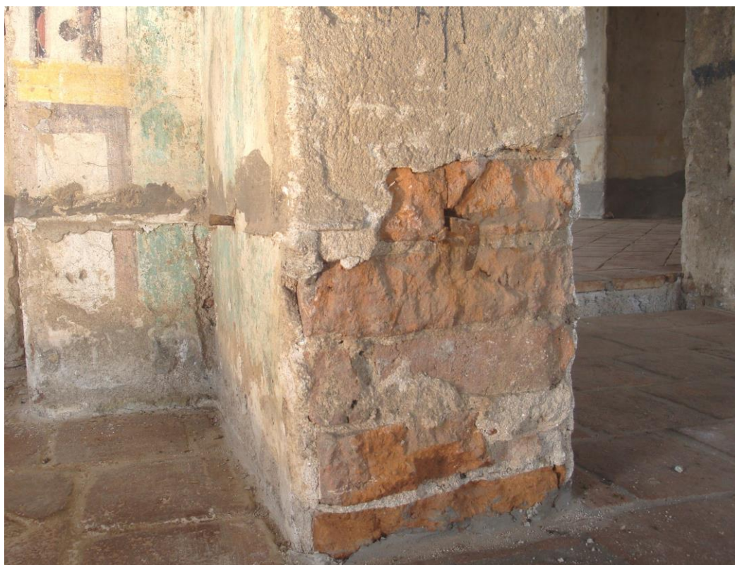
Obr. 41: Spodní část ubourané přičky s odhaleným cihlovým zdivem a železnou skobou.
