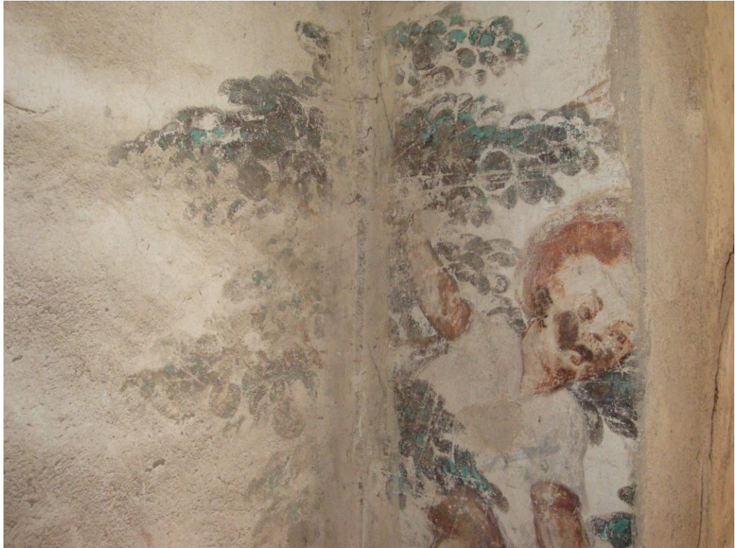
Obr. 18: Horní část malby v severozápadním koutu stěny s prasklinou přetřenou vápenným nátěrem. Povrch malby je poškozen vrypy, škrábanci a vápennými nánosy.
