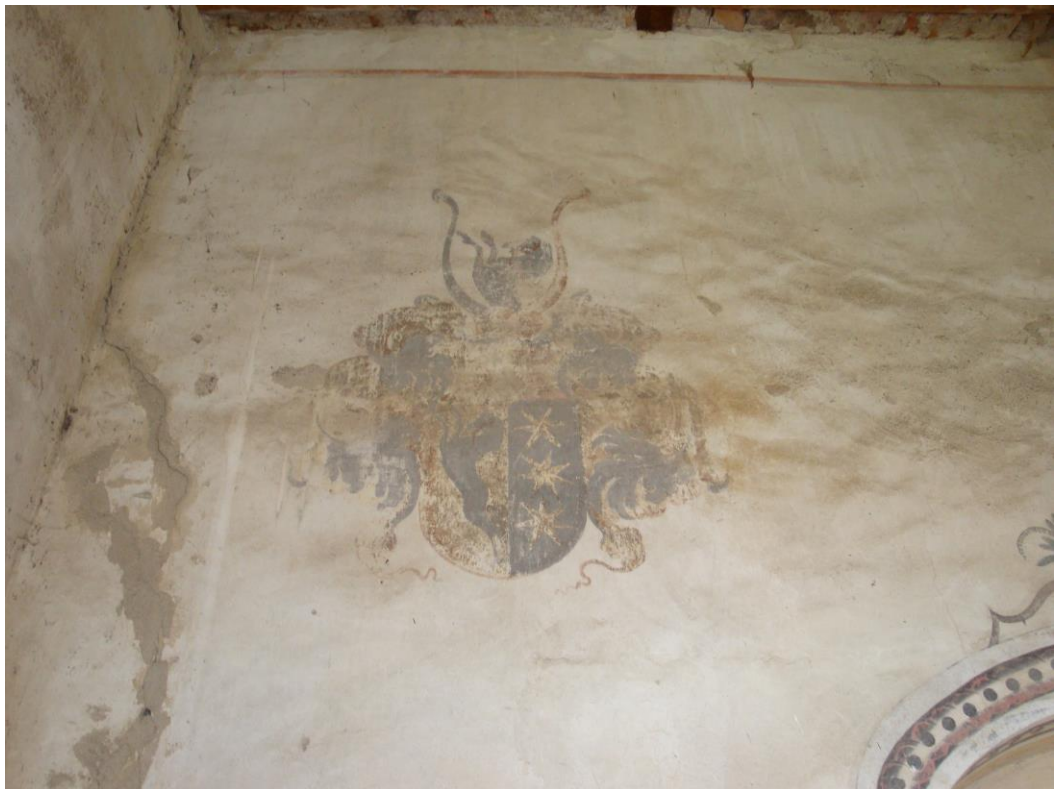
Obr. 4: V horní části stěny je vyzděná část stropu řadou pálených cihel, uprostřed jedna chybí.
