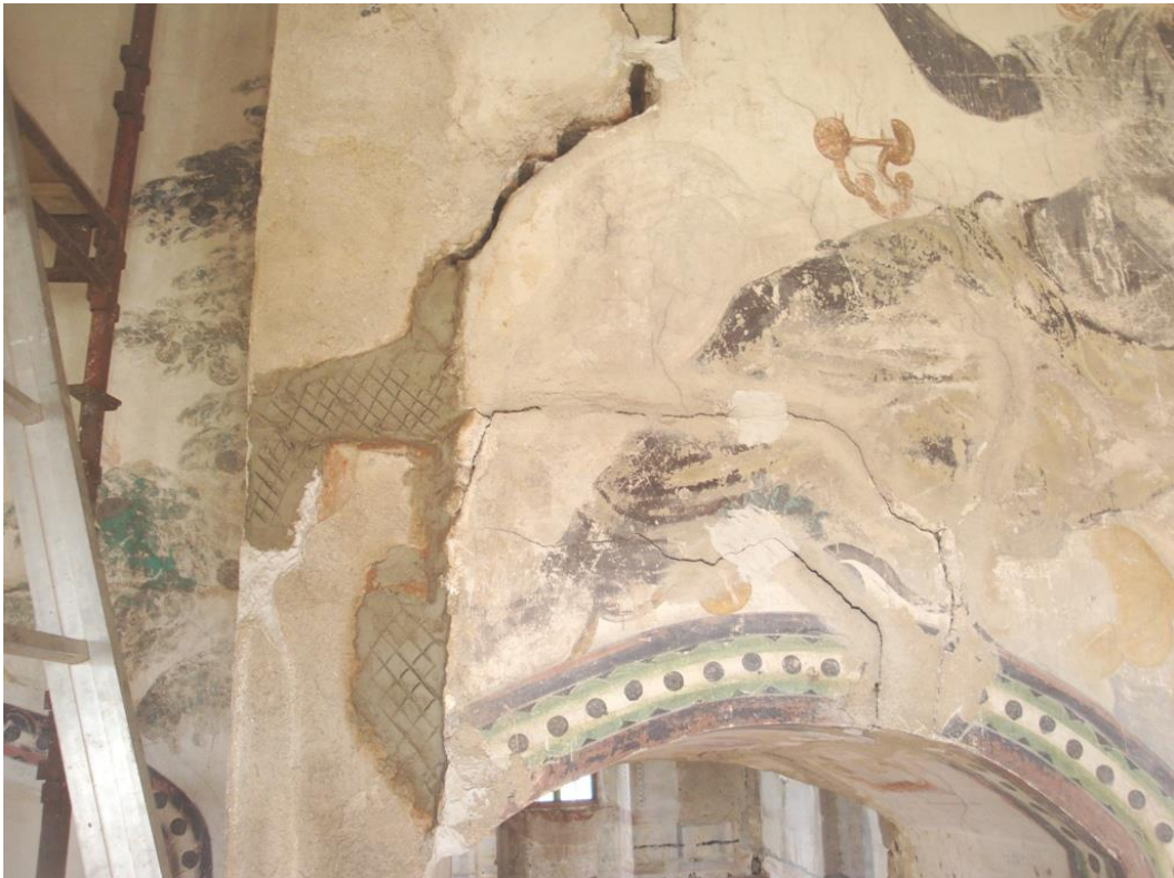
Obr. 62, 63: Středová část ubourané severní příčky v průběhu hloubkové konsolidace a tmelení rozsáhlých prasklin.
