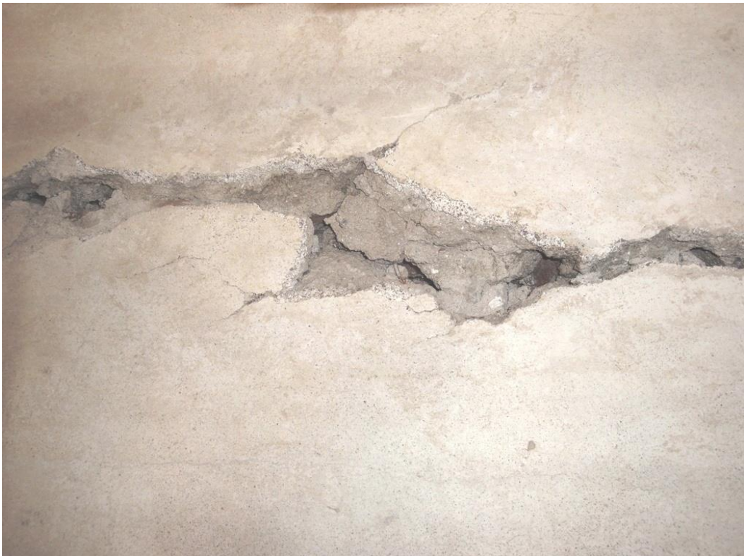
Obr. 58, 59: Jižní část stěny – místo hlubokých prasklin, stav po čištění.
