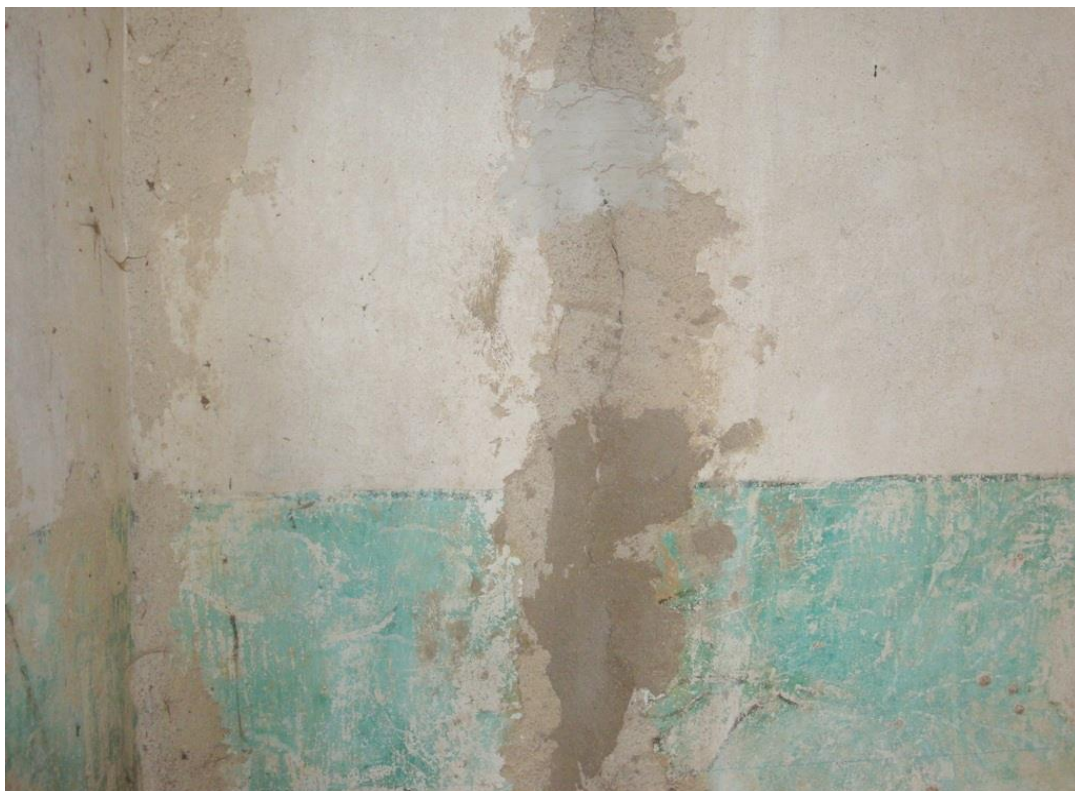
Obr. 14: Vertikální prasklina v levé spodní části západní stěny s vápennými, cementovými vysprávkami a sádrovým můstkem.
