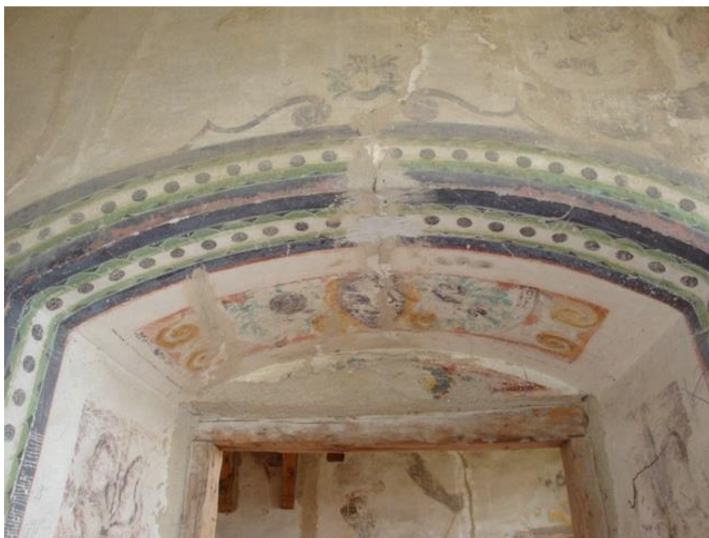
Obr. 26: Dveřní otvor na severní stěně. Detail pohledu hrany špalety s výzdobou pásového pletence. Ve středové části je viditelná hlava maskarona.
