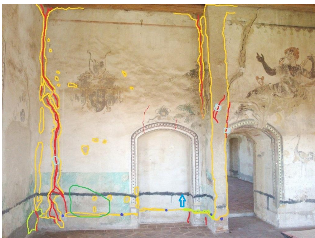
Graf. 6. Grafické znázornění poškození, lokace prasklin.
