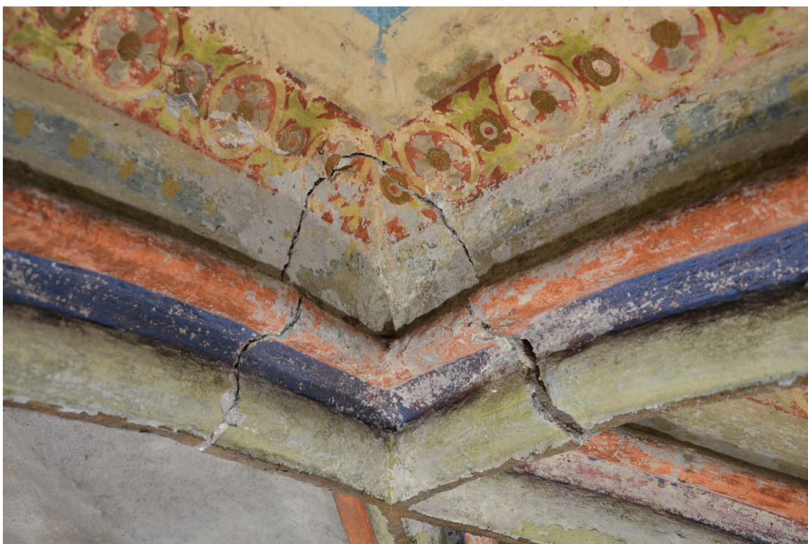
24. Detail poškození, statická trhlina ve středu klenby. Stav před restaurováním.
