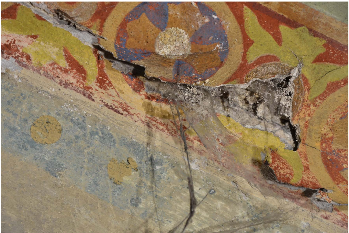
26. Detail poškození, uvolněné omítkové vrstvy v oblasti praskliny. Stav před restaurováním.
