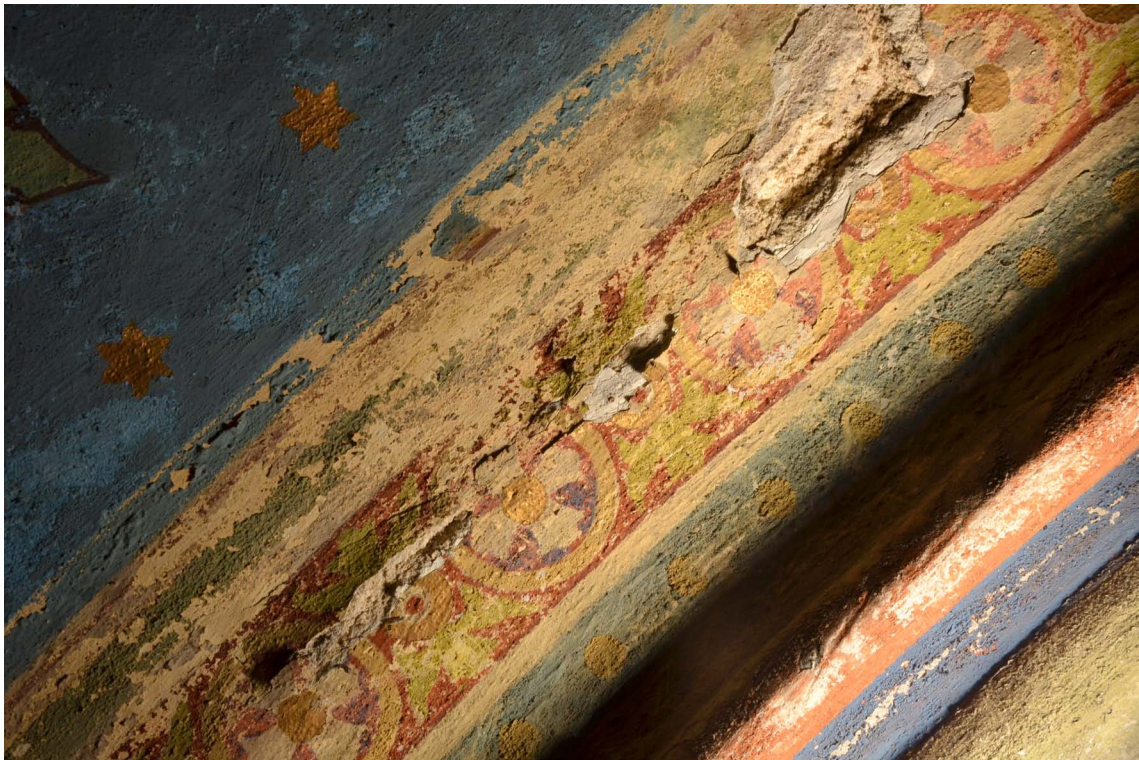
90. Detail podélné praskliny mezi žebry a plochou klenby. Stav před restaurováním. Foto v bočním světle.
