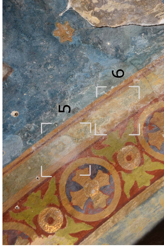
80. Místo zkoušky stabilizace síranu vápenatého nanosuspenzí hydroxidu barnatého. Před aplikací.
