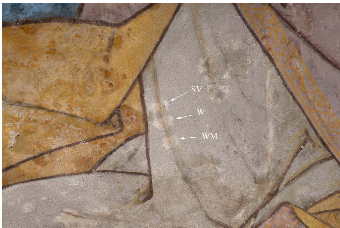
48. Zkoušky snímání přemalby v šatu anděla. SV - pomocí skelného vlákna, W - pomocí houby Wishab, WM - pomocí houby Wall Master. Přemalba je na tomto místě odstranitelná jen částečně, nelze odstranit překryvnou okrovou linii.
