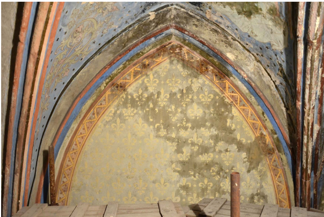
31. Horní část šablonového dekoru na východní stěně Šperlinkovské kaple. Malba je poškozena zatékáním.
