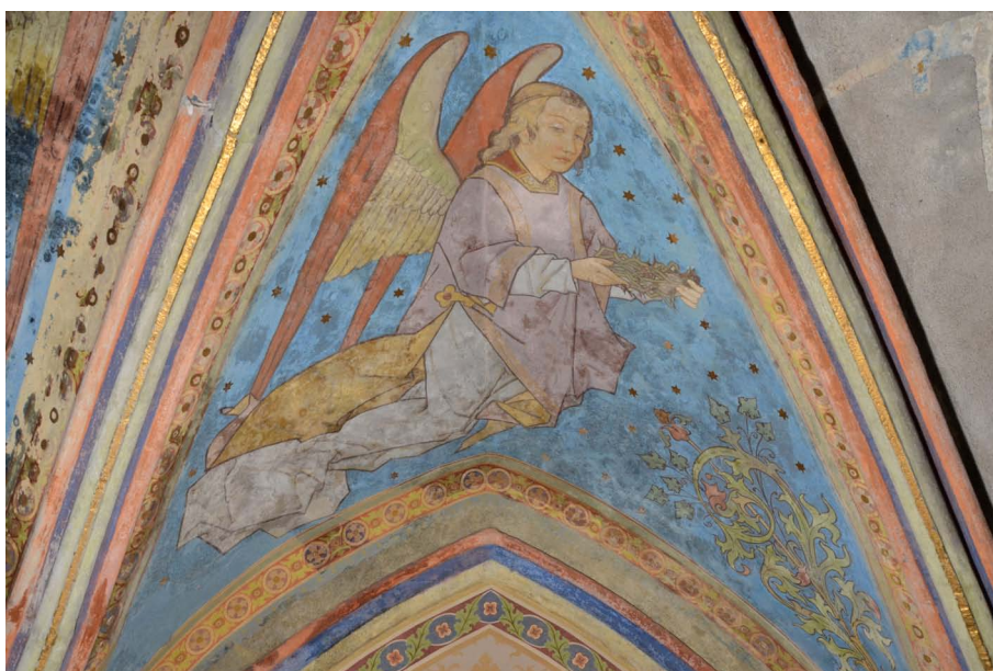
30. Figurální malba v pravém klenebním poli Řeznické kaple. Anděl s trnovou korunou. Stav po restaurování v roce 2012.
