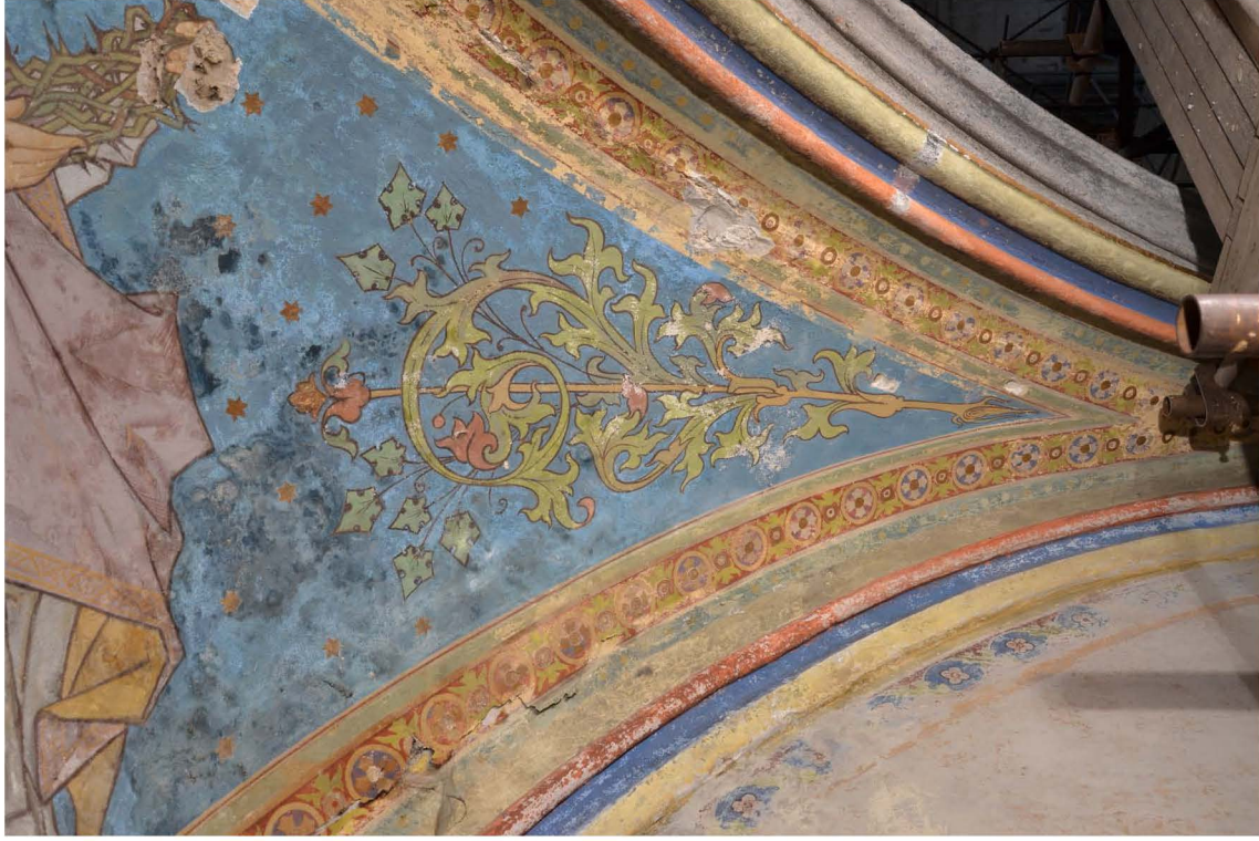
19. Pravý spodní kout klenby. Stav před restaurováním.
