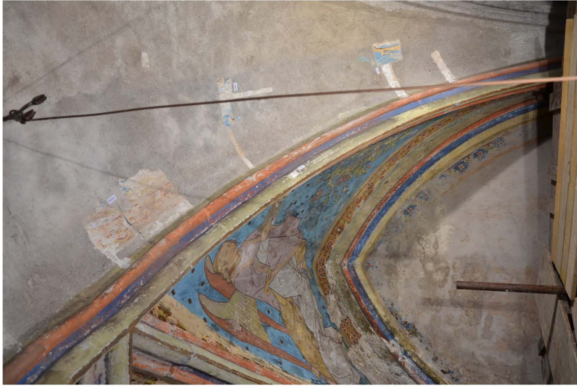
21. Klenební pole sousedící s restaurovaným výjevem, zakryto hrubou vápno-cementovou omítkou.
