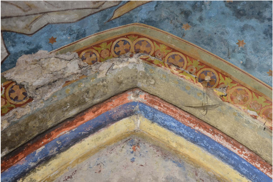
25. Detail poškození, podélná prasklina mezi žebry a plochou klenby. Stav před restaurováním.
