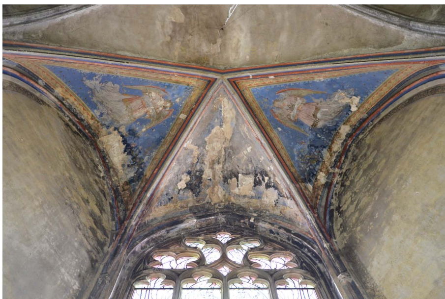
22. Celkový pohled na klenbu Mlynářské kaple. V krajových klenebních výsečích se nacházejí figurální malby. V prostřední klenební výseči je malba zničena masivním zatékáním.
