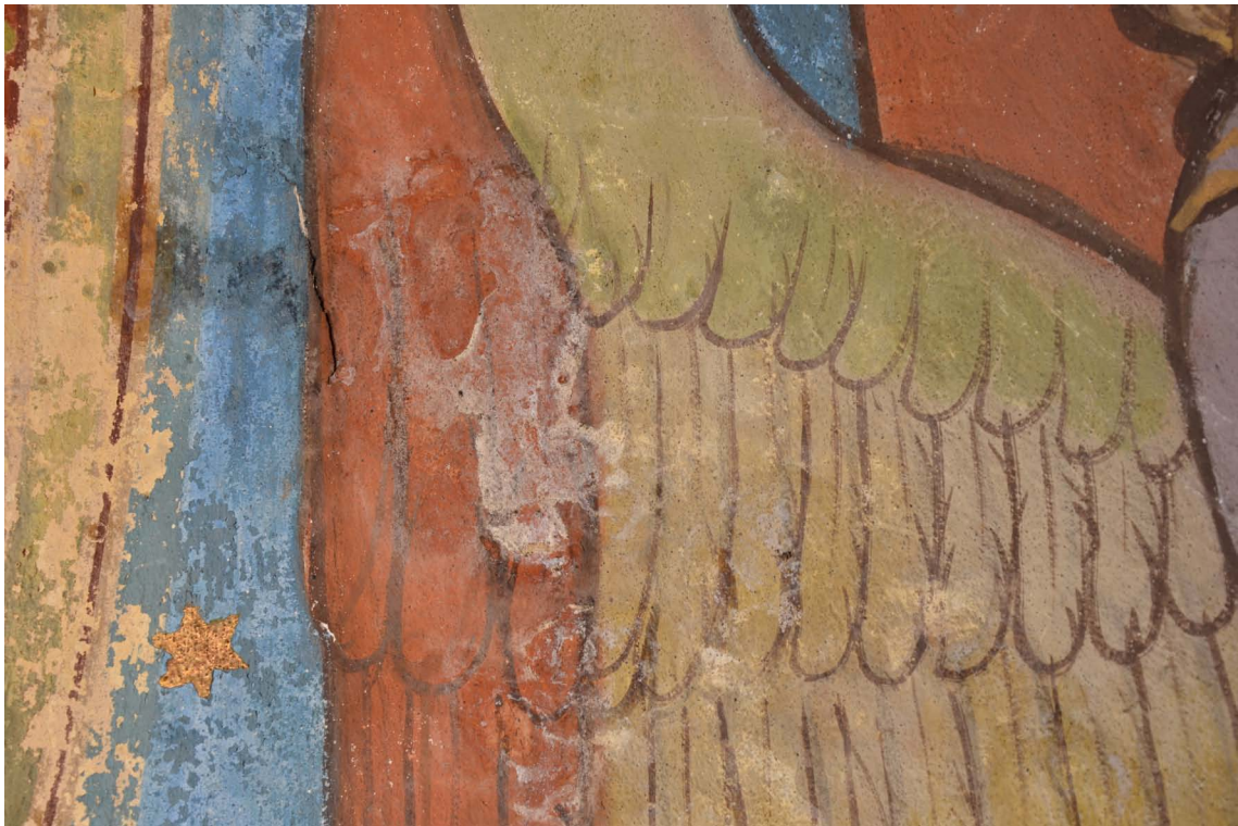
100. Detail bílého povlaku - výkvětu solí na křídle anděla. Stav před restaurováním.
