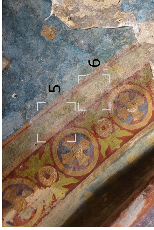
81. Místo zkoušky stabilizace síranu vápenatého nanosuspenzí hydroxidu barnatého. Po aplikaci. U obou zkoušek je pozorovatelný bílý povlak mírně přesahující hranice zkoušky.
