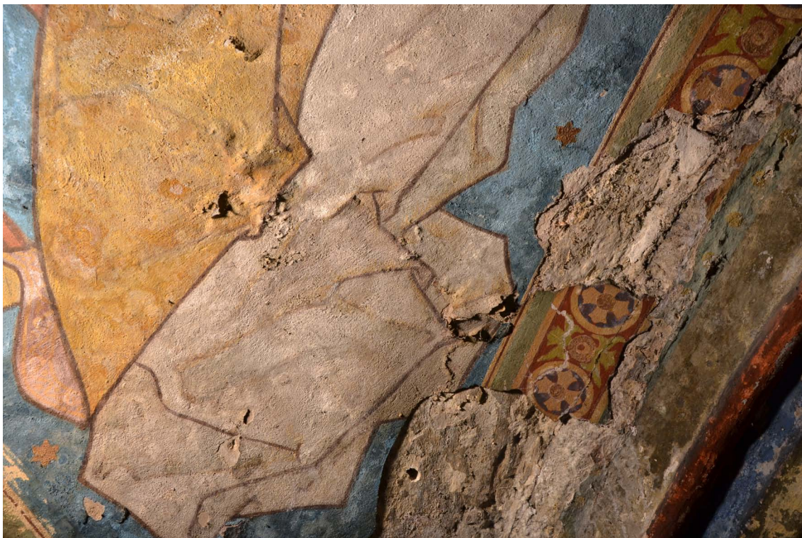
86. Detail uvolněných omítkových vrstev v levé části výjevu. Stav před restaurováním. Foto v bočním světle.
