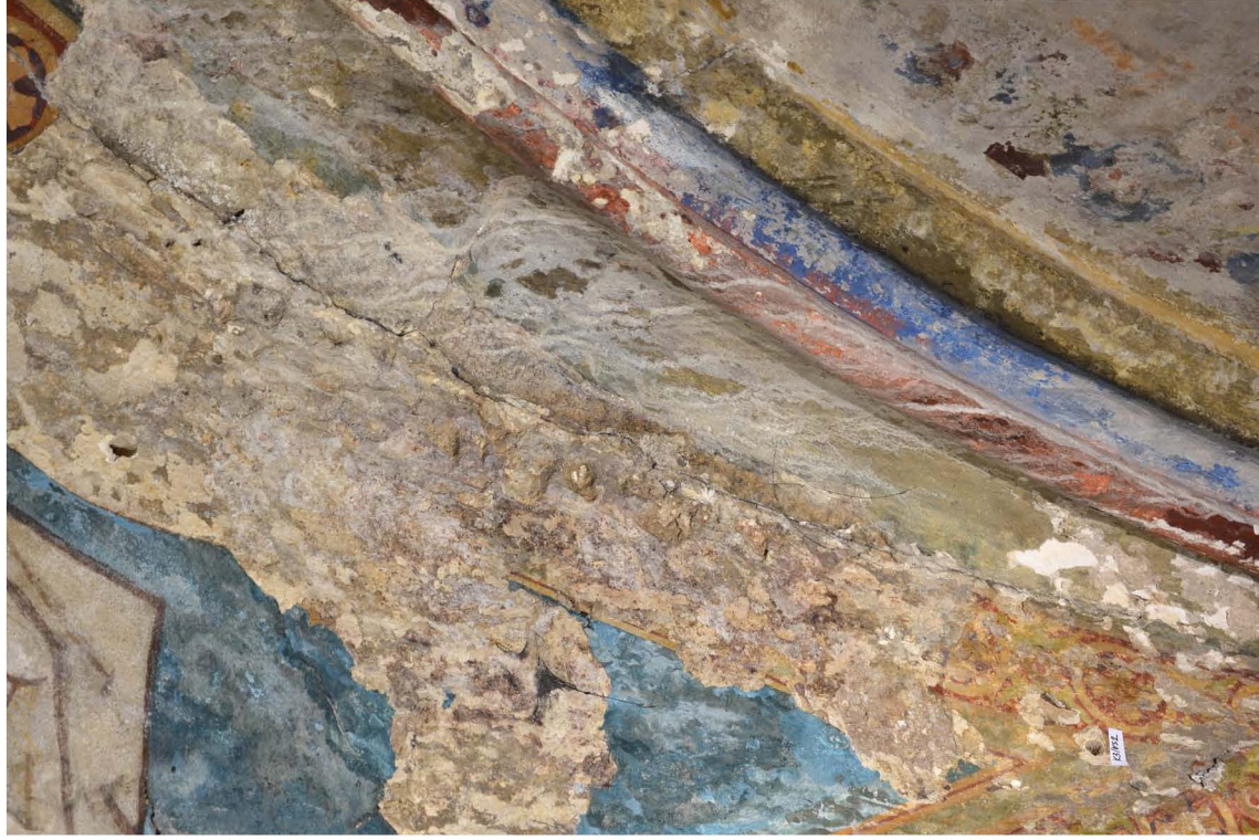
102. Detail vápenného povlaku pod defektem omítkových vrstev. Stav před restaurováním.
