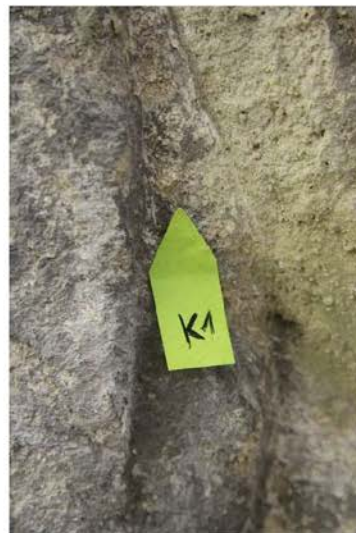
Obr. 33 Místo odběru vzorku 6943 (K1), štít pod levým křídlem, detail.
