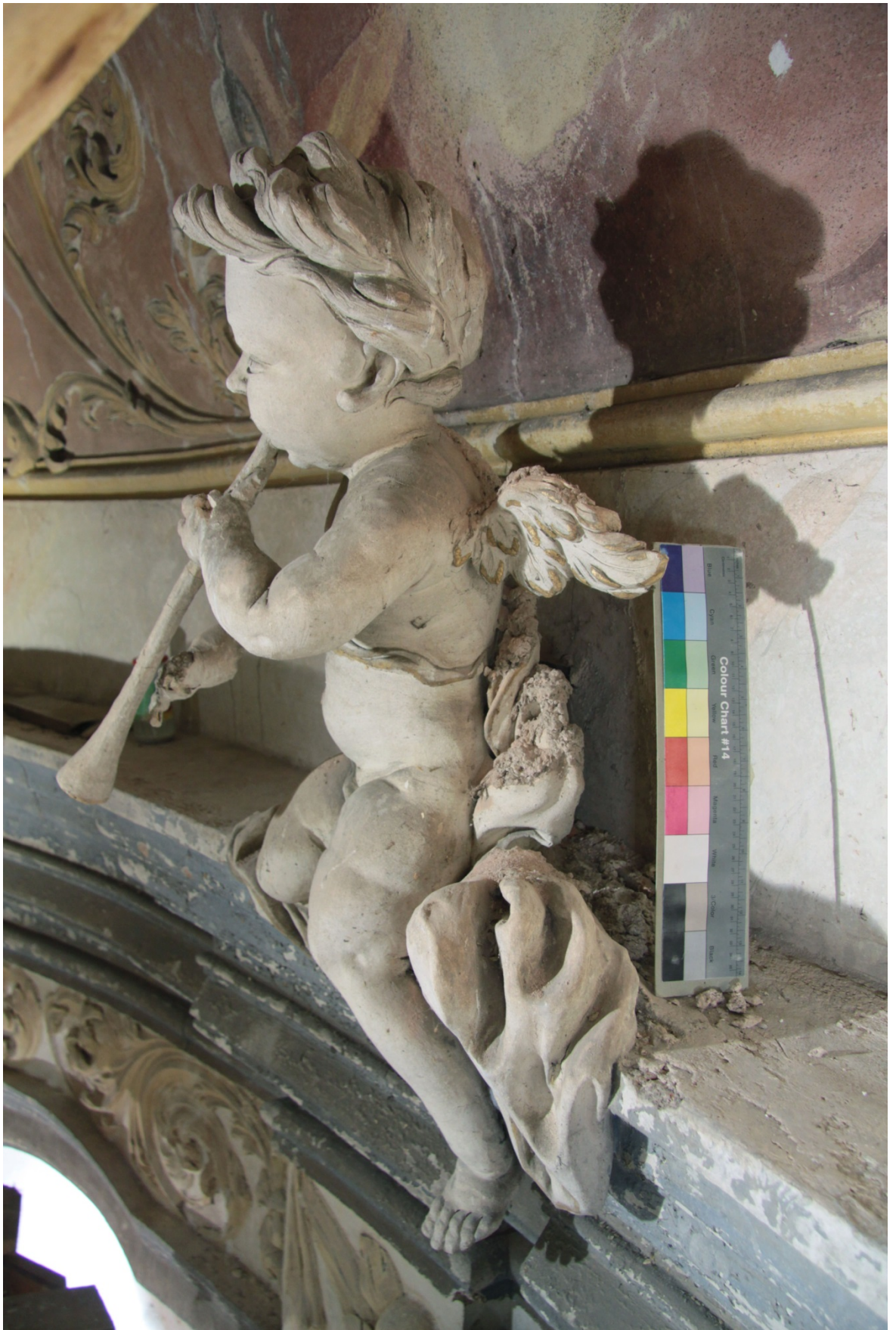
Obr. č. 95 - Stav před restaurováním, pohled zprava
