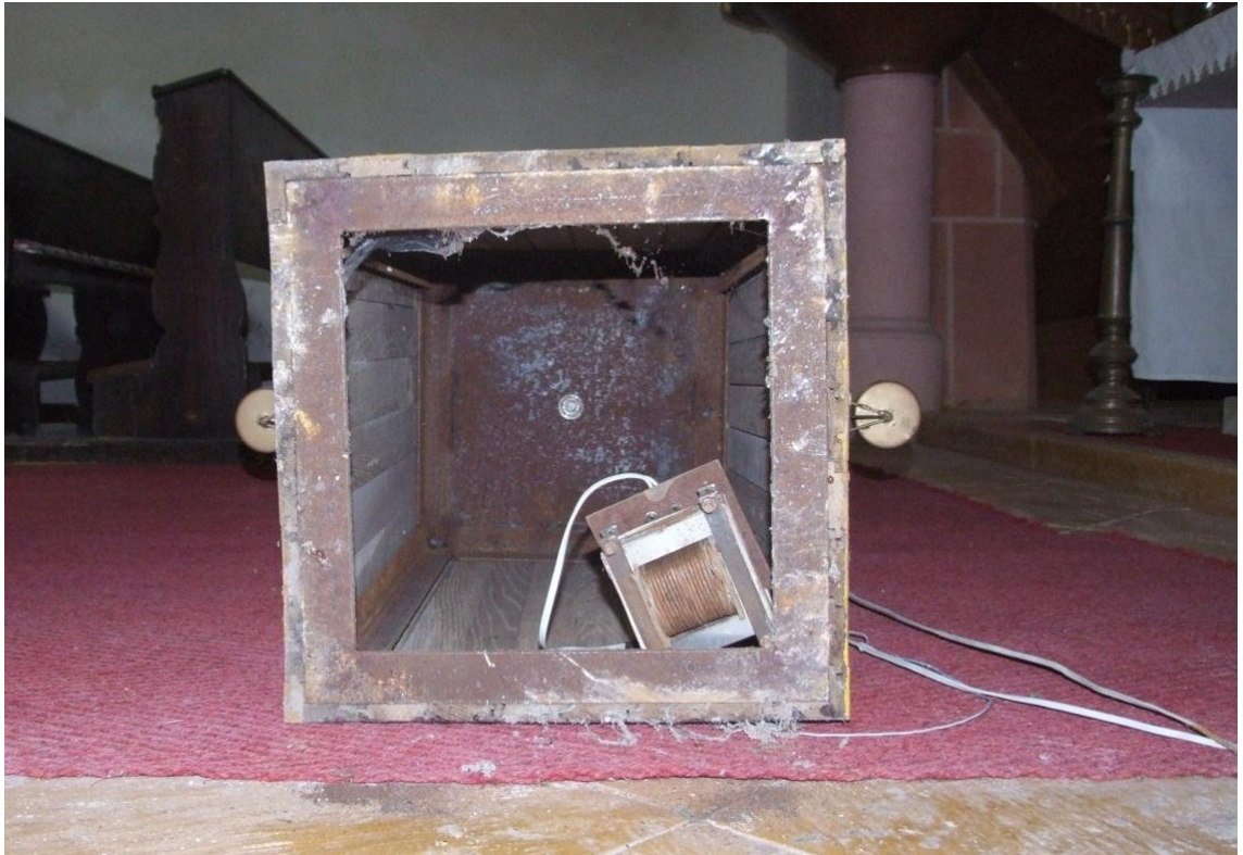
Obr. 99 Pohled ze spodu, trafo k napájení svatozáře uvnitř
