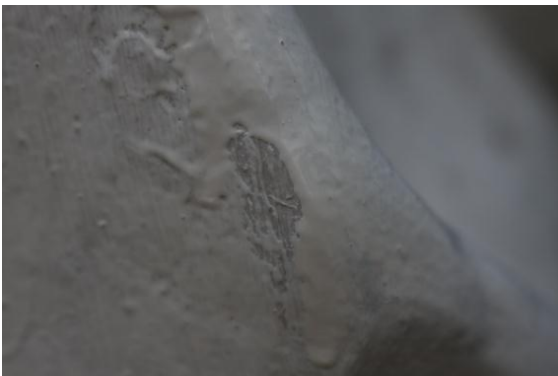
Obr. 94 Ukázka diletantsky nanesené nepřiměřeně silné poslední povrchové úpravy
