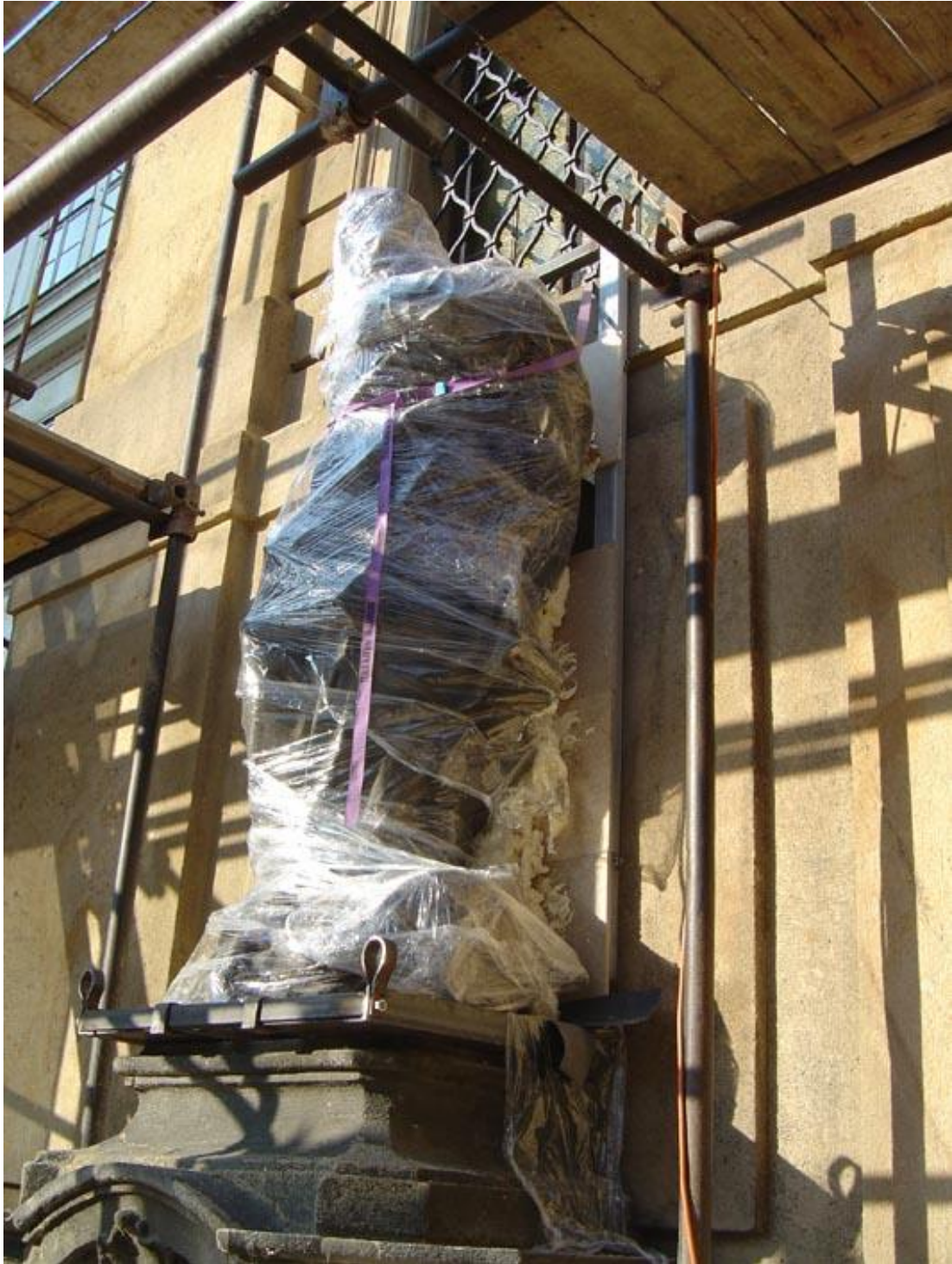
Obr. 48 Ukázka železné konstrukce pro demontáž a přepravu sochy se silně poškozenou základnou (Foto Petr Cír)
