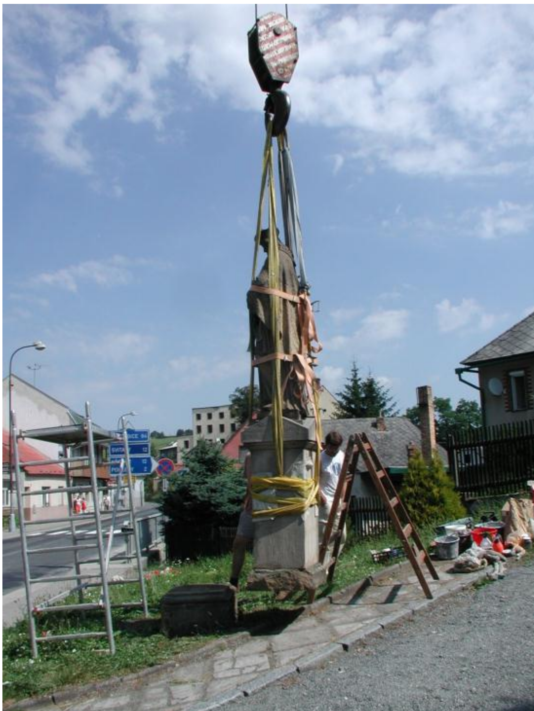
Obr. 55 Uvázání podstavce a figury Jana Nepomuckého, za účelem navrácení posunutí v ložné spáře
