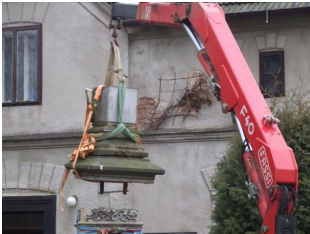
Obr. 56 Zvedání částí podstavce z kříže Benátky u Litomyše, díky předběžnému spojení dvou částí kurtou se zabránilo pádu dodatečně uvolněné spodní části. Obnažené, silně korodované kovové čepy zalité na síru. Vrchní část opláštěná kovovou obručí (Foto Archív Autora)
