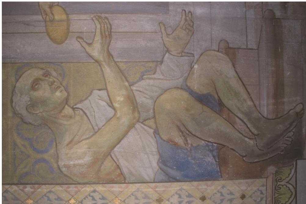
obr. 30: Pohled na postavu chudáka. Na snímku jsou patrná četná poškození malby, jako jsou zatekliny, opadaná barevná vrstva, mechanické poškození v podobě drobných vrypů (pravé koleno postavy), zbytky injekční směsi, prachové depozity.
