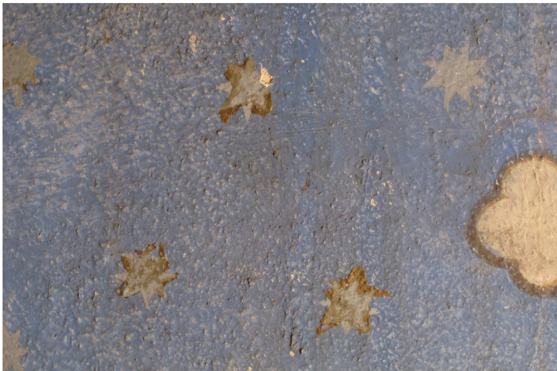
obr. 32: Detail hvězdného nebe s částí kříže z iluzivní architektury. Na modrém nebi byly původně zlaté pěticípé hvězdy, které při pozdější úpravě byly přemalovány bílou barvou přes šablonu na osmicípé hvězdy. Na snímku jsou také patrné místa, kde zatékala voda a prachové depozity usazené na povrchu malby.
