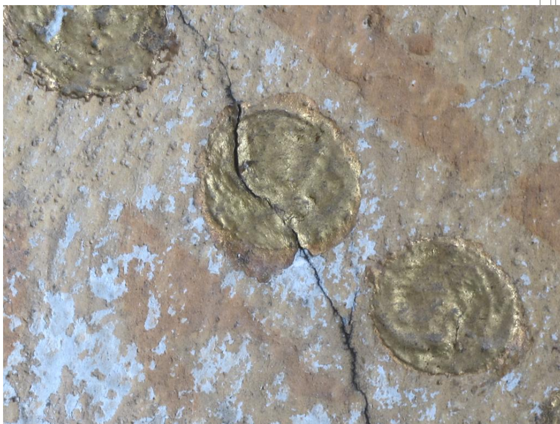
obr. 22: Na detailu malby je znatelná oprava zlacení nátěrem, opadaná barevná vrstva a drobné praskliny v omítce.
