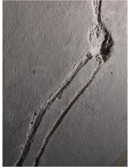
obr. 48: Detail v bočním nasvícení, ve kterém je viditelná nadbytečná injektážní směs přesahující nad originální povrch.
