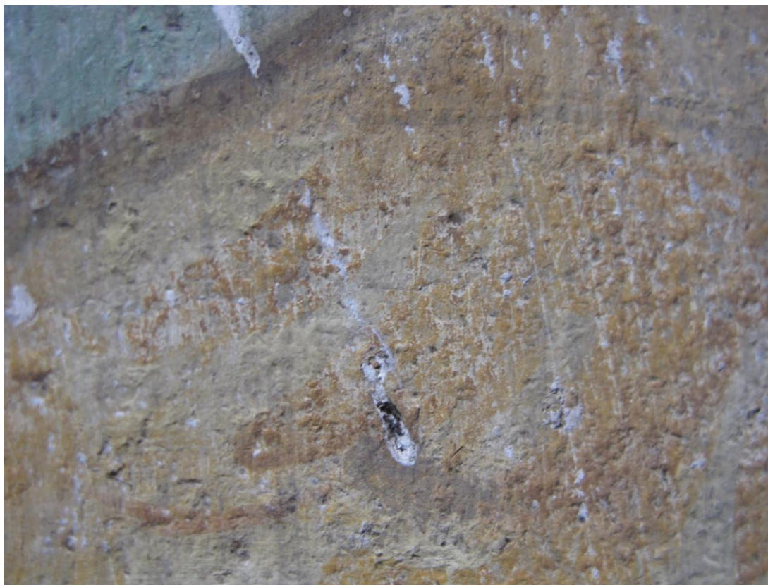
obr. 19: Na tomto detailu malby jsou mimo znečištění prachovými depozity dobře zratelná místa s mechanickým poškozením a biologickými nečistotami.
