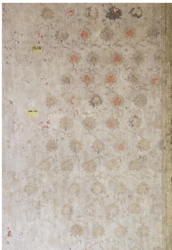
obr. 105: Detail malovaného dekoru se zkouškami rekonstrukce. Ve vrchní části obrázku je provedena lazurní rekonstrukce i s detaily červených a černých kvítků, ve spodní polovině je rekonstrukce provedená pouze lazurní formou aquasporky v základních obrysech rostlinného motivu, která byla následně provedena v celé místnosti.
