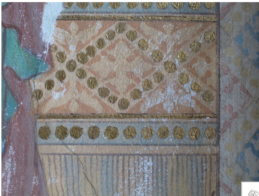
obr. 51: Detail malby, stav po tmelení.
