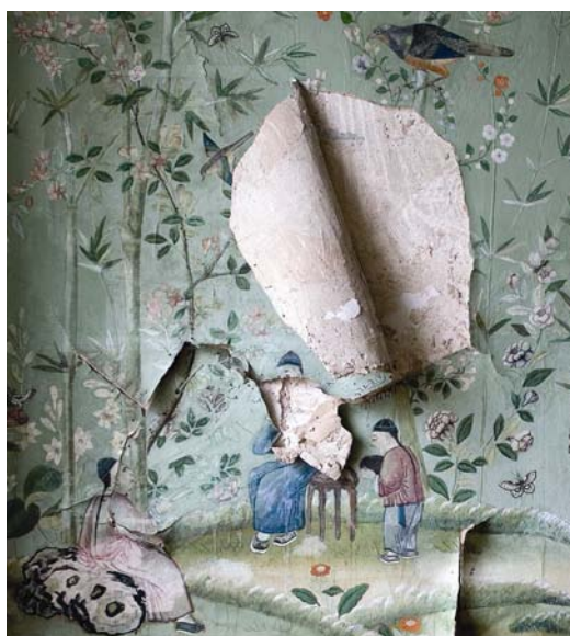
Obr. 14 Poškození tapety v místě, kde se nacházela kamna
