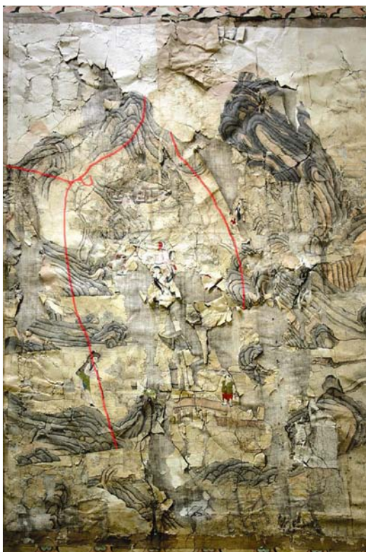
Obr. 54 Vyznačení trhlin, které jsou podlepeny silným papírem
