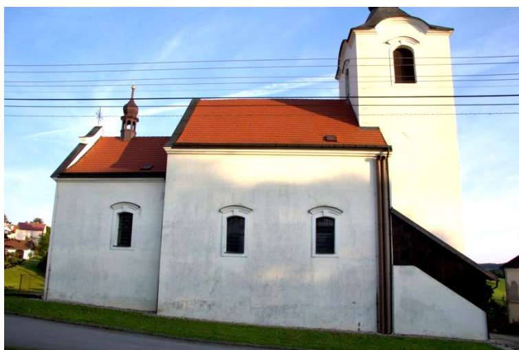
Obr. 21. Severní fasáda kostela sv. Bartoloměje v Pošné po opravě v r. 1991. Nové omítky z cementového betonu se v partiích u terénu nejeví zcela v pořádku, problémy se zavlhčením objektu nejsou vyřešené.
