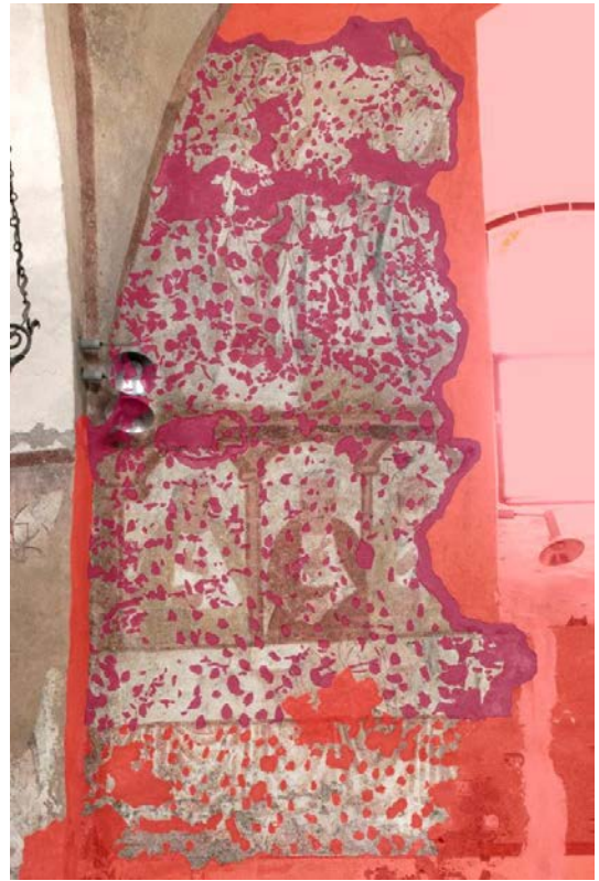
Obr. 140. Levá část severní stěny presbytáře – grafický zákres odstraněných a ponechaných nepůvodních vrstev a tmelů.
