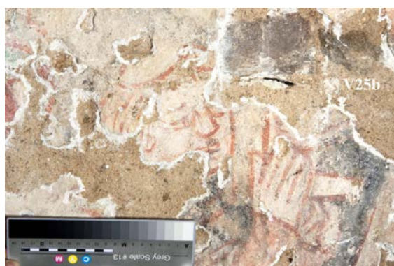
Obr. 104. Vz. V25b – středověká omítka odebraná z defektů.
