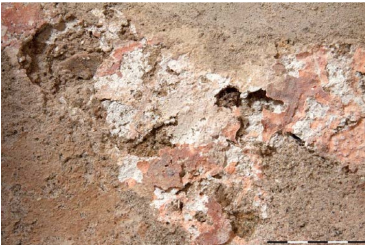
Obr. 32. Detail drapérie stolu – před konsolidací. Destruovány jsou veškeré středověké omítkové, nátěrové a barevné vrstvy a narušeny jsou také tmely z r. 1956.
