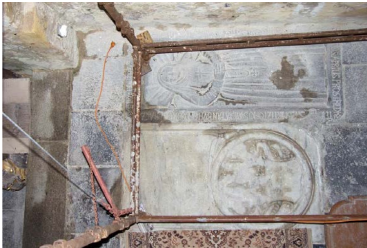
Obr. 24. Část podlahy při západní části severní stěny s hrobkami pod kamennou podlahou. Je patrné silné zavlhčení kamenné podlahy, projevující se tmavými vlhkými skvrnami.
