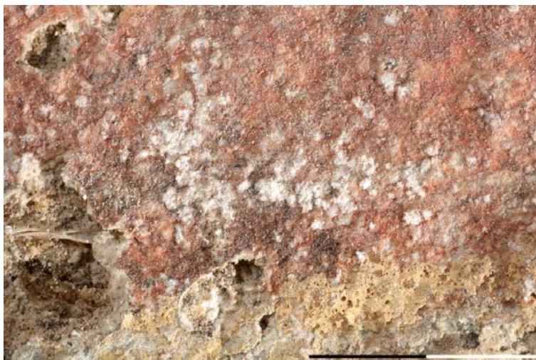
Obr. 33. Detail draperie stolu – před konsolidací. Ke krystalizaci (vzniku bílých krystalů) dochází na povrchu (eflorescence) i pod povrchem ve hmotě materiálu (subflorescence).
