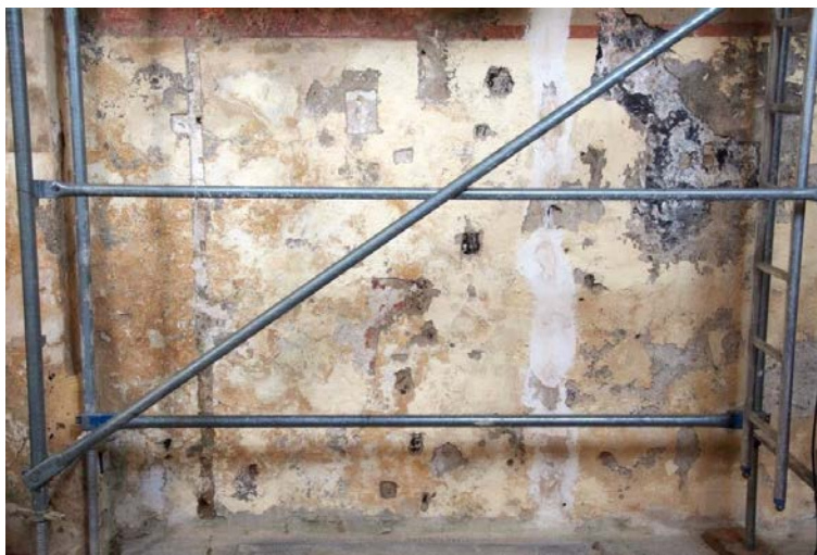
Obr. 25. Přízemní partie západní části severní stěny. Středověké vrstvy jsou do výšky 2–3 m od podlahy překryty asfaltovým nátěrem a novodobými omítkami a nátěry, zabraňujícími odparu vlhkosti.
