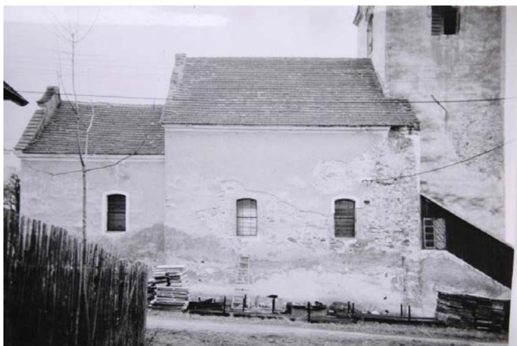
Obr. 22. Severní fasáda před opravou v r. 1991. Poškození spodních partií omítek je typické pro vztlínající vlhkost a zasolení. Patrné je také zavlhčení vlivem nedostatečně funkčních okapních svodů. Obr. převzat viz. Archiv farnosti Pošná 59 a upraven.
