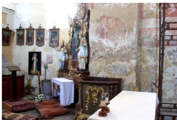
Obr. 23. Severní stěna lodi, vítězného oblouku a presbytáře v interiéru. Spodní partie stěn jsou destruované vlivem zvýšené vlhkosti, biodegradace a zasolení. Mobiliiář kostela v kontaktu se stěnami a podlahou zadržuje vlhkost a vytváří nežádoucí mikroklima.
