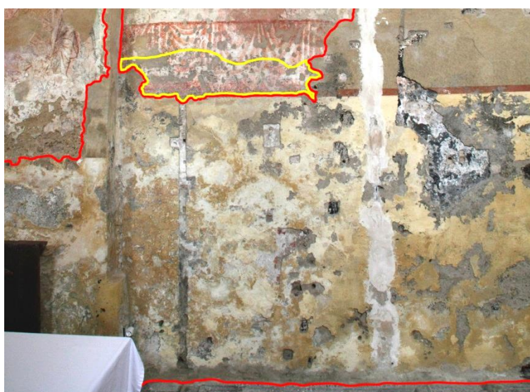
Obr. 29. Přízemní partie levé části severní stěny. Červeně jsou ohraničeny nepůvodní překryvné vrstvy. Žlutě je ohraničena oblast rekrystalizace vodorozpustných solí v dolní části drapérie stolu odkrytých středověkých maleb.
