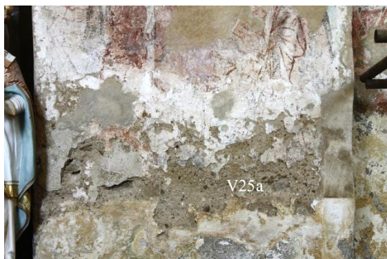
Obr. 112. Vz. V25a – středověká omítka, defekt na severní straně pohledu vítězného oblouku.
