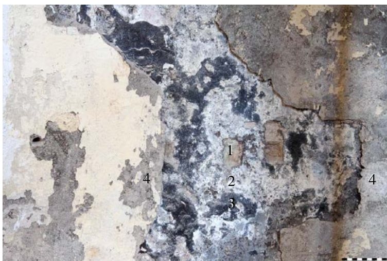
Obr. 26. Detail přízemních partií. V sondě z předchozího průzkumu vidíme středověkou omítku s fragmenty nástěnné malby (1) překrytou mladšími vápennými nátěry (2), na kterých je proveden asfaltový nátěr (3) a novodobé omítkové a nátěrové vrstvy (4).
