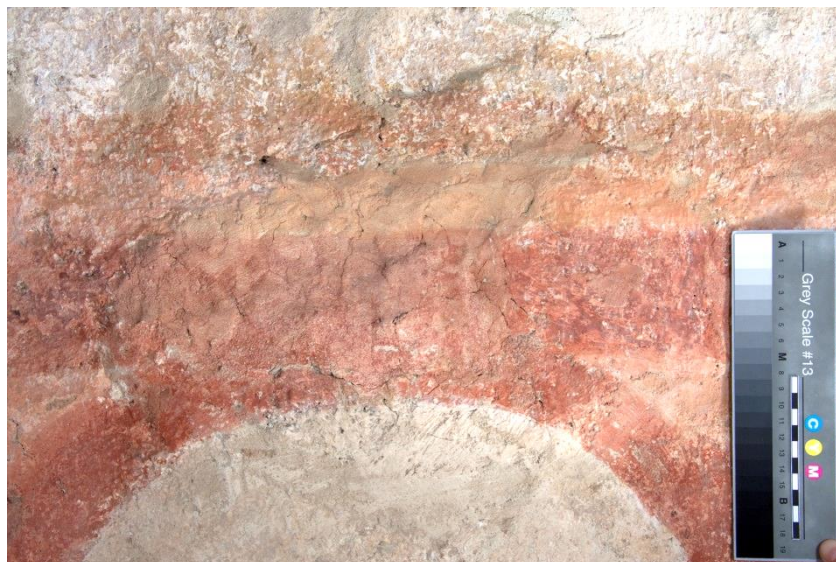
Obr. 35. Detail arkády s novodobým tmelem – před restaurováním.
