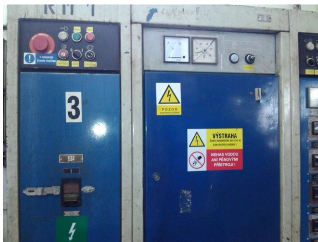
Obrázek 3: Rozvaděč s tlačítkem nouzového vypnutí
