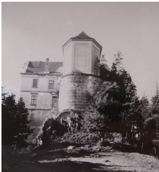
Obr.2/V Pohled na sesutý svah pod kaplí (foto dle SHP, 1966)
