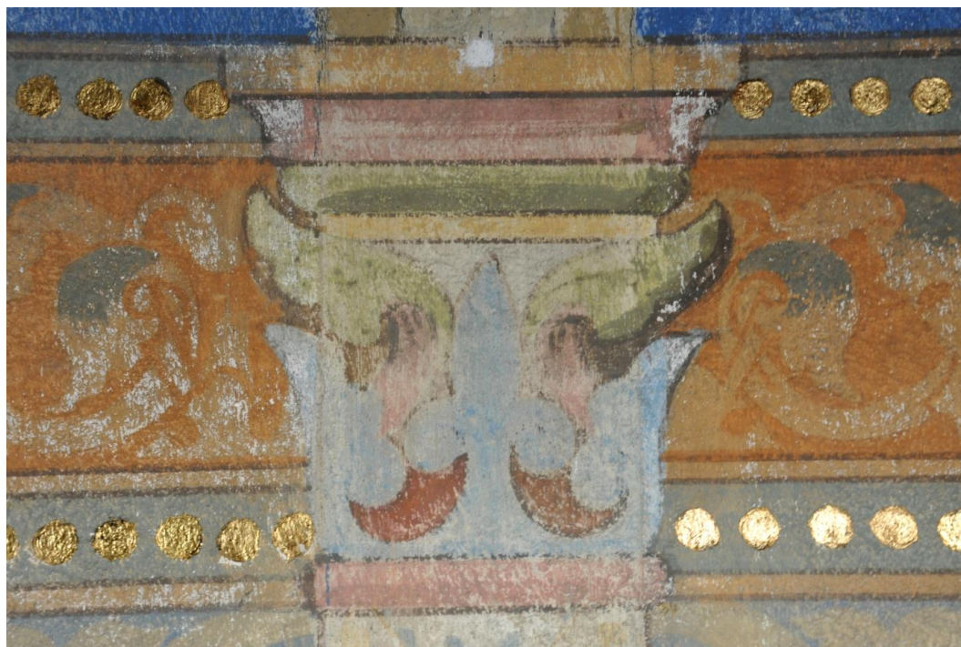
Obr. 63 Detail poškození barevné vrstvy v dekoru a v hlavici středového sloupu, v horní části viditelný tmel.
