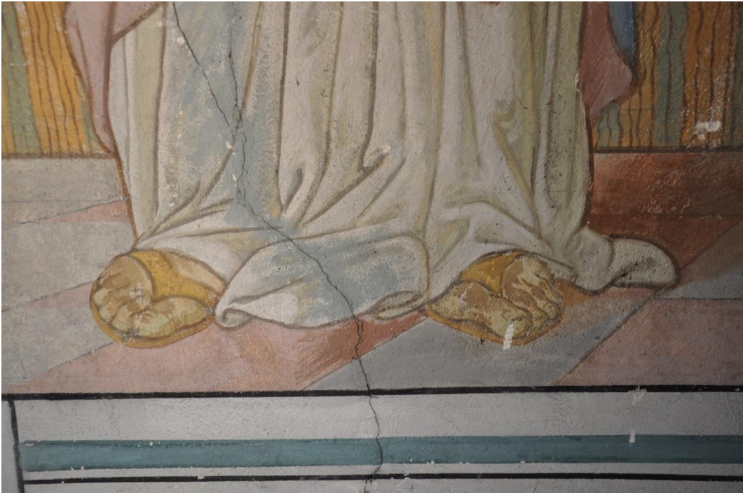
Obr. 38 Nohy a dolní část drapérie sv. Josefa, trhlina, druhotná přemalba drapérie a stínů na prstech nohou v denním světle, stav před restaurováním.
