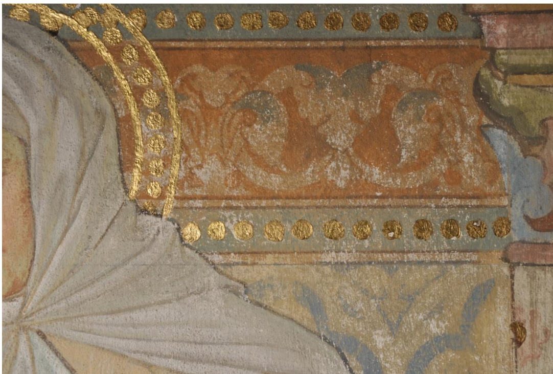
Obr. 59 Detail části malby s poškozeným šablonovým dekorem pozadí.
