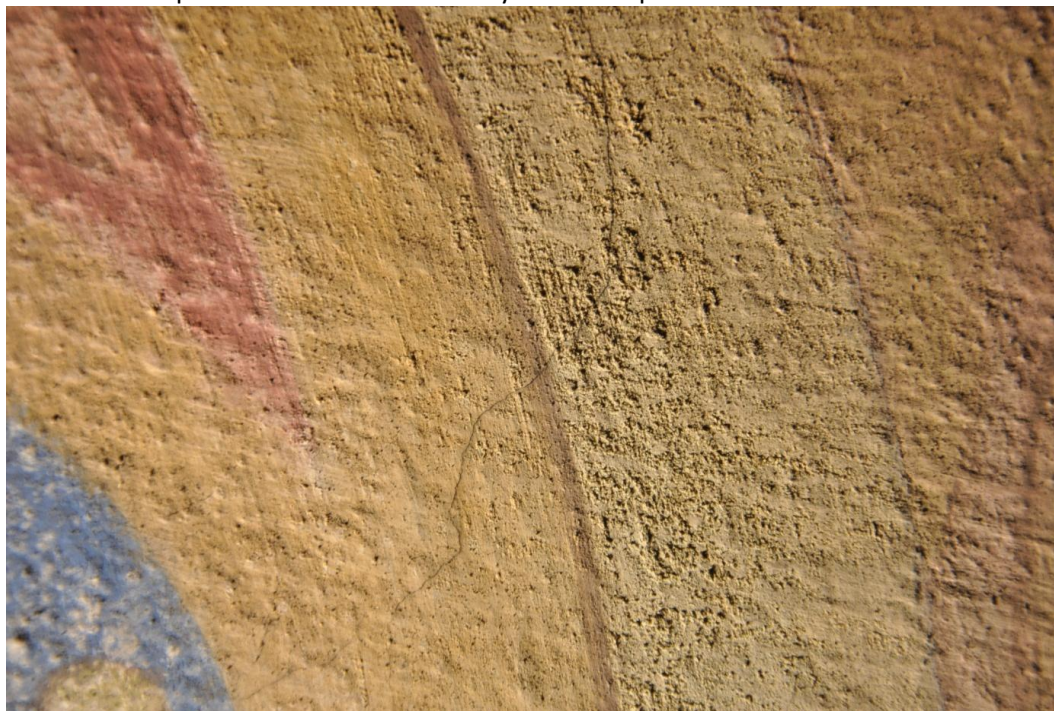
Obr. 48 Detail práškovatění barevné vrstvy okrového pásku horního oblouku.
