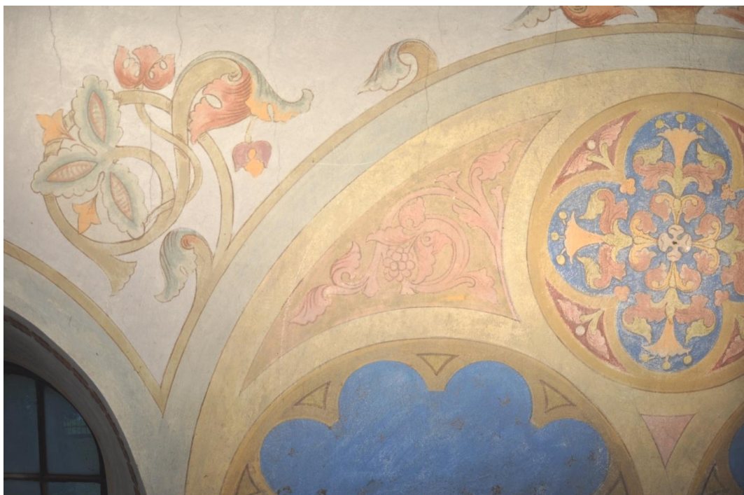
Obr. 11 Levá část archivolty nad světcí, stav před restaurováním.
