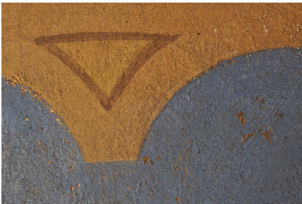
Obr. 44 Detail zlacených hvězdiček v modrém oblouku nad světci poškozených ztrátou adheze k podkladu.
