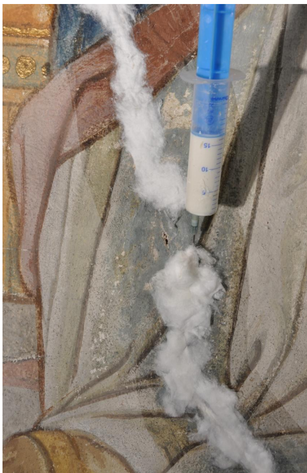
Obr. 54 Průběh prací, aplikace konsolidačního prostředku Ledan B1 pomocí injekční stříkačky do dutin v místech trhliny.
