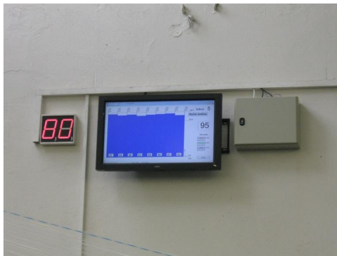
Obrázek č. 19 - Výkonové tabule
