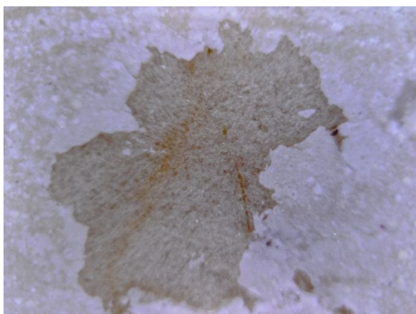
Detail odpadlé části
