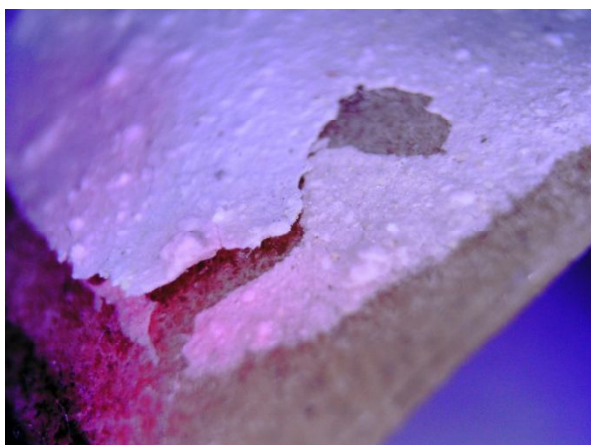
Další detail poškození
