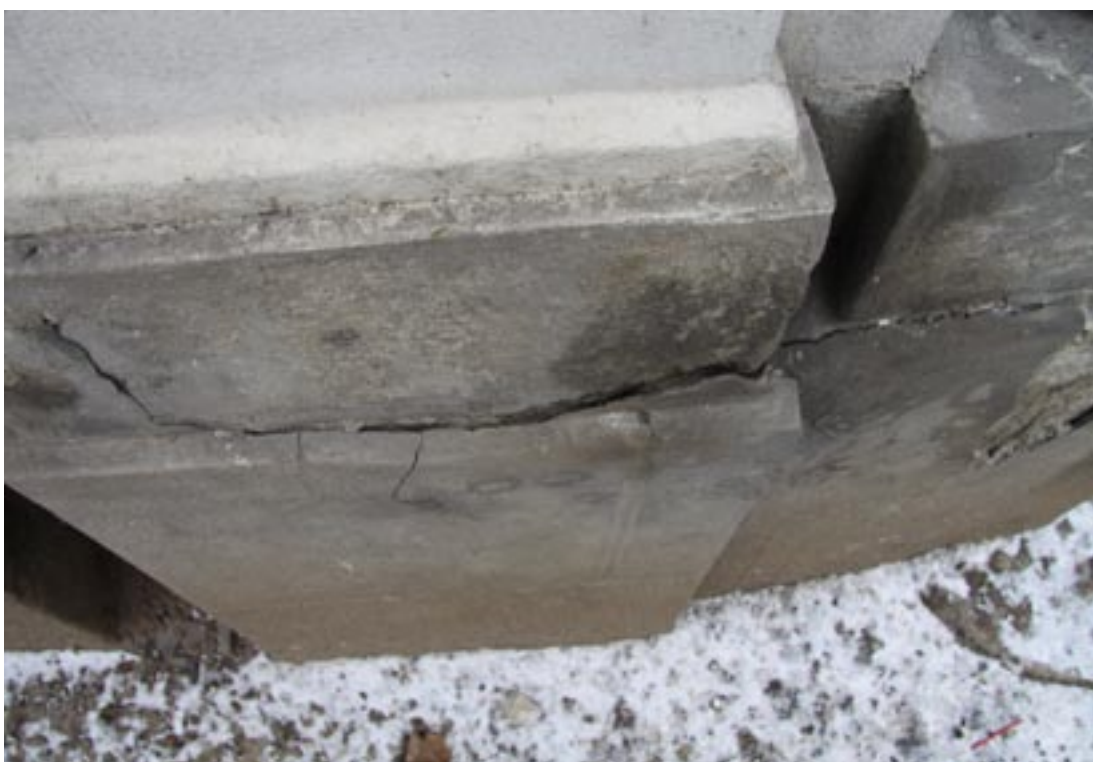
Obr. 111. Detail staré nesoudržné plastické vysprávky
