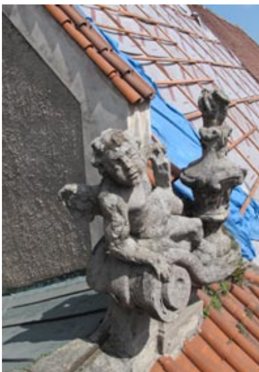
Obr. 46. Andílek pravý- před restaurováním- boční pohled
