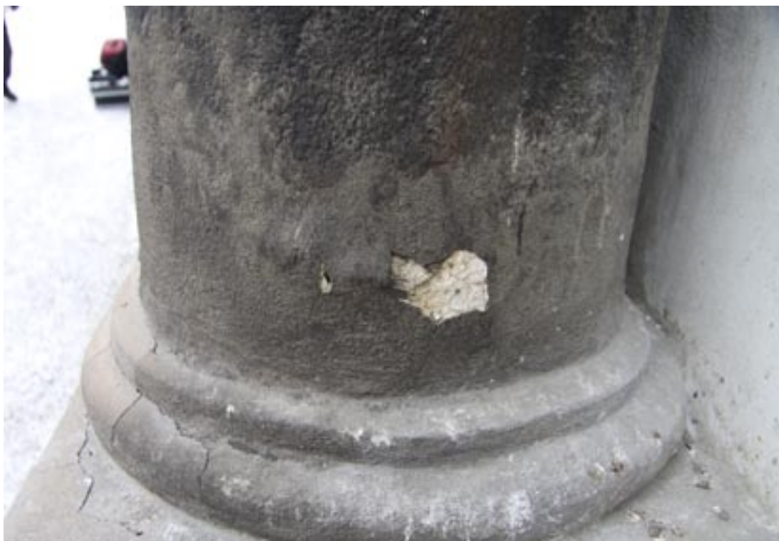
Obr. 112. Detaily starých nesoudržných plastických vysprávek, černých krust a nečistot na patce sloupu
