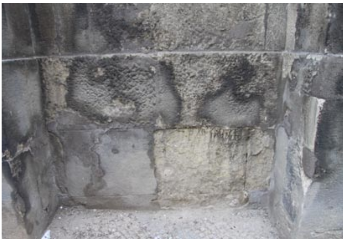
Obr. 103. Sokl- pravá strana- detaily starých plastických vysprávek, černých krust, nečistot a silně zdegradovaných ploch
