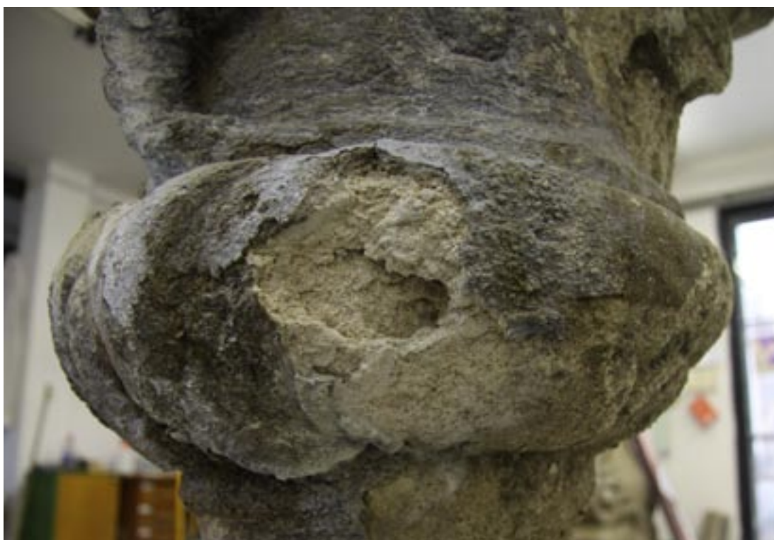
Obr. 93. Váza levá- před restaurováním- detail silně zdegradovaného partu
