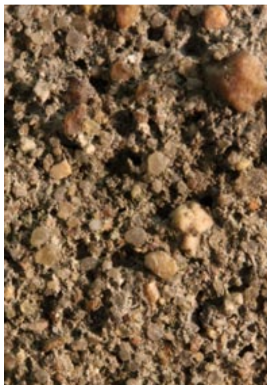
Obr. 5. Detail povrchu starého tmelu
