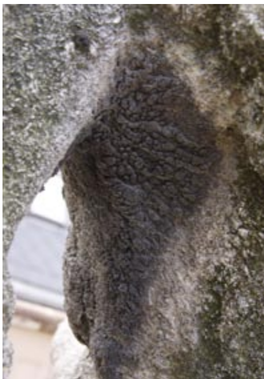
Obr. 50. Andílek levý- před restaurováním- detail černé krusty- podpaždí
