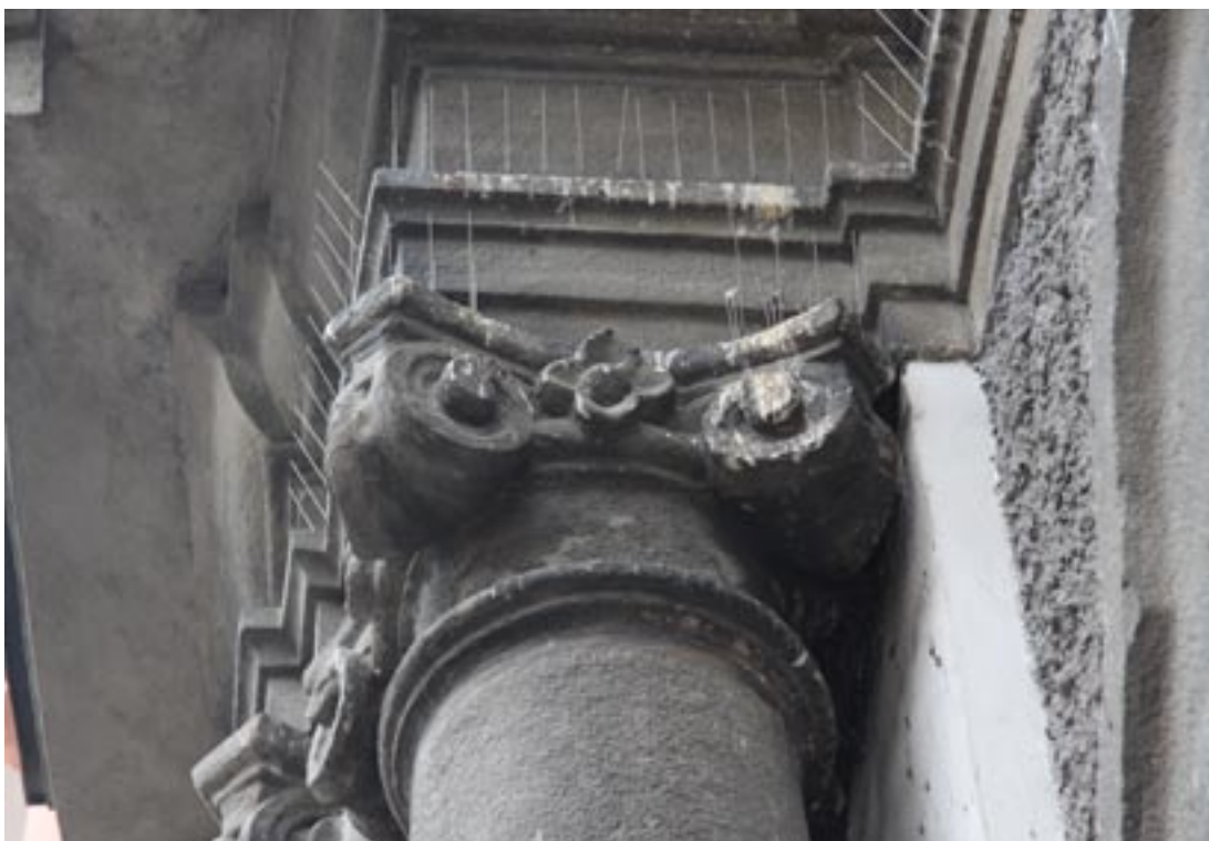
Obr. 102. Hlavice sloupu- detail holubích exkrementů
