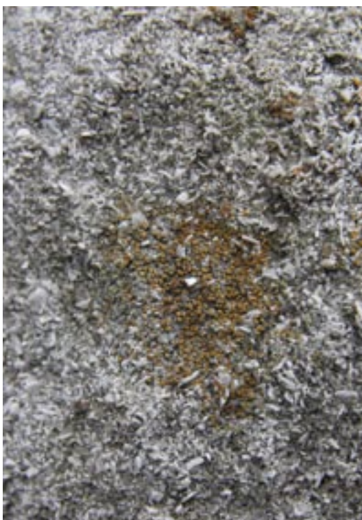
Obr. 52. Andílek levý- před restaurováním- detail biologického povlaku
