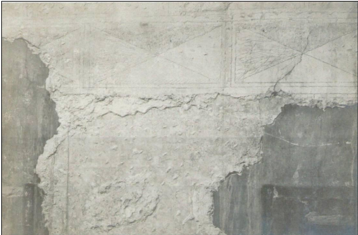
Obr. 43. Tyršův dům, sgrafitová fasáda po odkryvu, 1922 – 1924, reprofoto autor
