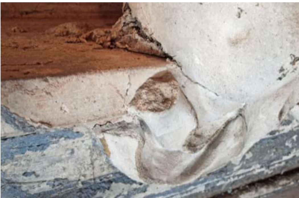
Obr.23. Plastika anděla K 1.41., detail poškozené draperie u pravého kolene. Průzkum vlivu použité techniky provedení plastiky na praskání a oddělování štukových vrstev - modelace draperie nanesená na hladký natřený povrch římsy. Stav před restaurováním.
