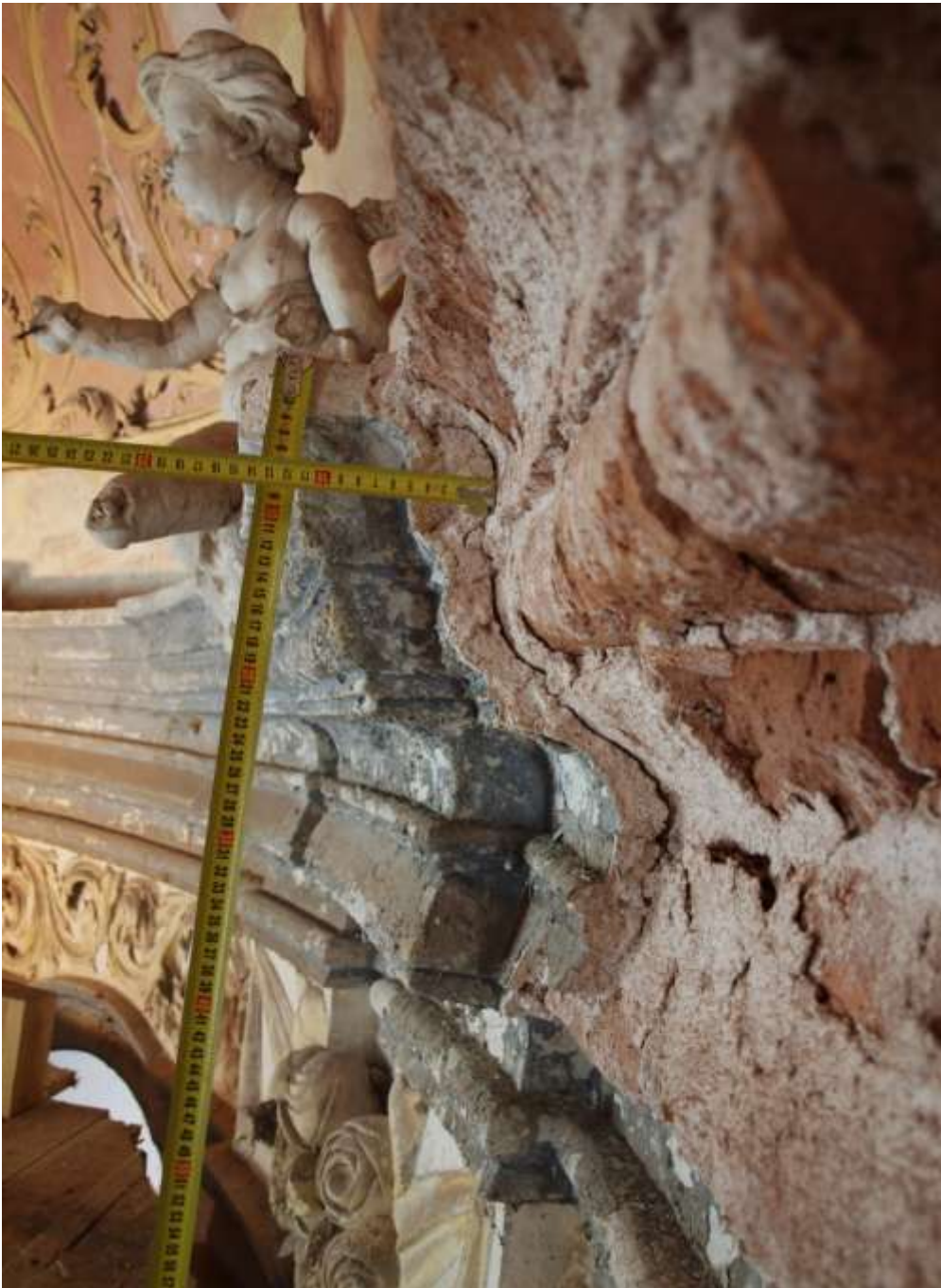
Obr.44. Římsa napravo od anděla K 1.41., boční pohled s přiloženými metry. Poškození: oddělující se vrstva omítky od zdiva. Stav před restaurováním.
