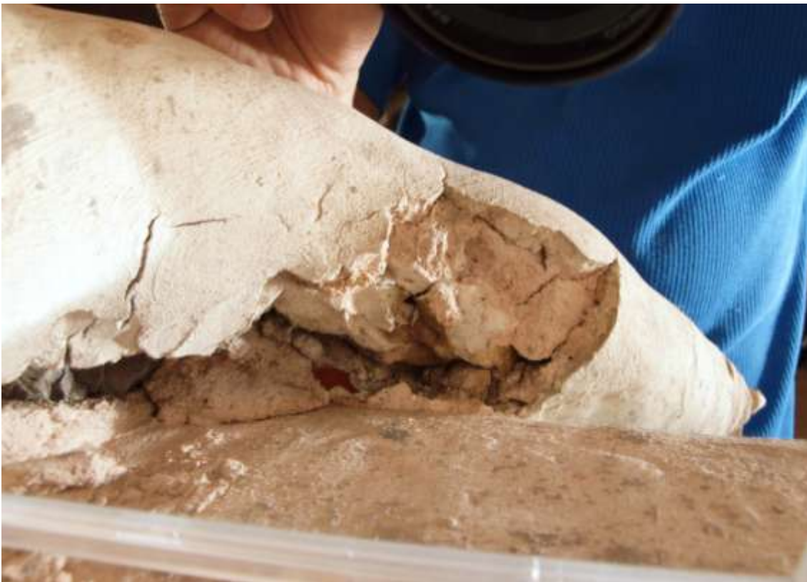
Obr.52. Levá noha, zadní strana - sejmutá uvolněná štuková vrstva, detail lomové plochy v odrazu zrcadla. Průběh prací.
