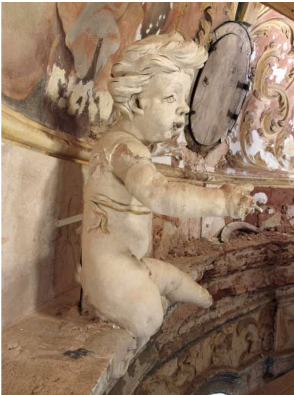
Obr.63. Plastika anděla K 1.41., pravá strana. Stav po inžektáži a očištění. (* Draperie vlevo: doplnění chybějící části v jádrovém štuku.)
