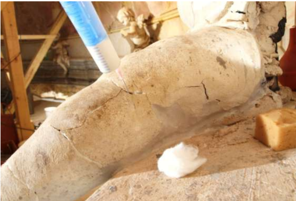
Obr.56. Levá noha, zadní strana, uvolněná štuková vrstva, stav po podtmelení uvolněných štukových vrstev - injektáž bodově lepeného spoje. Průběh prací.
