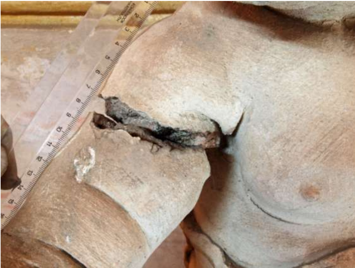
Obr.32. Plastika anděla K 1.41., detail trhliny v pravé paži. Stav před restaurováním.
