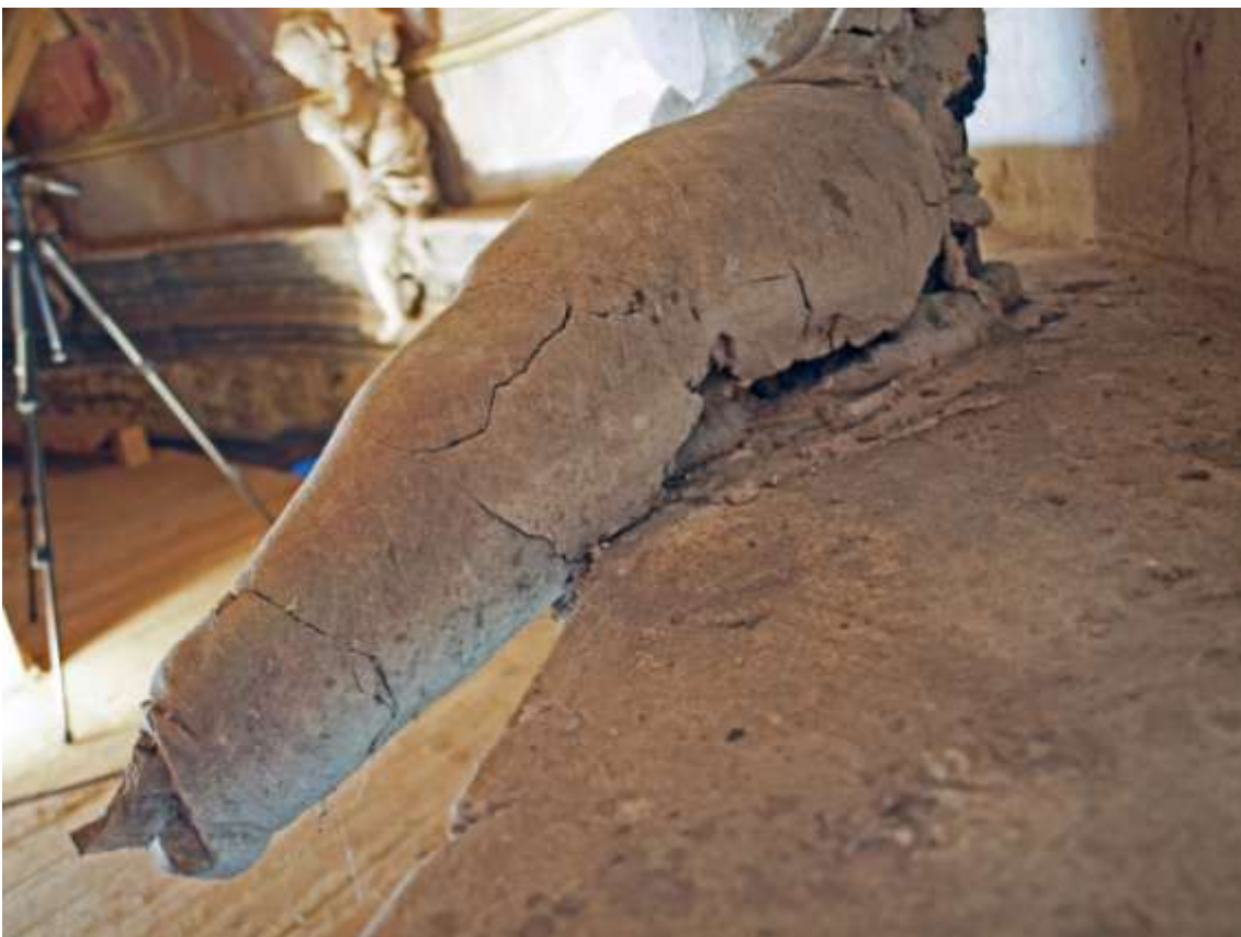
Obr.41. Plastika anděla K 1.41., levá noha - boční pohled zleva. Poškození: chybějící část chodidla, trhliny. Stav před restaurováním.
