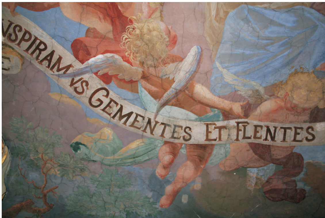
Obr. 7 Andílek ze skupiny kolem Panny Marie - vlasové trhliny, které vznikly při hem vysychání omítek - stav před restaurováním.
