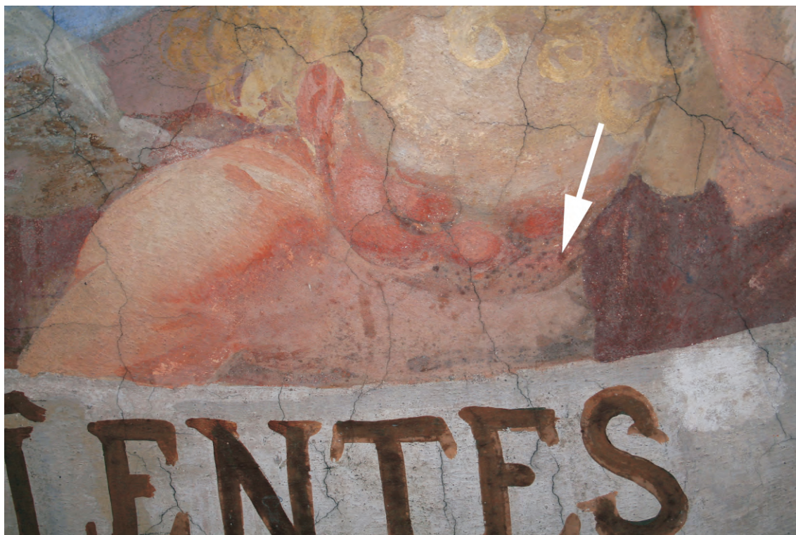
Obr. 44 Biologické napadení vyskytující se v podobě tmavých skvrn na obličeji andělka (výsledky mikrobiologických zkoušek viz. Půloha 10.4. Technologické analýzy, lokalizace viz. Půloha 10.2. Grafická dokumentace).
