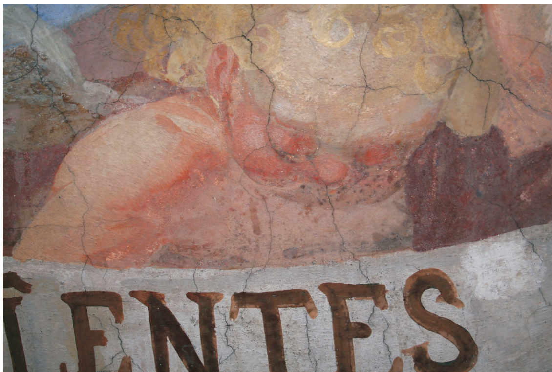
Obr. 6 Andělek podržující nápisovou pásku ve střední části obrazu - detail vlasových trhlin, které vznikly při hem vysychání omítek - stav před restaurováním.
