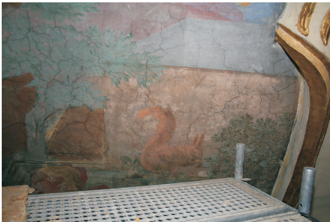
Obr. 8 Malba pozadí nad hlavou ženy podávající Izákovi růže - vlasové trhliny, které vznikly při hem vysychání omítek - stav před restaurováním.
