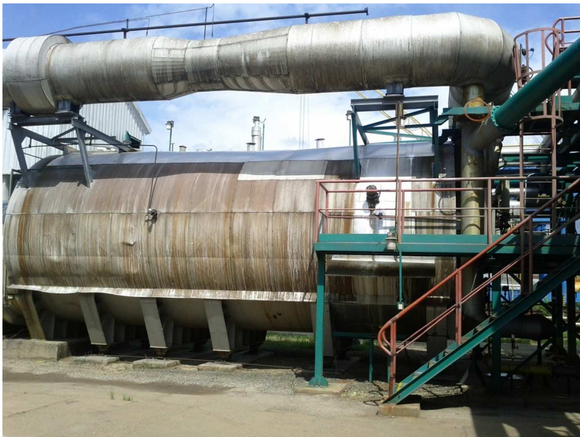
Obr. 4: Spalovací pec na síru
