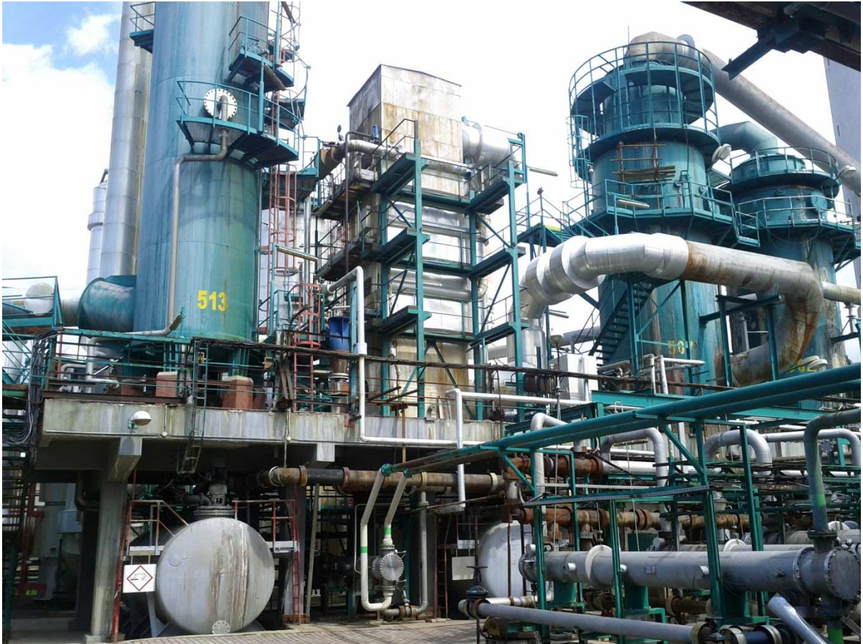
Obr. 6: Absorpční věž (vlevo)
