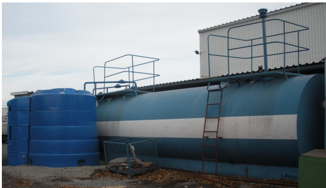
Obrázek č. 6 - Vlastní čerpací stanice
