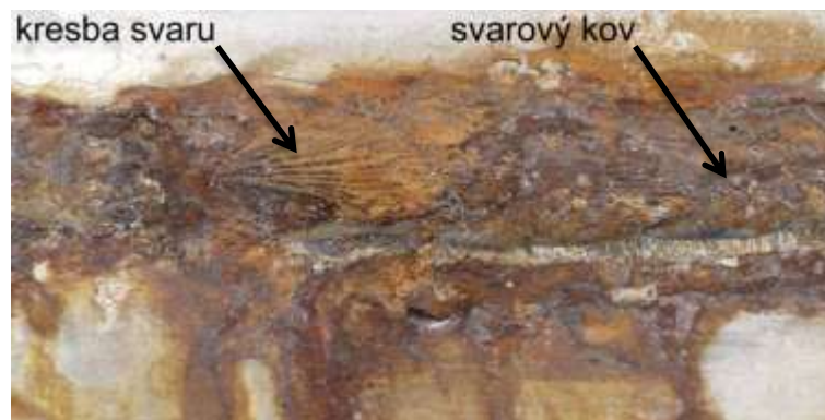
Obr. 20 – Makrosnímek koroze svaru technologií MAG
