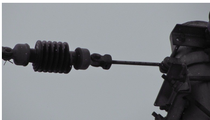
Obr. 4.2- Detail skutečného provedení izolátoru, táhla a objímky PB
