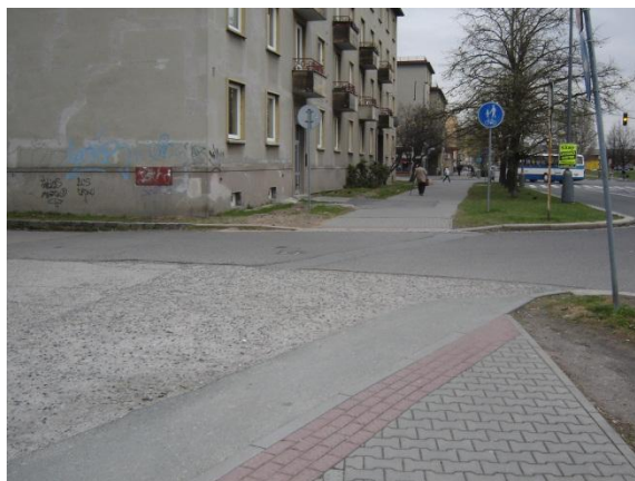
Obr. 27 – Chybějící přechod pro chodce
