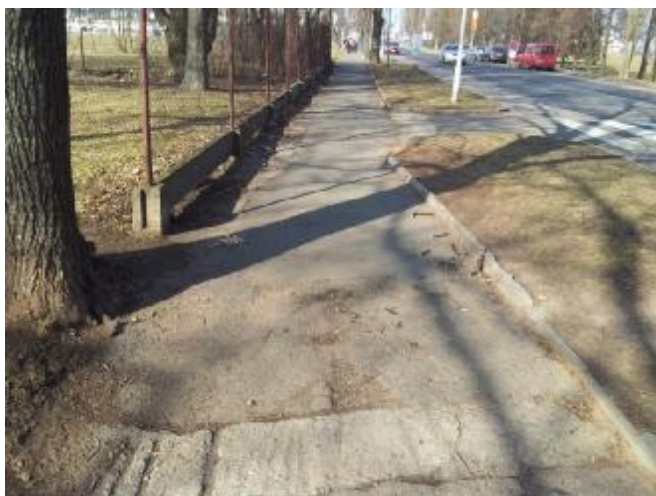
Obrázek 14: Porušený povrch komunikace, ulice Akademika Bedrny
