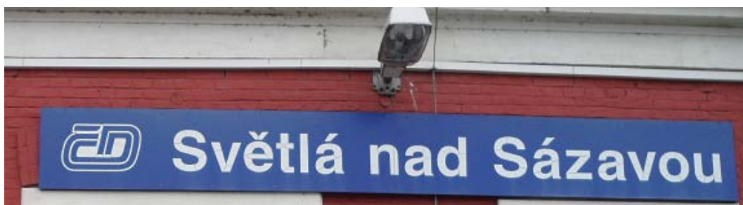
Obrázek 54 - Osvětlení nad vchodem do výpravní budovy [19]
