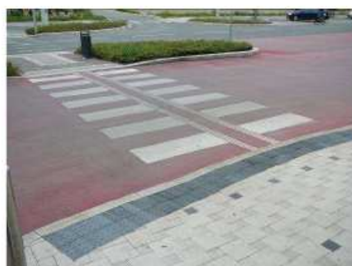
P4.6 Chybějící SP a návaznost na budovu DD.
