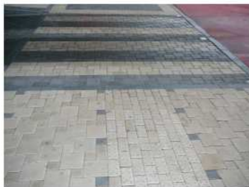
P4.2 Chybějící varovný pás .
