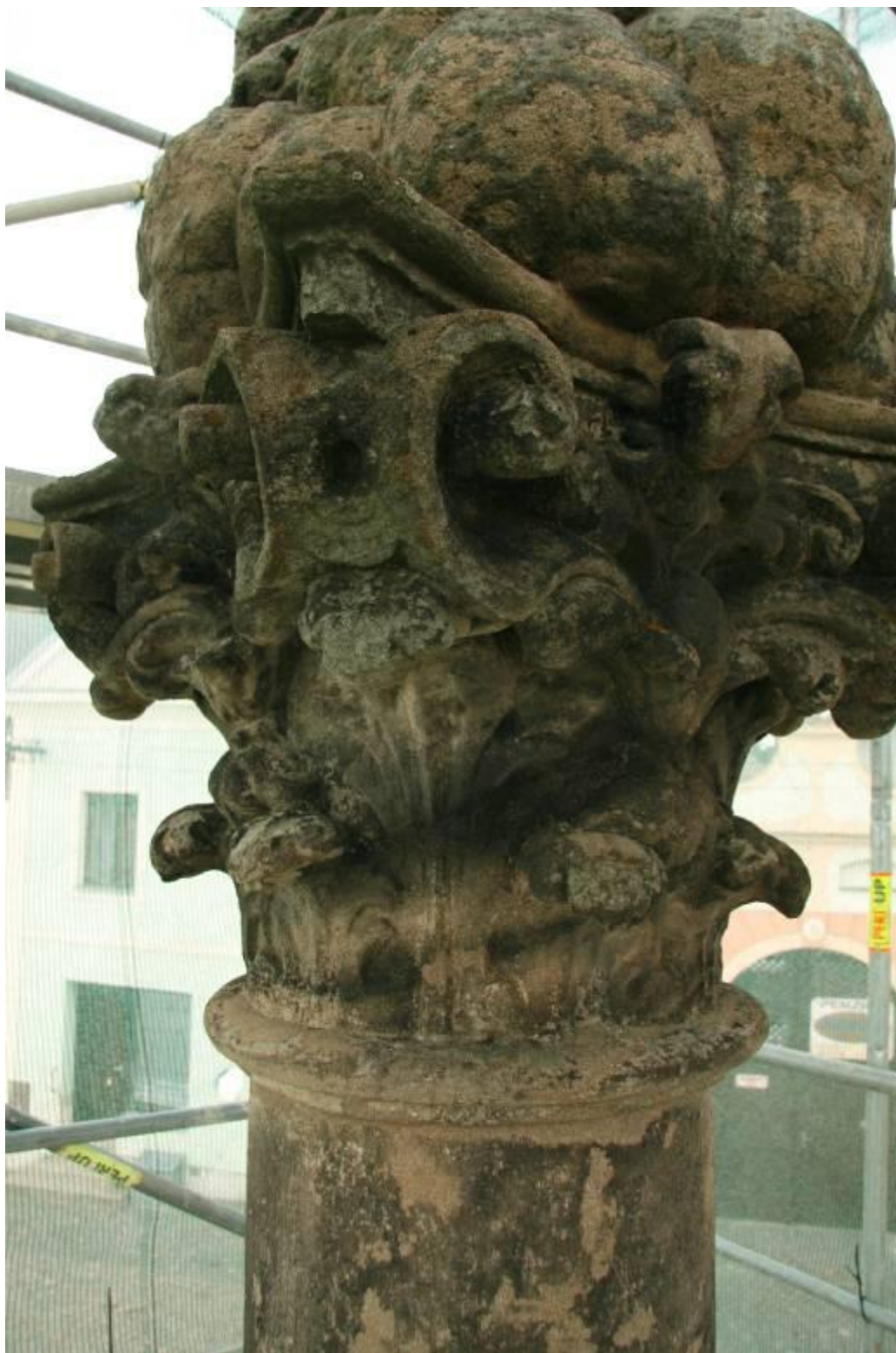
Fotografie č. 17 Detail krust, starých epoxidových tmelů na oblaku, hlavici a dříku sloupu.
