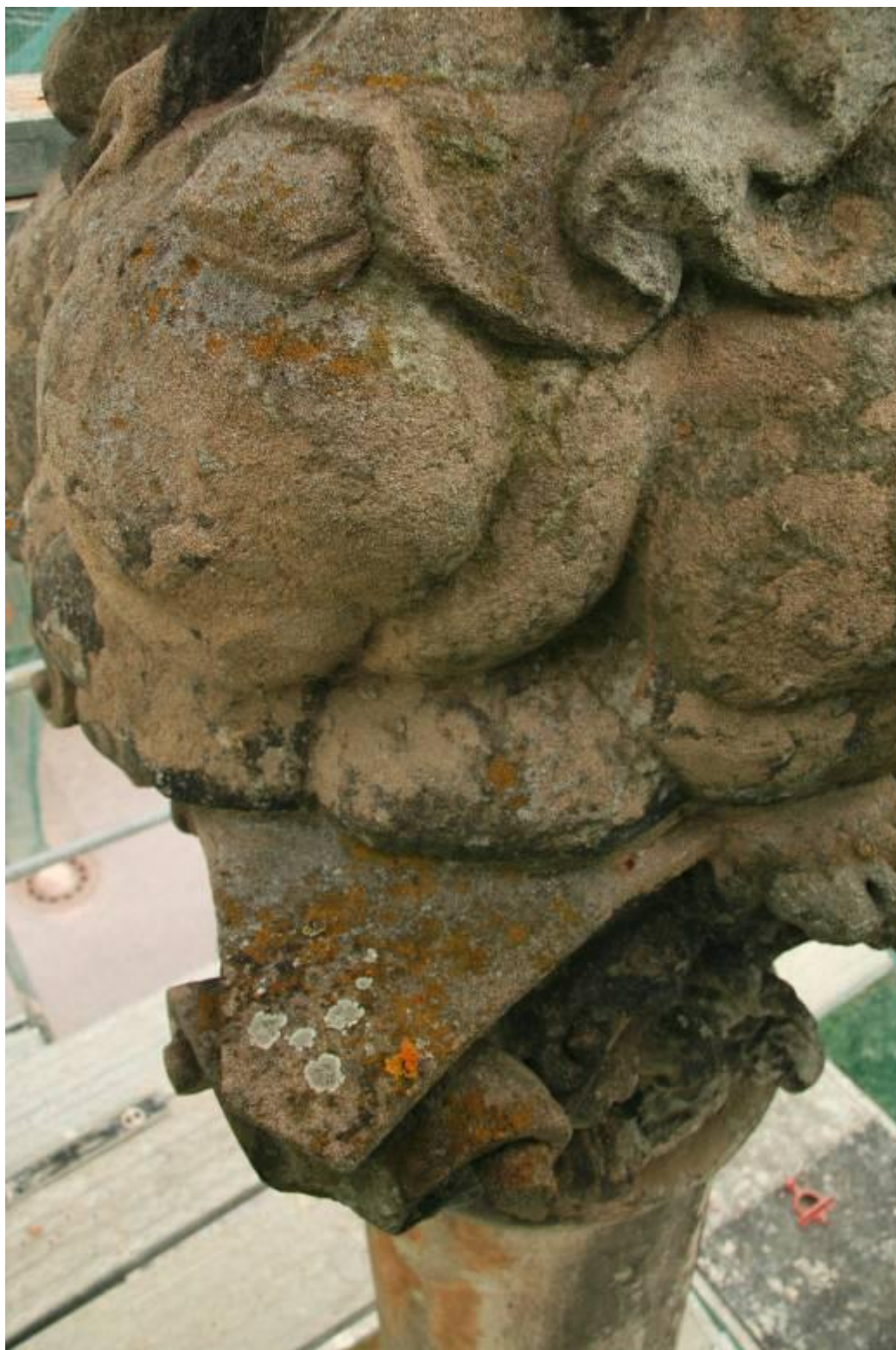
Fotografie č. 16 Detail biologického napadení, krust, starých epoxidových tmelů na oblaku, hlavici a dříku sloupu.
