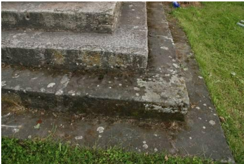
Fotografie č. 56 Biologické depozity na kamenném schodišti.
