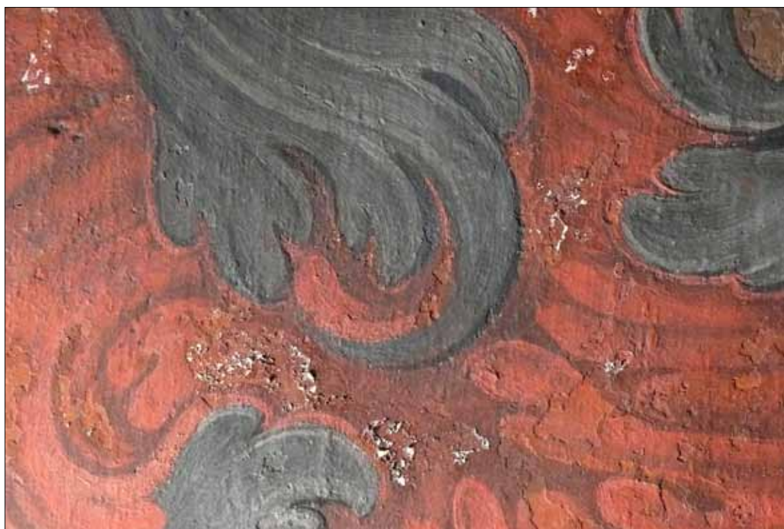
Obr. 83 – Boční světlo - Čech, J., Bělinová, H., Bláha, J., Krhánková, K., Pražský hrad – Starý královský palác, Restaurování nástěnných maleb v místnostech Úřadu desk zemských, Restaurátorská zpráva a dokumentace, 2009
