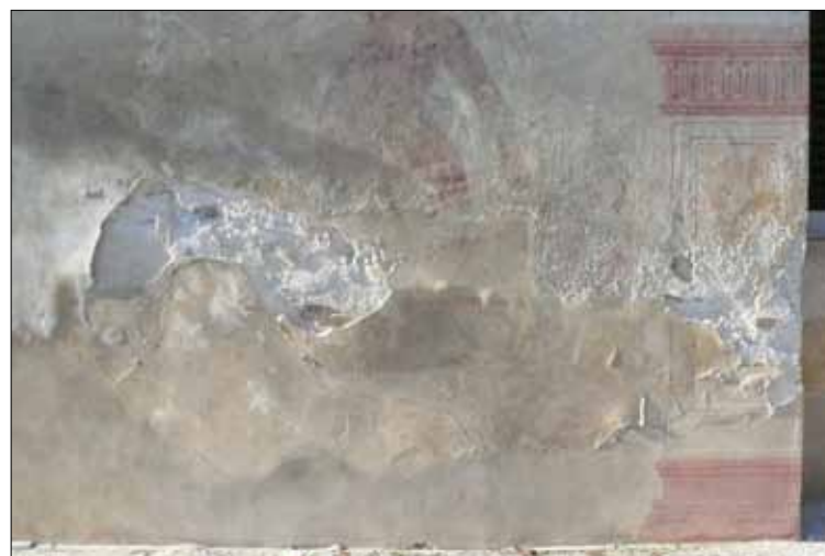
Obr. 81 – Poškození zachycené v bočním nasvícení - Bayer, K., Bláha, J., Krhánková, K., Wichterlová, Z., Průzkum vlhkosti a solí východní strany západní obvodové zdi, včetně objektu zvaného Markéta, Státní zámek Kratochvíle, 2008/9
