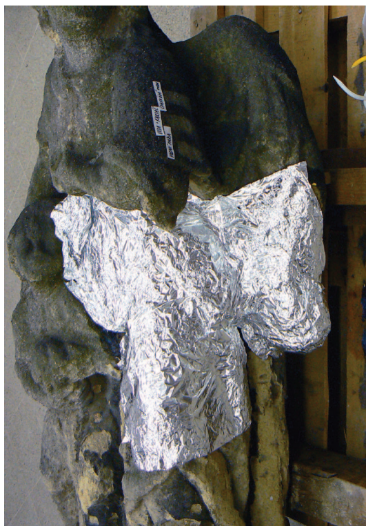
Detail - socha anděla s dítětem v průběhu prací - konsolidace, první fáze; zakrytí napuštěné plochy aluminiovou folií
