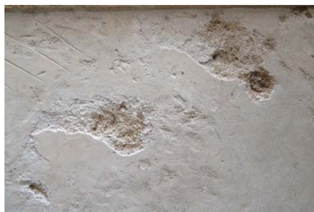
Obr. 36 - Sonda pod sádrový pačok - poškozený původní štuk až na jádrovou omítku.
