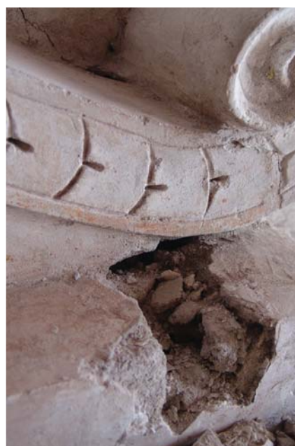
Obr. 32 - Trhlina statického původu, po odstranění tmelu.
