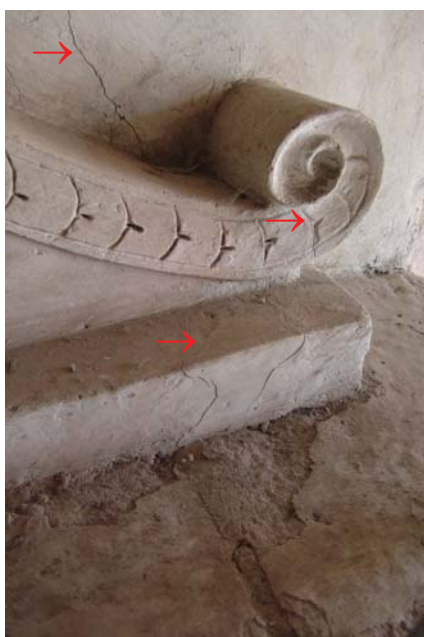
Obr. 31 - Trhliny statického původu, již v minulosti vytmelené.
