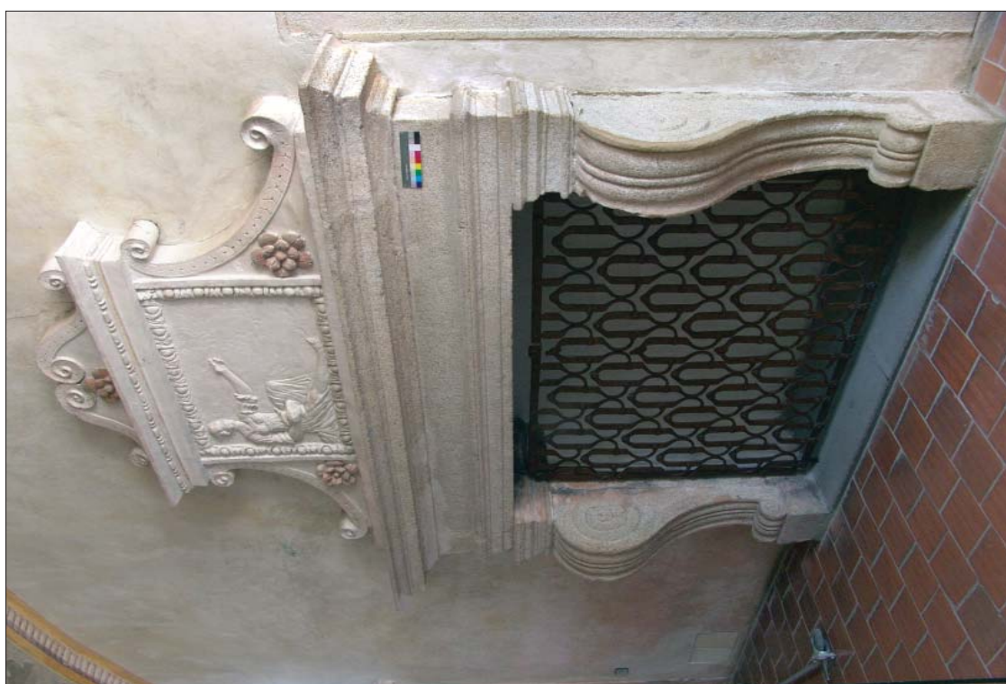
OBR. 60. BOČNÍ POHLED NA KRB PŘED RESTAUROVÁNÍM
