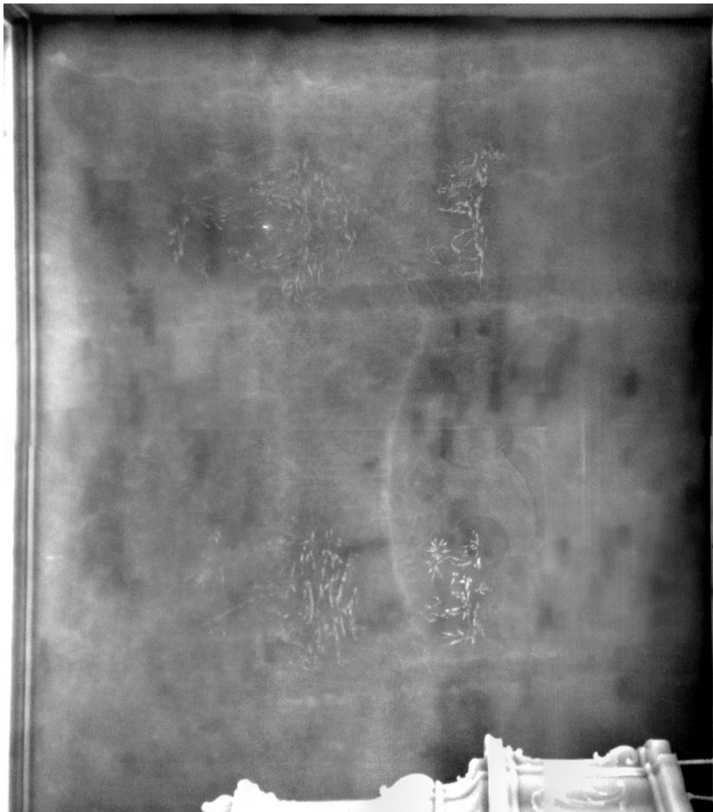
Obr. 16. Termogram z východní stěny. Na obrázku je patrný segmentový oblouk, který je zobrazen světleji, což znamená, že se v té oblasti nachází dutina. Dále je viditelný rozdíl ve složení zdiva.
