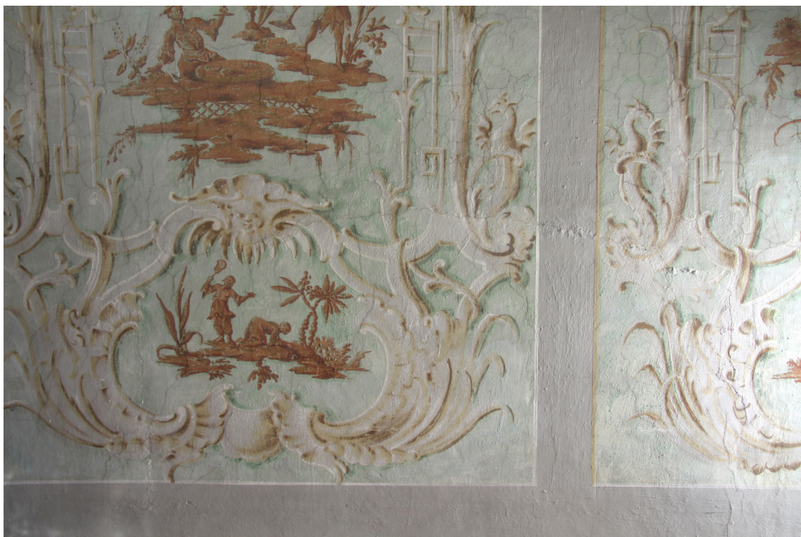
Obr. 10. Razantní (boční) nasvícení východní stěny, stav před restaurováním. Zviditelnila se prasklina ve středu východní stěny ve tvaru výklenku se segmentovou klenbou. Předpokládané rozměry výklenku jsou cca 160 cm na výšku a 150 cm na šíři.
