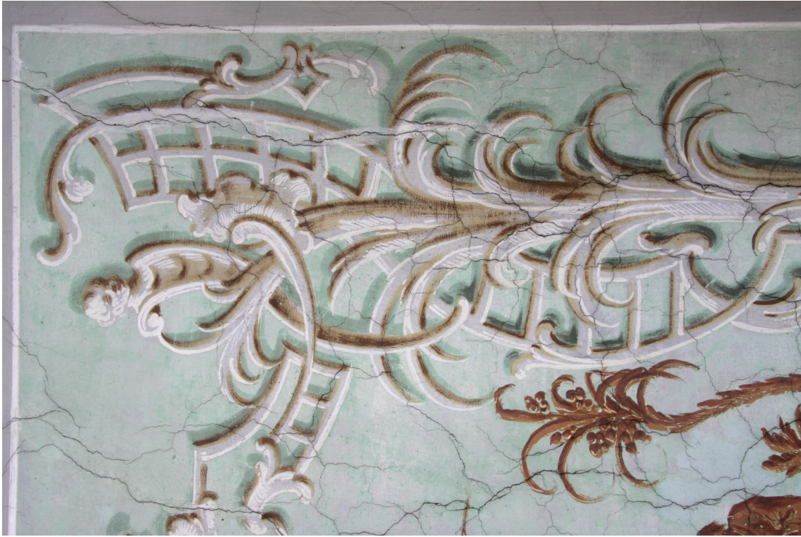
Obr. 9. Stav před restaurováním. Jižní horní roh malby, kde praskliny vytváří hustou síť. V celé délce prasklin jsou deponovány prachu a sazi.
