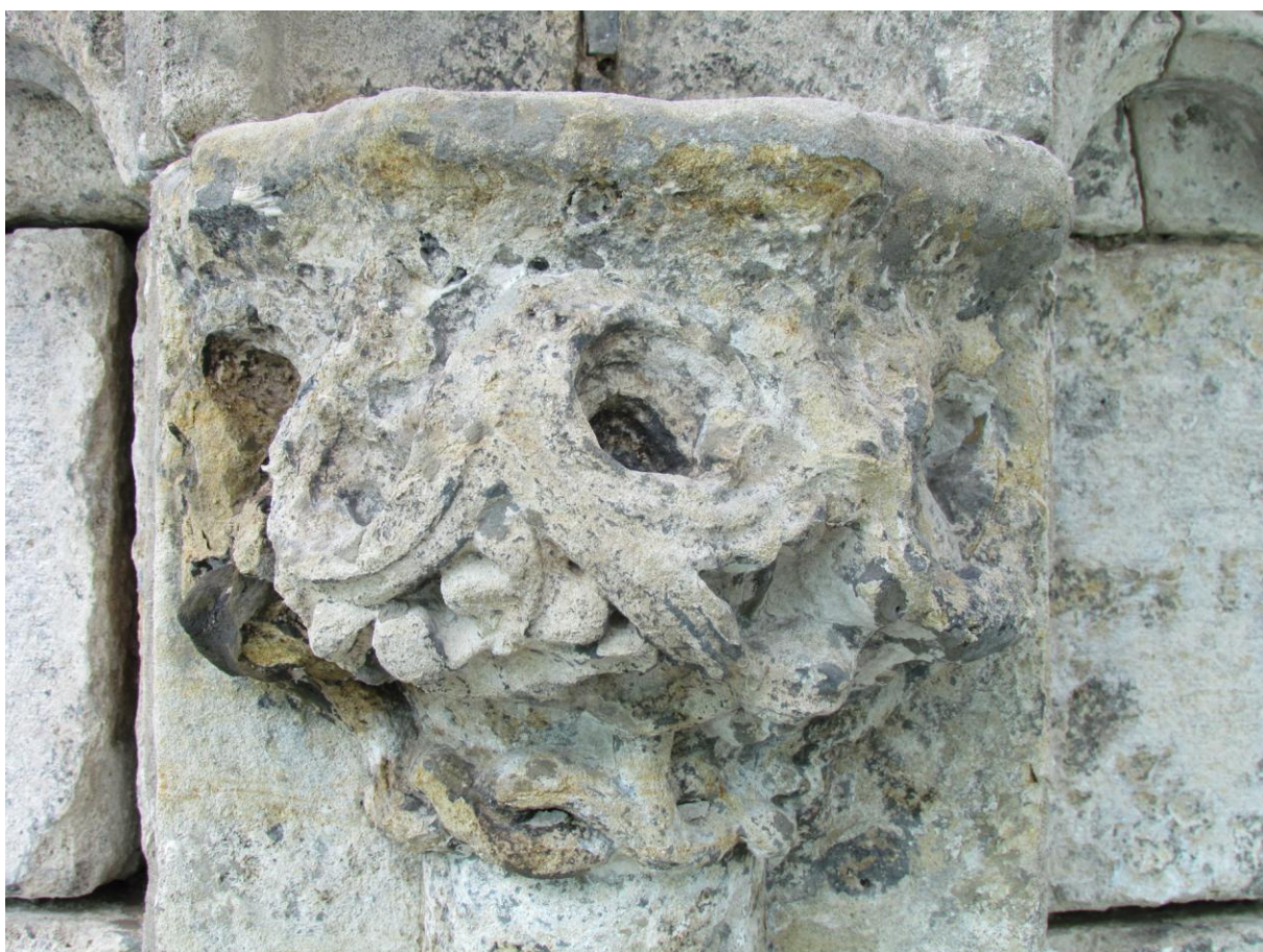
Snímek 27 – konzole detail, stav po ukončení odsolování
