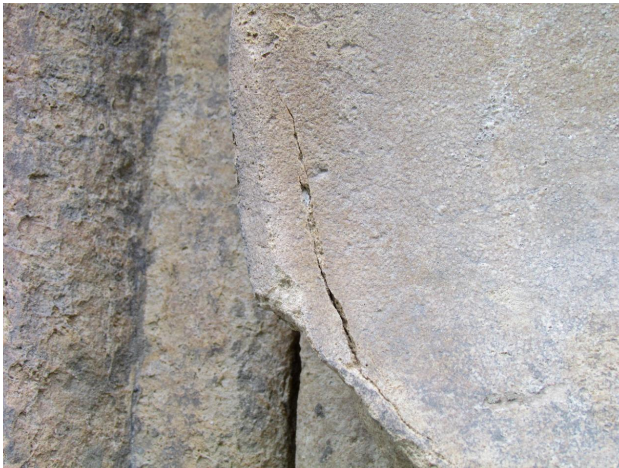
Snímek 41 - erb detail, prasklina
