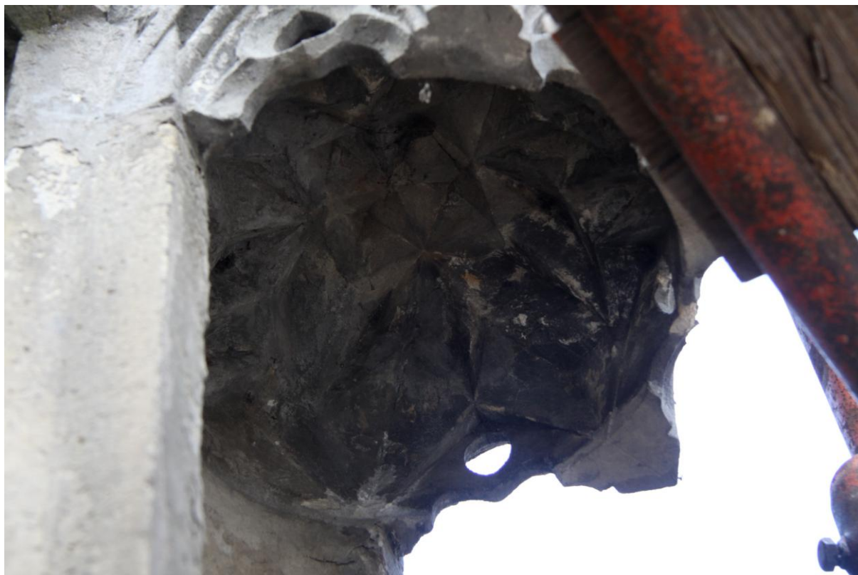
Snímek 7 – baldachýn detail, stav před restaurováním
