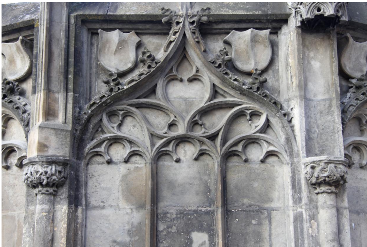
Snímek 3 – stav před restaurováním
