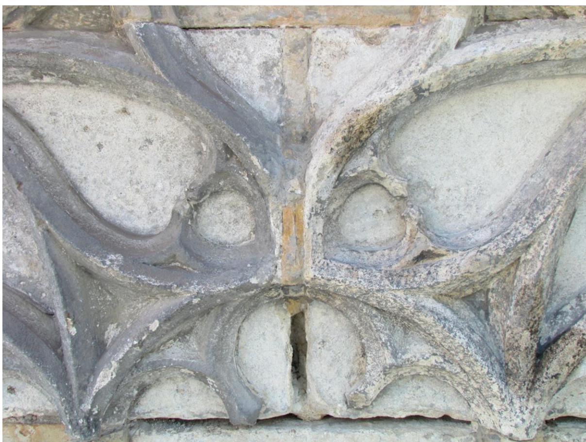
Snímek 31 – kružby detail, srovnání čištěného a nečištěného povrchu kružeb
