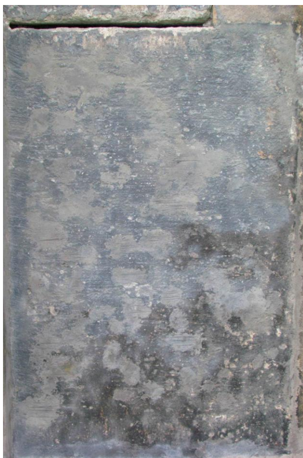
Snímek 18 - vápenec detail, povrchové krusty a disperzní přetěry
