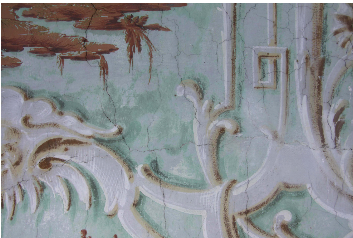
Obr. 8: Stav před restaurováním. Detail poškození, horizontální prasklina.
