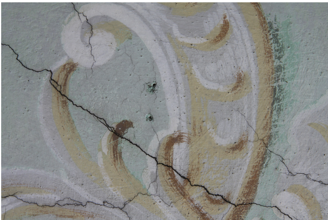
Obr. 12: Stav před restaurováním. Detail poškození, drobná mechanická poškození.
