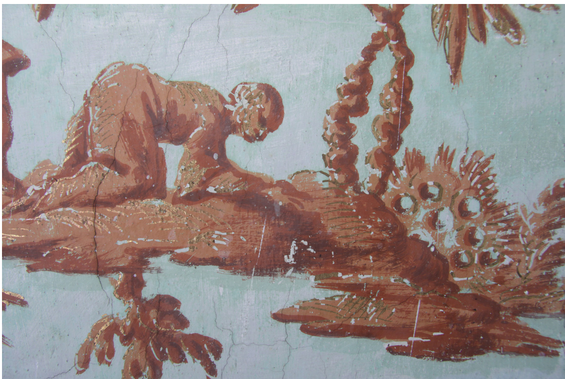
Obr. 7: Stav před restaurováním. Detail poškození, odpadaná metalové folie. Dolní figurální výjev.
