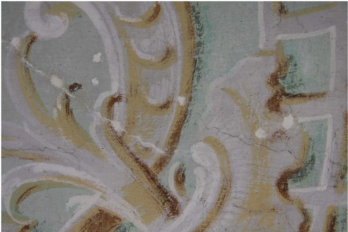
Obr. 36: Stav po injektáži a vytmelení. Detail vytmelení prasklin a defektů v barevné vrstvě. Pravý horní roh zrcadla.
