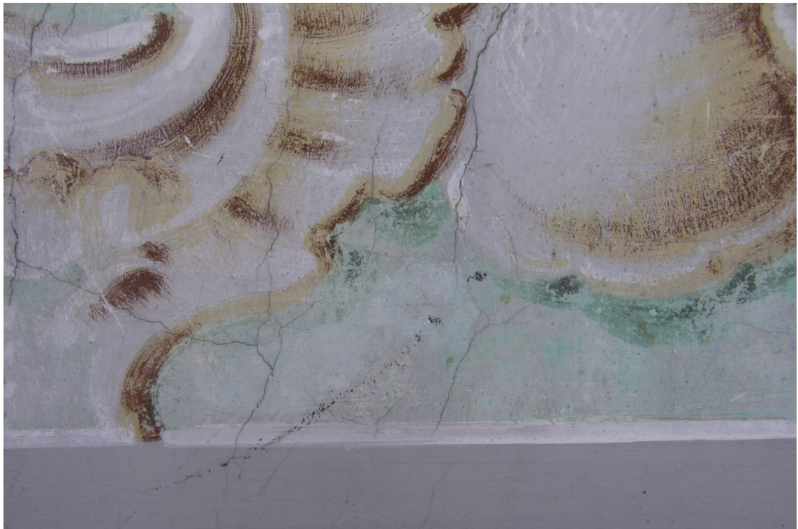
Obr. 11: Stav před restaurováním. Detail poškození, modrozelená přemalba a spráškovatělá barevná vrstva.
