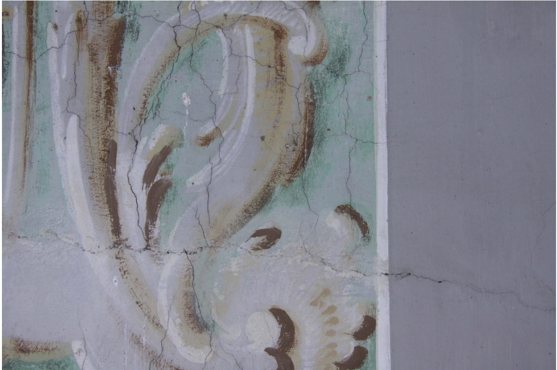
Obr. 10: Stav před restaurováním. Detail poškození, horizontální trhlina a hnědé přemalby.
