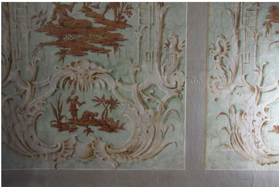
Obr. 14: Průzkum v ostrém bočním nasvícení. Dolní část zadaného úseku. Nepatrně znatelný vpadlý okraj segmentového oblouku.
